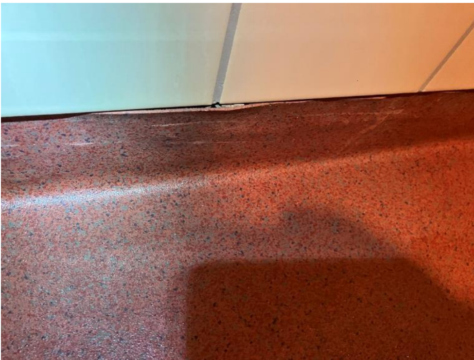
Kuva 4.29. Tilan 126 lattia muovimatossa on vuotokohtia.
