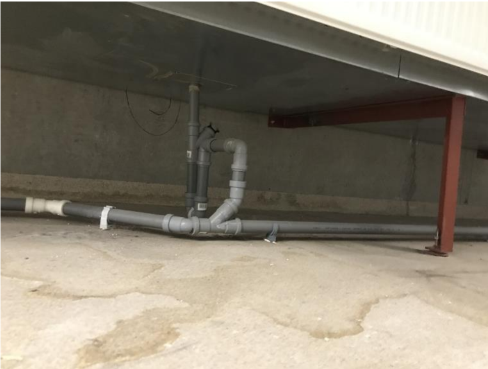
Kuva 5.3. Ilmanvaihtokoneiden viemäröinnissä on puutteita ja vesi pääsee lattialle.
