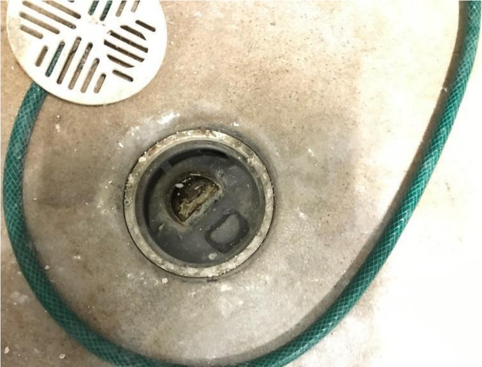
Kuva 5.2. Ilmanvaihtokonehuoneen lattiakaivo on tyhjä.
