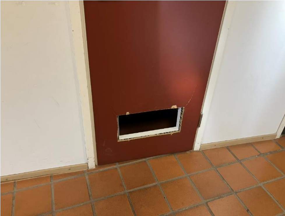
Kuva 5.6. Usean WC tilan korvausilmasäleiköt puuttuvat.
