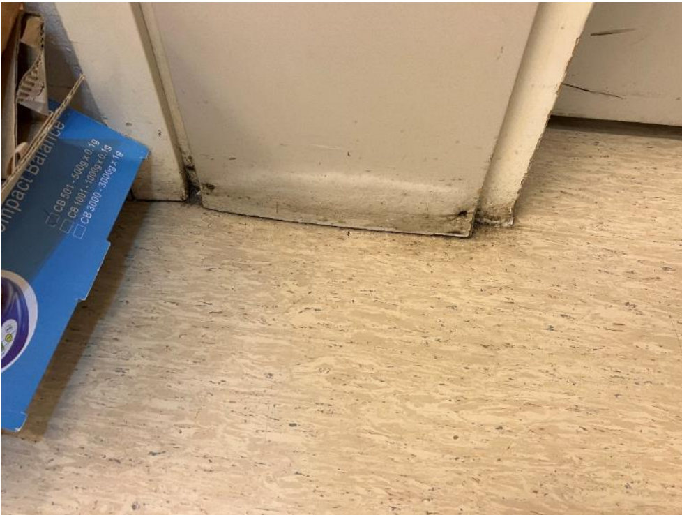
Kuva 4.17. Tilassa 288 seinälevyn alaosissa on vanhoja kastumisjälkiä.
