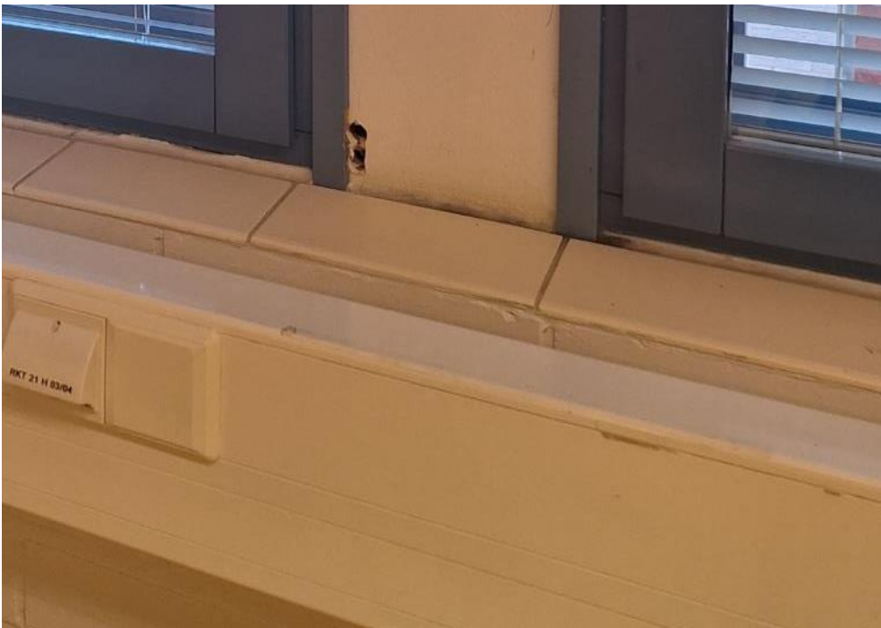
Kuva 4.33. Tilassa 237 on tiivistämätön ulkoseinän sisäpintaan porattu reikä.
