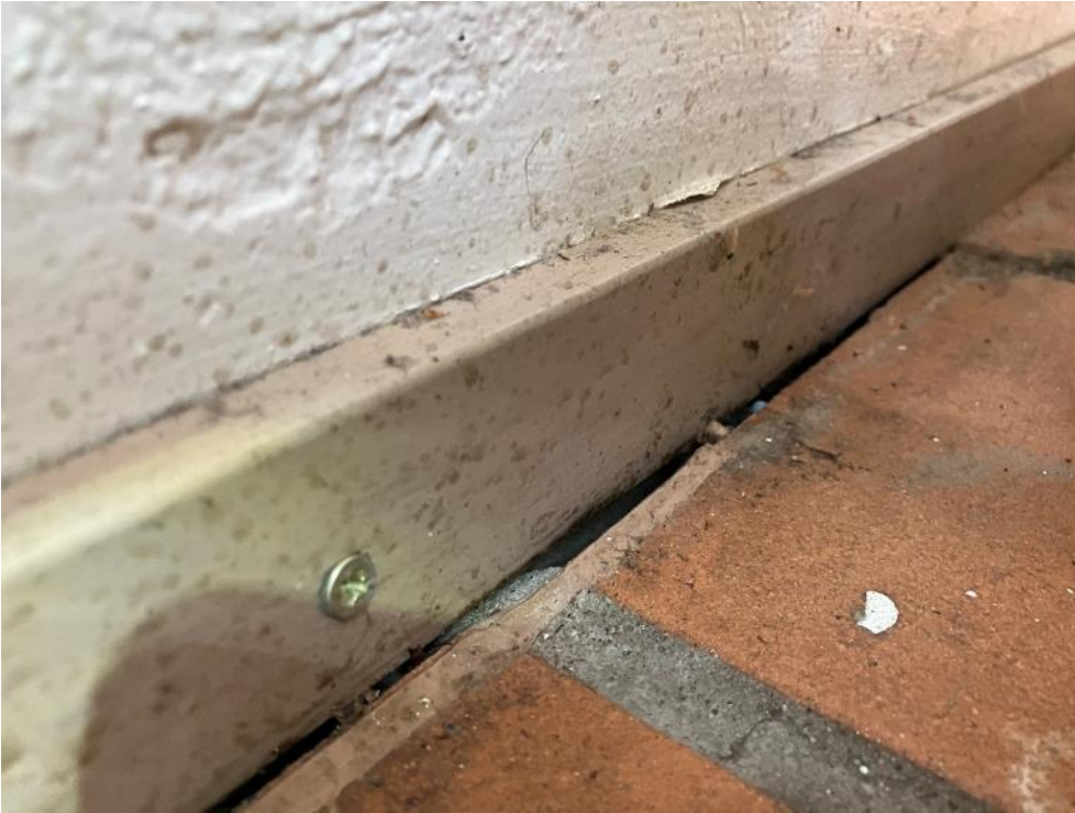
Kuva 4.34. Ruokailutilassa 161 lattian ja ulkoseinän välinen liitos on epätiivis.
