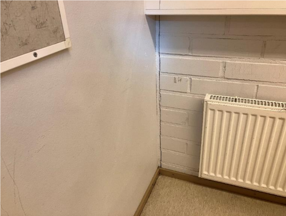
Kuva 4.4. Tilan 327 ulkoseinäsaumassa on halkeama, joka muodostaa todennäköisen ilmayhteyden seinän eristekerrokseen.
