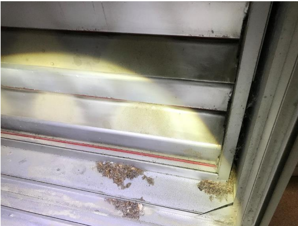
Kuva 6.3. TK03 tuloilmapelti ei sulkeudu tiiviisti.
