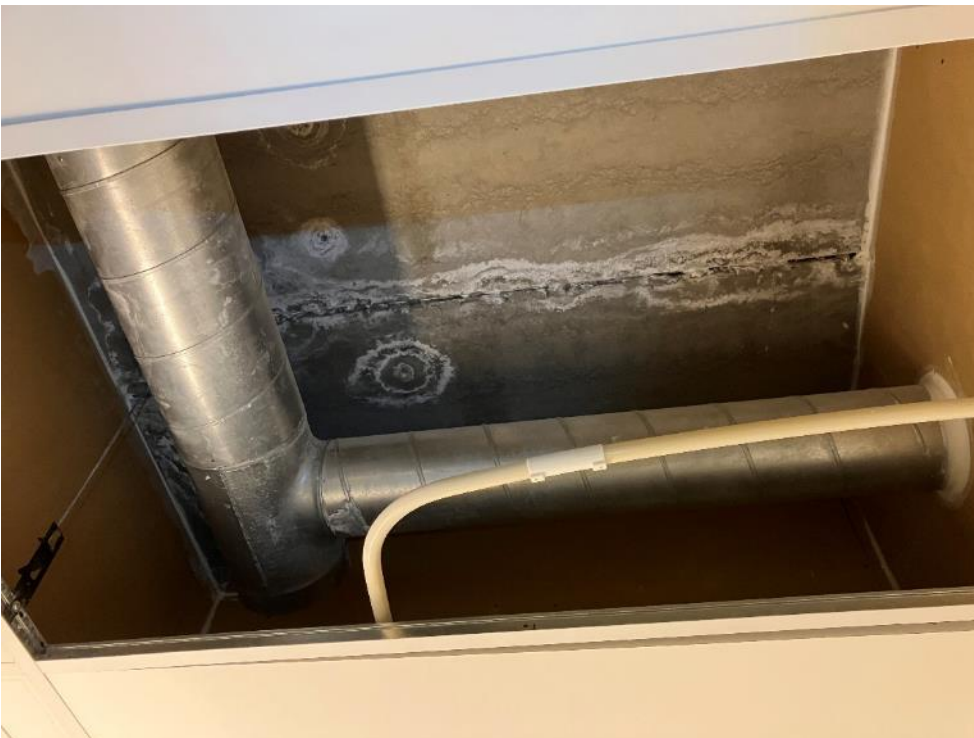
Kuva 4.21. Tilan 219 katon ontelolaattasaumoissa on vuotojälkiä, joka viittaa yläpohjarakenteen aiempaan kastumiseen.
