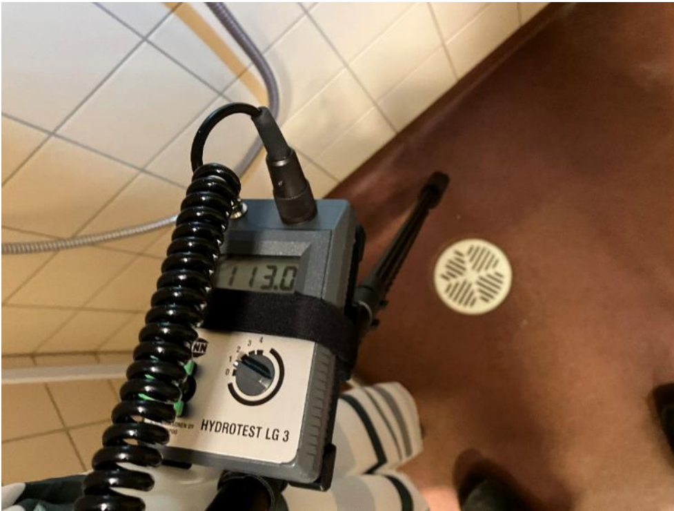
Kuva 4.26. Tilan 124 mittauksissa havaittiin nousseita pintakosteusarvoja.
