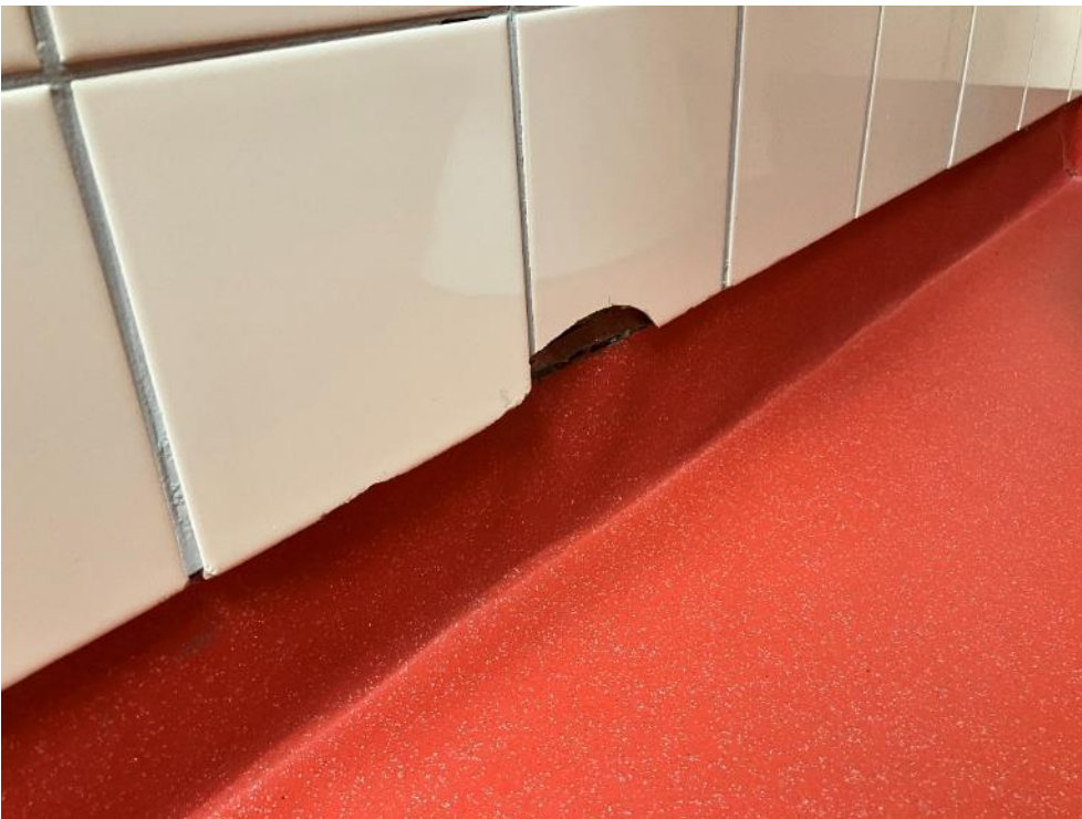
Kuva 4.19. Tilassa 223 on vioittuneita seinälaattoja ja alustastaan irti oleva muovimatto.
