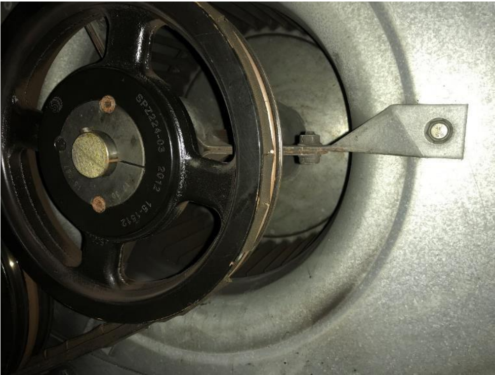
Kuva 5.1. Ilmanvaihtokoneen PK5 hihnat ovat lähes poikki.
