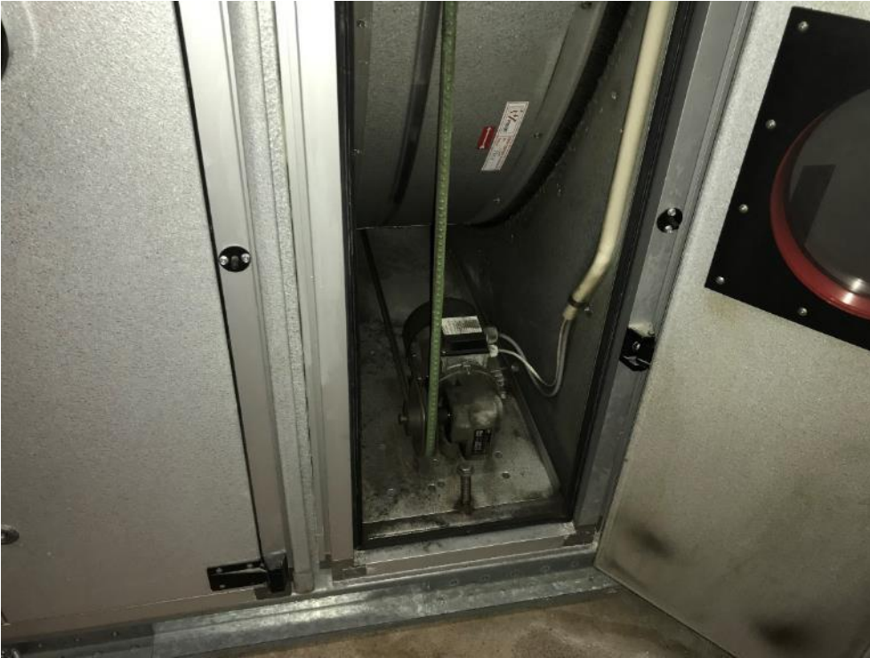
Kuva 5.4. Ilmanvaihtokoneiden lämmöntalteenottojen TK3 ja TK5 hihnat ovat löysällä.
