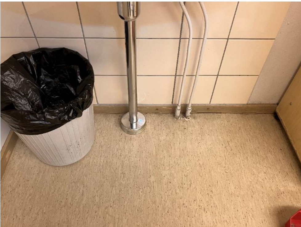
Kuva 4.3. Tilassa 321 muovimatto on irti alustastaan lavuaarin edustalla.
