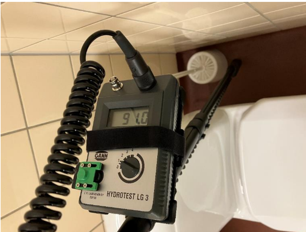
Kuva 4.25. Tilan 172 mittauksissa havaittiin nousseita pintakosteusarvoja.
