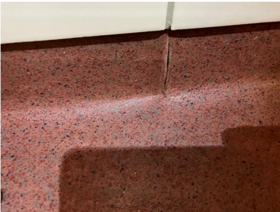
Kuva 4.27. Tilan 124 lattian muovimatossa on vuotokohtia.
