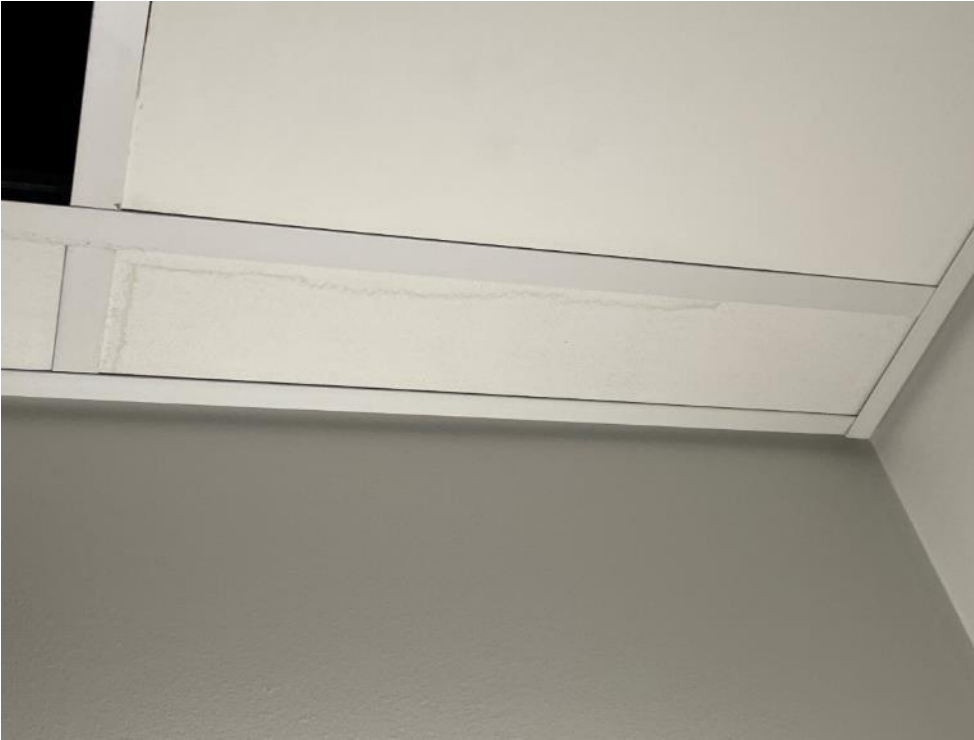
Kuva 4.20. Tilan 207 alakattolevyissä on vanhoja kosteusjälkiä.
