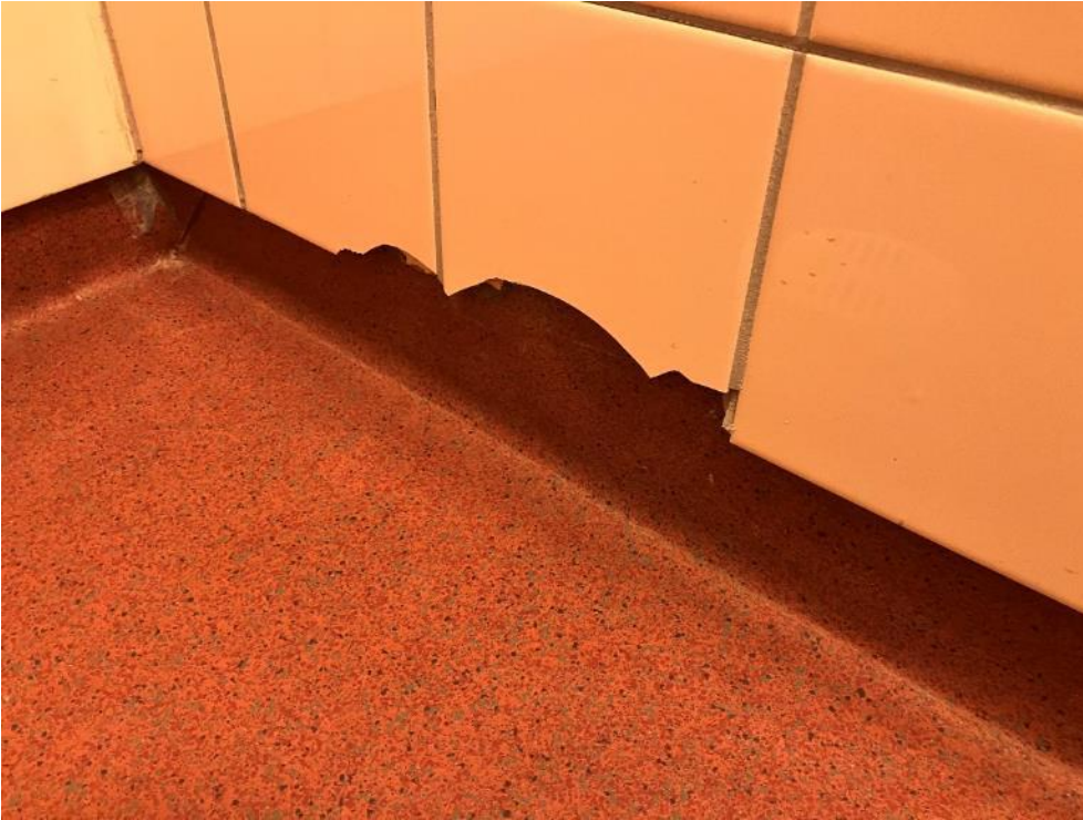
Kuva 4.14. Tilan 262 seinälaattoja on rikkoutunut.
