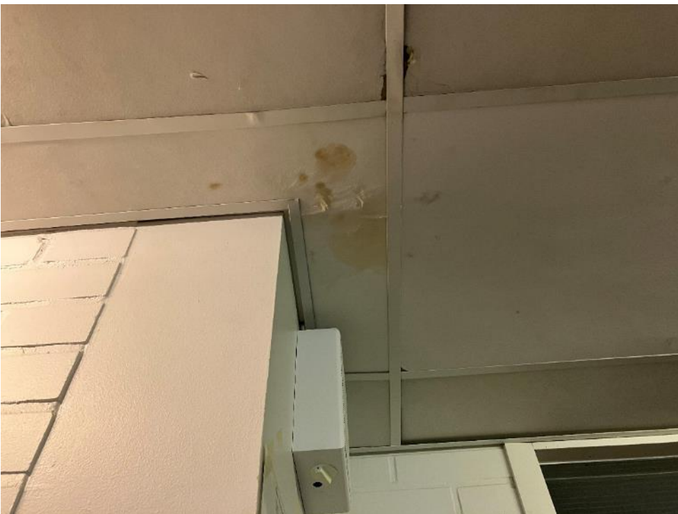
Kuva 4.11. Tilan 247 aulan alakatossa on vanhoja kastumisjälkiä.
