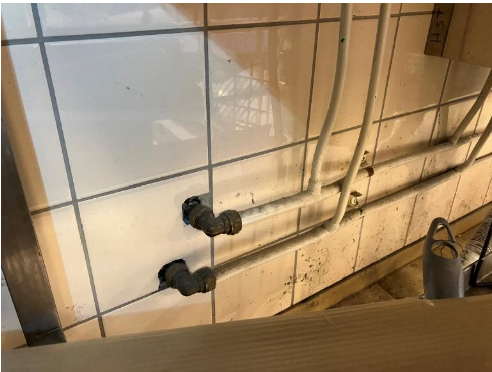
Kuva 4.31. Tilan 271 vesilinjatukien seinäliitokset ovat tiivistämättä.
