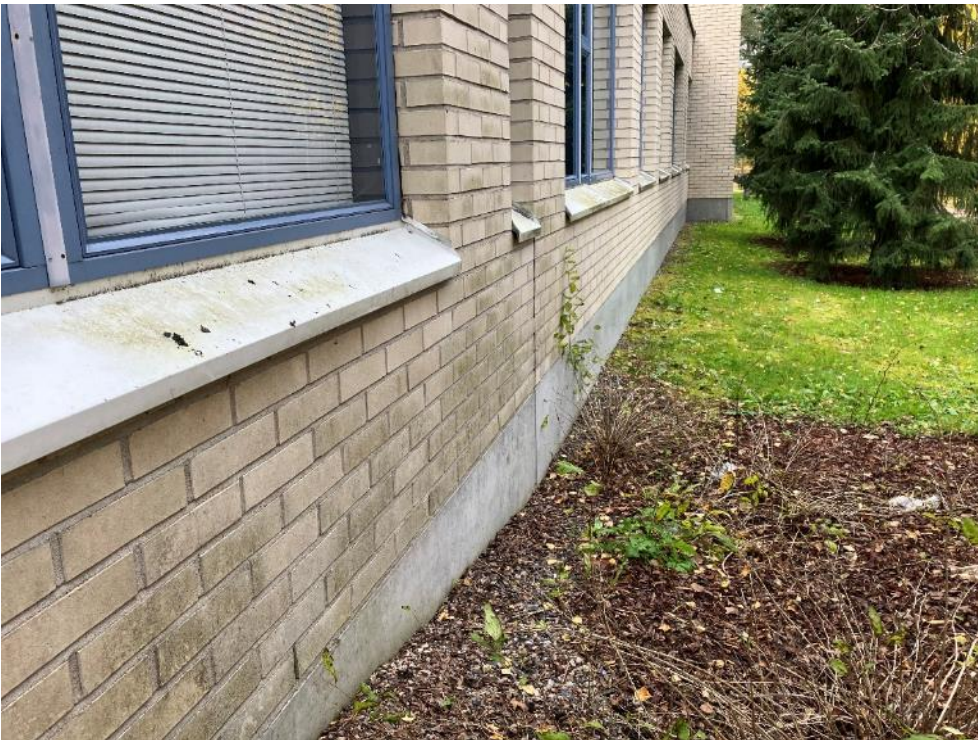
Kuva 4.39. Rakennuksen pohjoispuolella tiiliseinän alaosa on tummunut.
