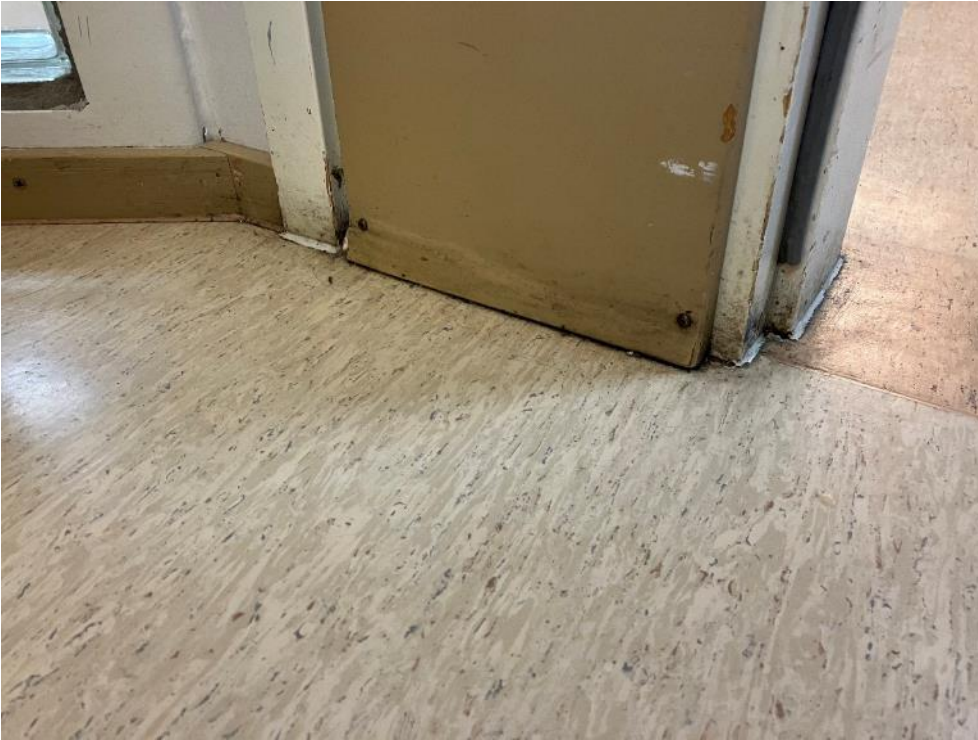
Kuva 4.2. Tilassa 322 seinälevyn alapinnassa on vanhoja kastumisjälkiä.
