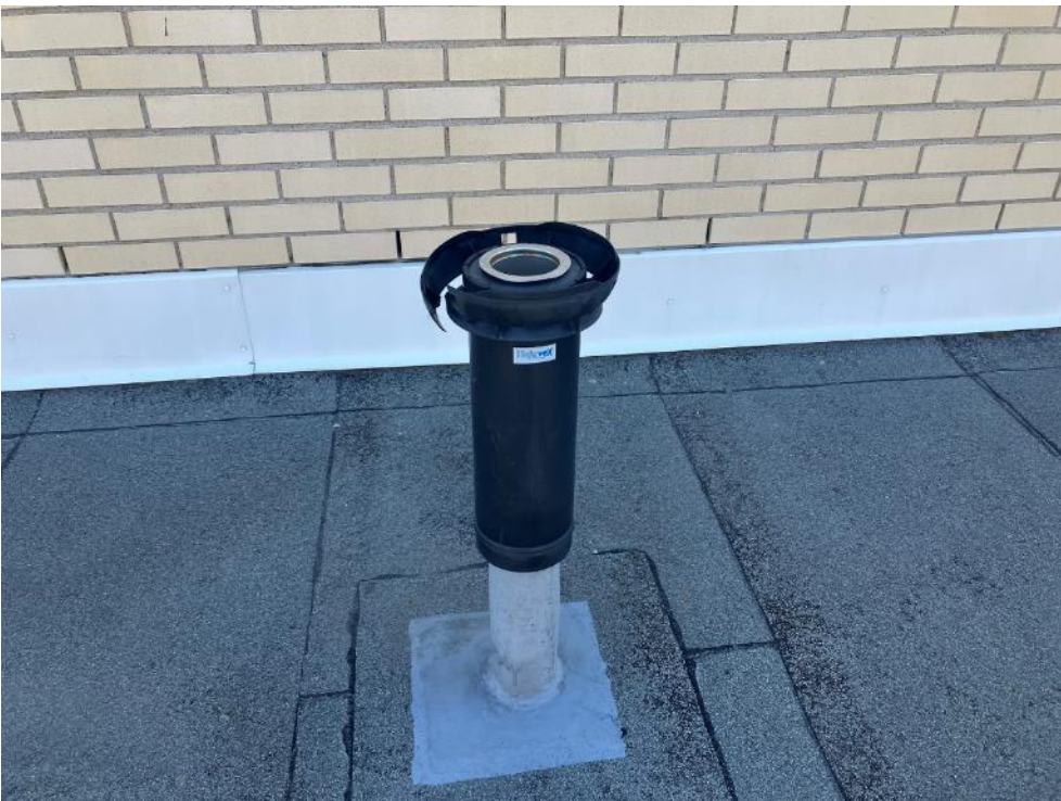
Kuva 5.5. Vesikatolla sijaitsevien tuuletusputkien hattu on rikki.
