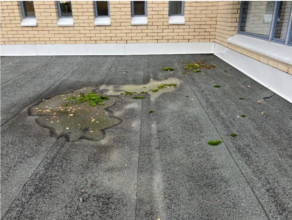
Kuva 4.35. Vesikatolla on lammikoitumista ja puhdistustarvetta.
