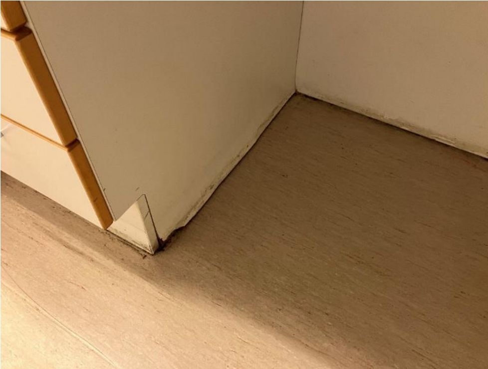
Kuva 4.18. Tilan 234 kalusteiden alaosissa on vanhoja kosteusvaurioita.
