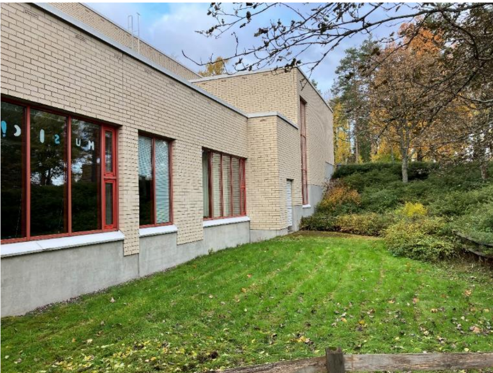
Kuva 4.37. Tiilijulkisivun yläosan reikätiilet mahdollistavat veden pääsyn ulkoseinän tiilivilla-tiilirakenteen villakerrokseen.
