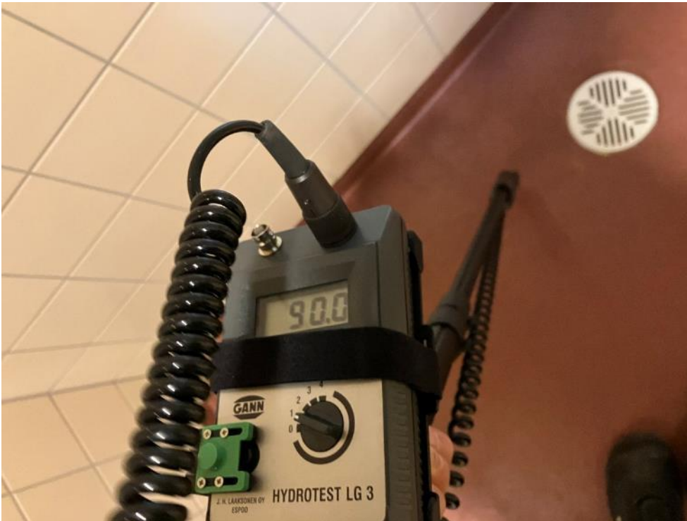
Kuva 4.28. Tilan 126 mittauksissa havaittiin nousseita pintakosteusarvoja.
