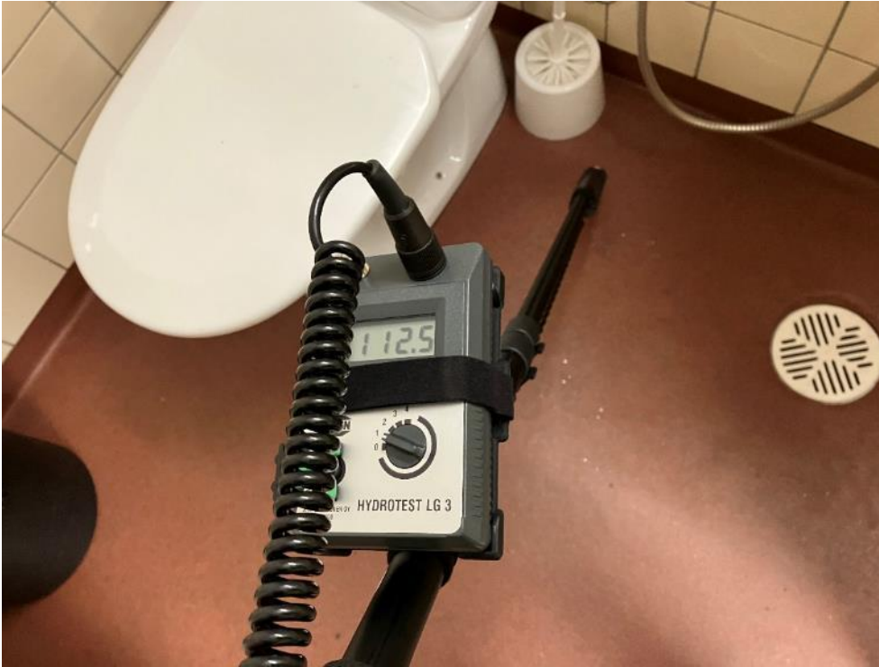
Kuva 4.24. Tilan 171 mittauksissa havaittiin nousseita pintakosteusarvoja.
