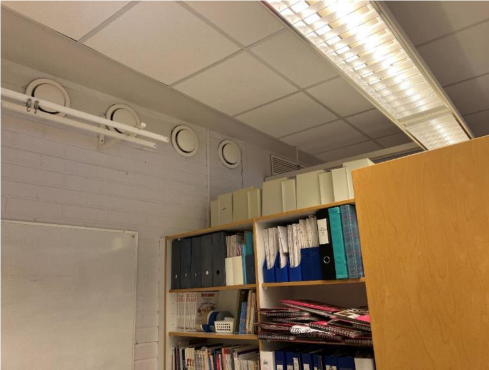
Kuva 4.32. Tilassa 288 on halkeama väliseinässä.
