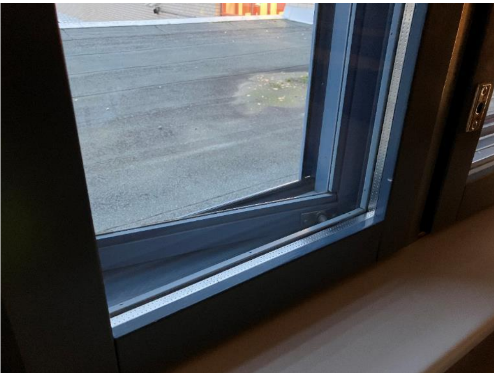
Kuva 4.5. Tilassa 303 tuuletusikkunan ulompi lasi ei sulkeudu puuttuvan kytkentätapin vuoksi.
