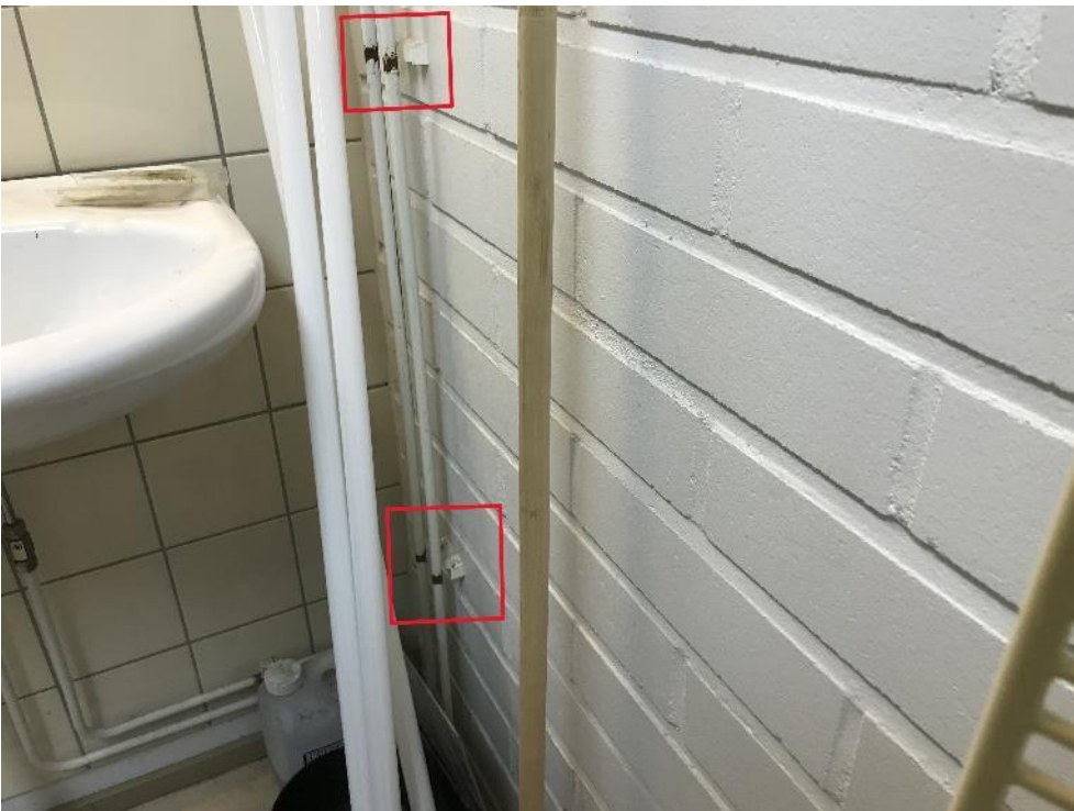
Kuva 5.7. Kiinteistöhoitohuoneen 177 pesualtaan putkistoista puuttuvat kannakkeet.
