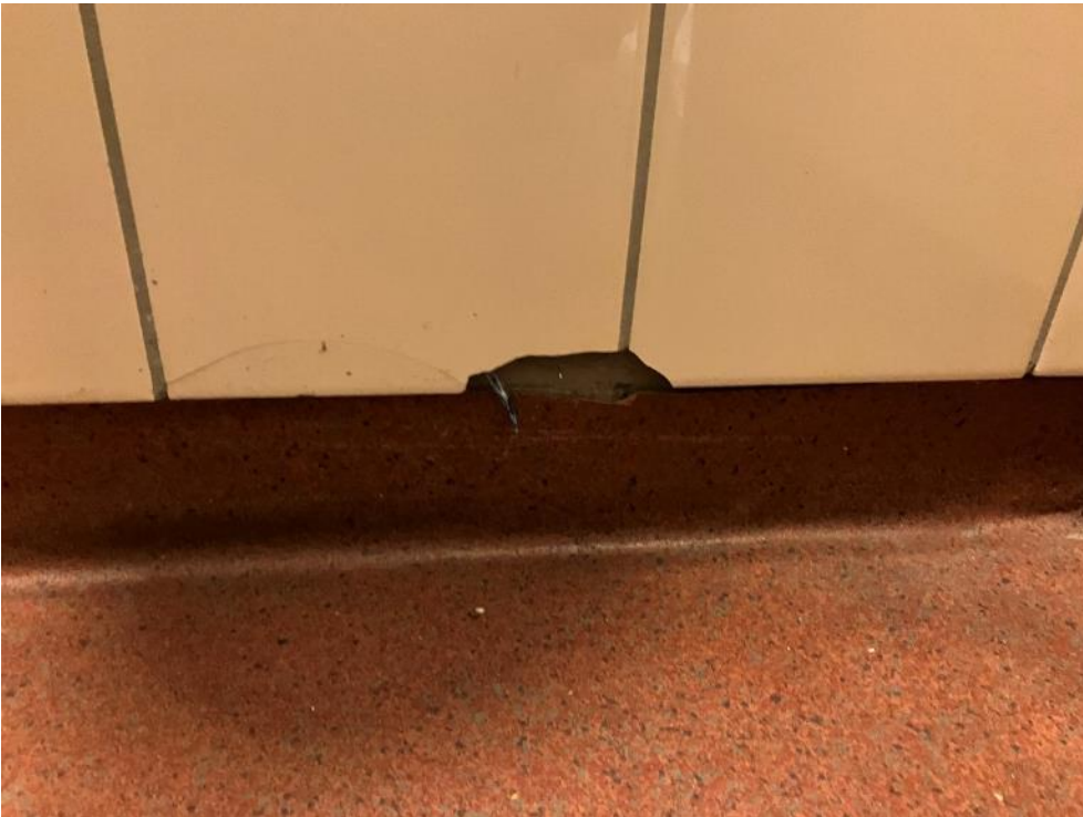
Kuva 4.13. Tilan 246 seinälaattoja on rikkoutunut siten, että lattian muovimatton ylösnosto ei ole tiivis.
