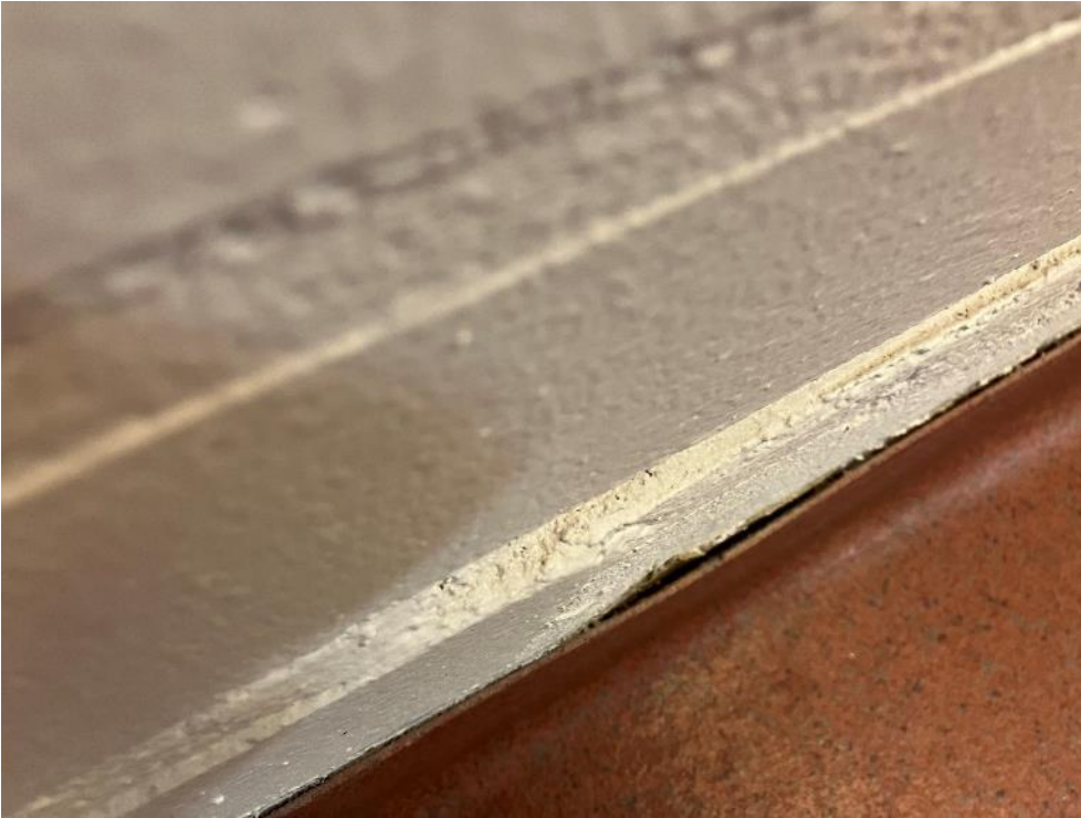
Kuva 4.30. Tilassa 137 lattian muovimaton ylösnosto on irti alustasta.
