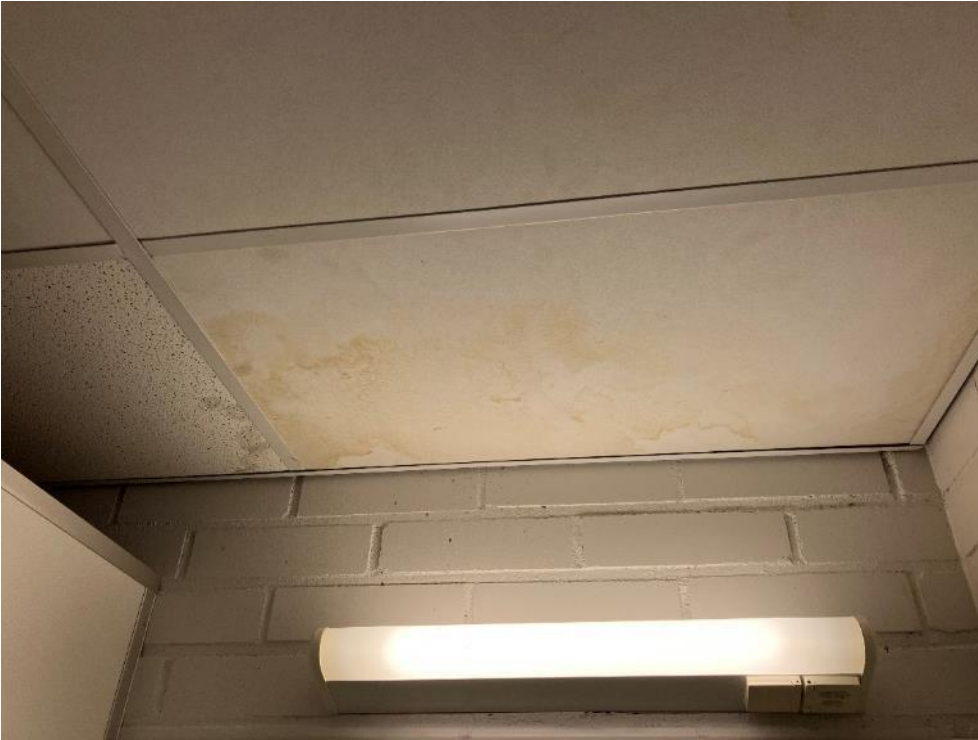
Kuva 4.22. Tilan 136 ovinumero on 138N ja alakattolevyssä on vuotojälkiä.
