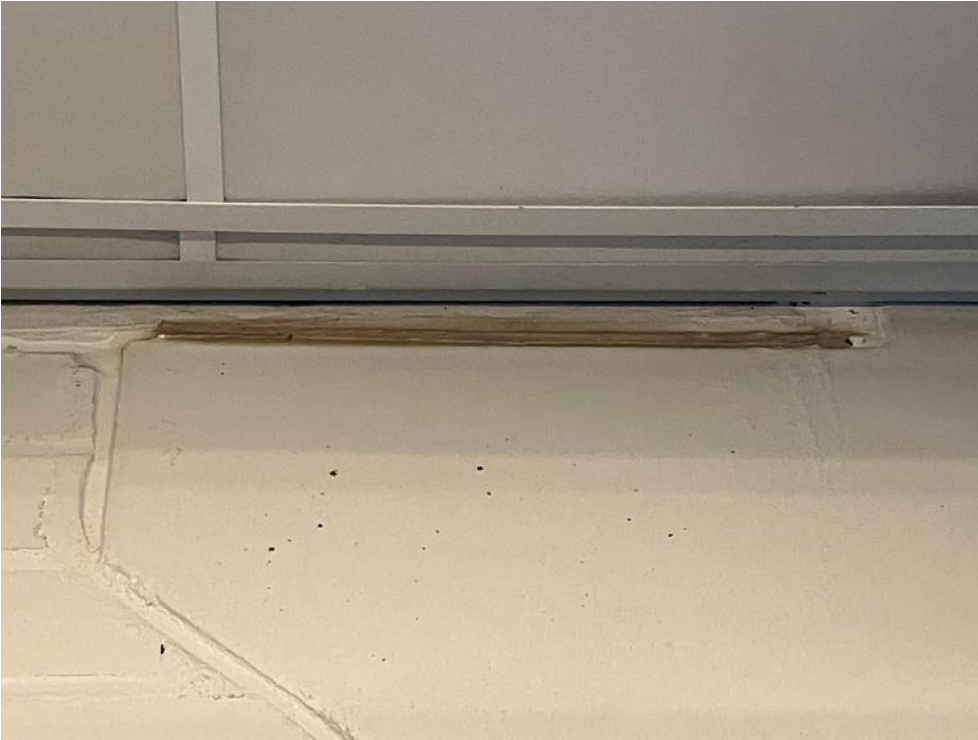
Kuva 4.12. Tilassa 254 pilarin yläpinta on märkä.
