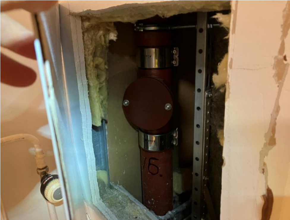
Kuva 4.10. Tilan 311 ovenpielessä on heikosti suljettu hormin tarkastusluukku, joka ei ole ilmatiivis ja siksi mahdollistaa ilmavuodot hormista sisäilmaan.
