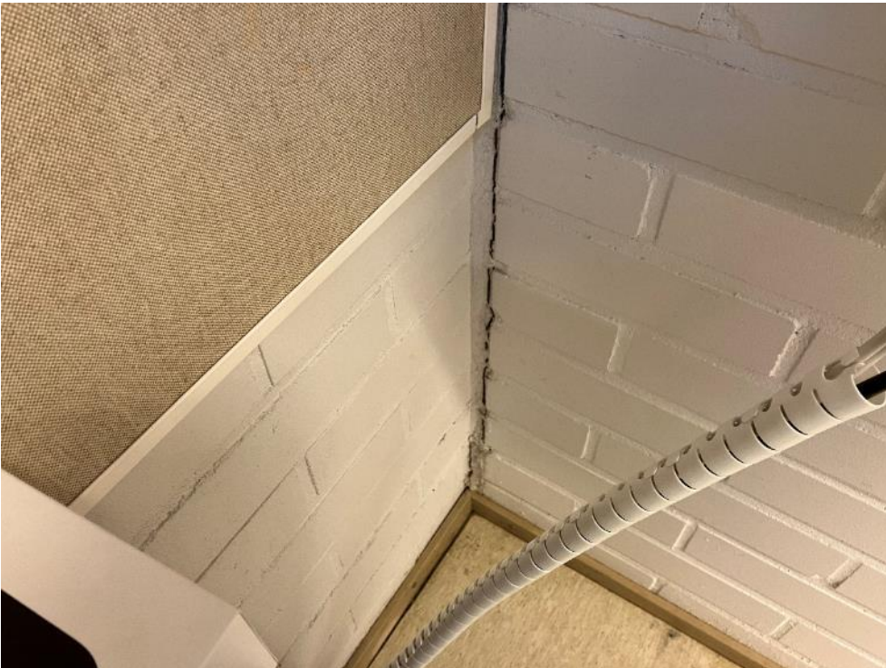
Kuva 4.15. Tilassa 271 on epätiivaitä saumojä (VS/US, US/lattia).
