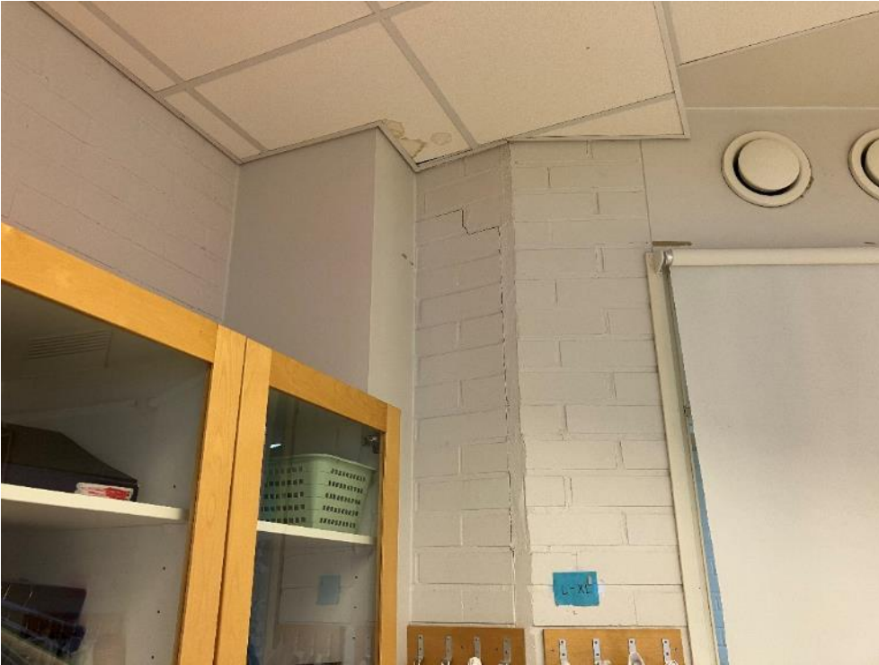
Kuva 4.16. Tilan 285 katossa on kastumisjälkiä ja seinässä halkeama.
