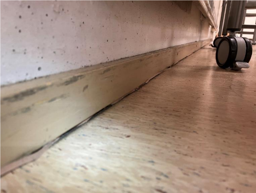
Kuva 4.6. Tilassa 303 lattian ja ulkoseinän välinen liitos on mahdollisesti epätiivis. Lattialistan ja muovimatton saumaan aiemmin lisätty massa on kulunut pois.
