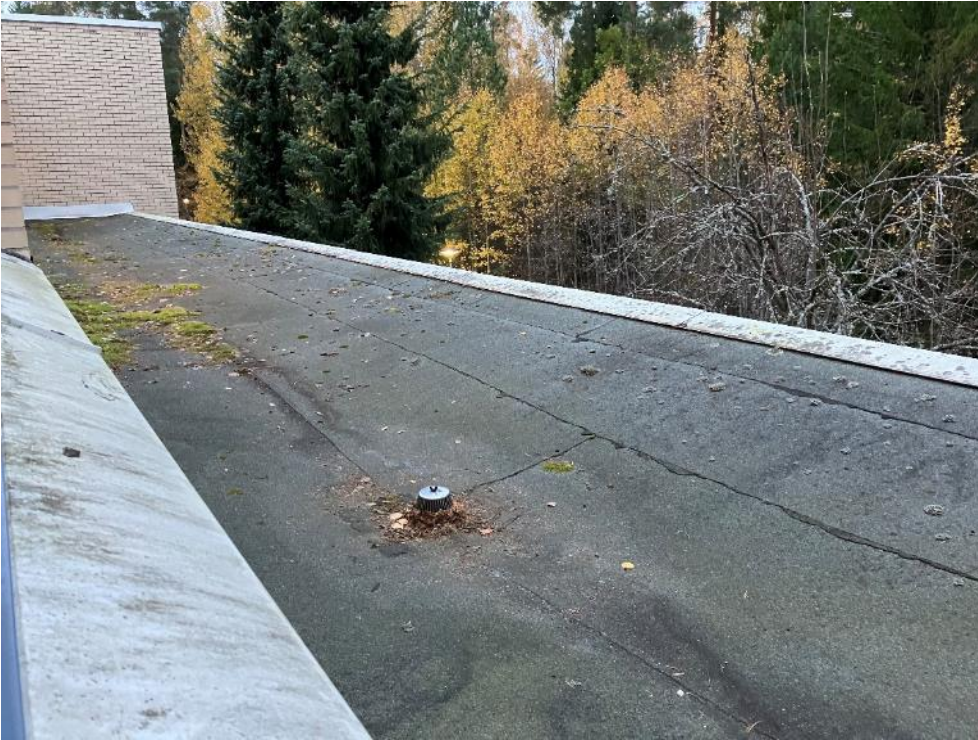
Kuva 4.36. Vesikatolla kattokaivot ovat puhdistamatta.
