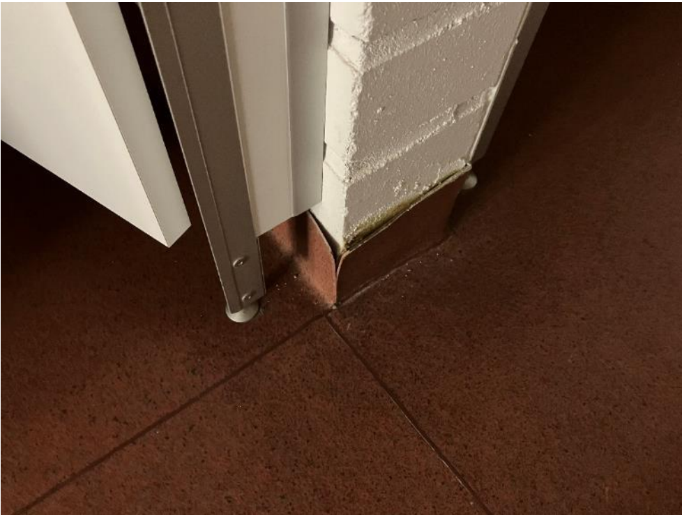
Kuva 4.23. Tilassa 138 lattian muovimaton ylösnosto on irti alustasta.
