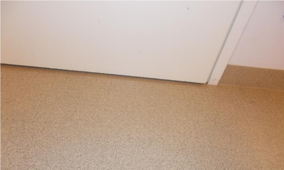
Kuva 5.3. Liikuntasalin pukuhuonetilojen WC 1060 ovesta puuttuu korvausilmäsäleikkö.
