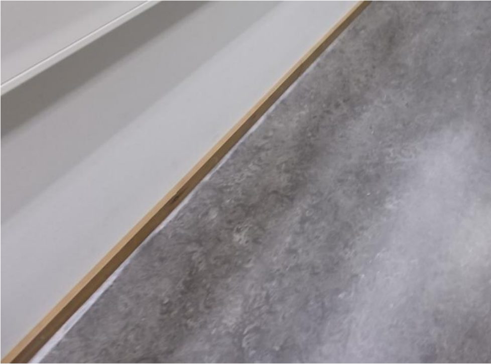
Kuva 4.7. Seinän ja lattiamaton liittymä ei ole tiivis luokassa 1105.
