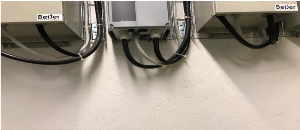
Kuva 6.1. Taajuusmuuttajien EMC-suojaus on puutteellinen.
