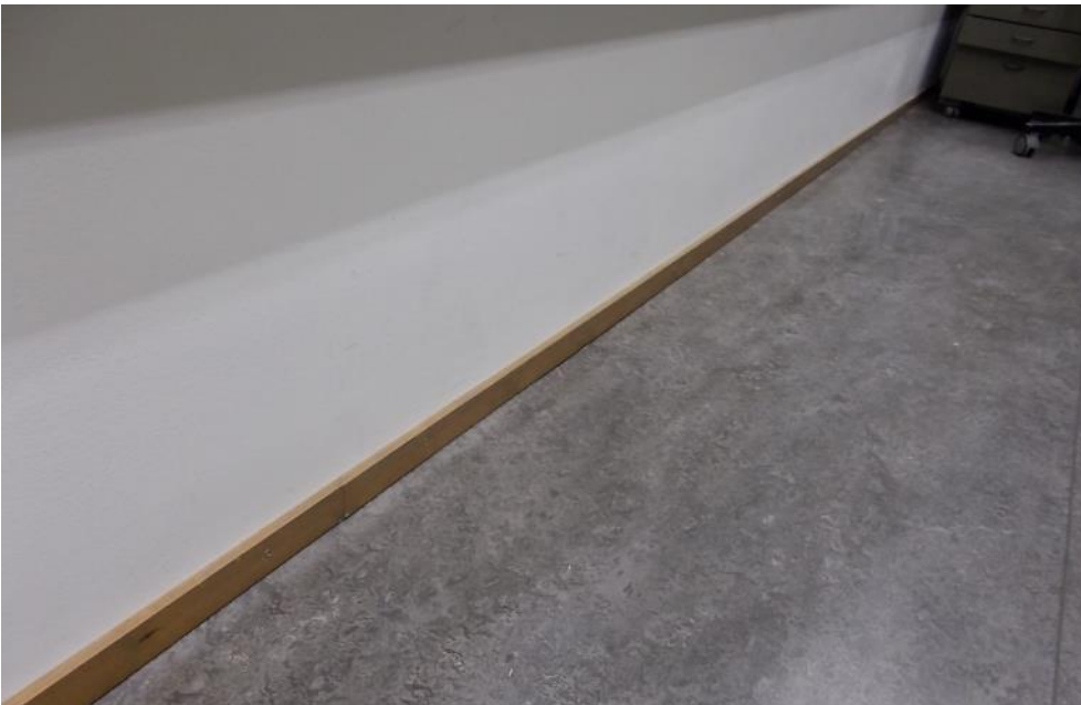
Kuva 4.6. Lattiamatto on osin irti luokassa 1105.
