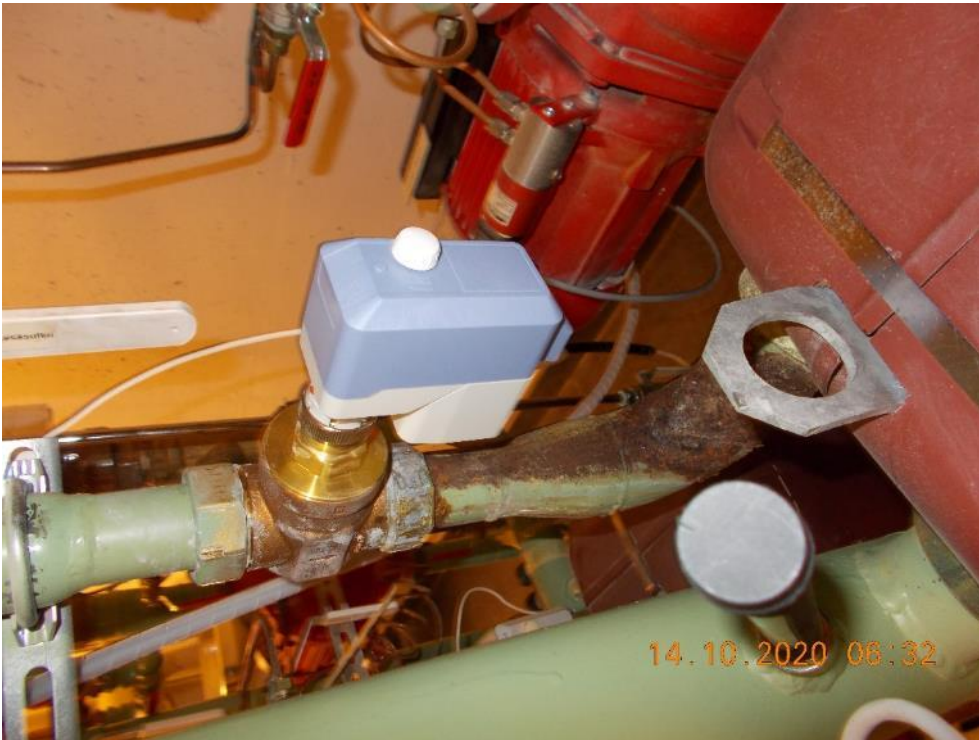
Kuva 5.5. Lämmönjakopaketissa on ruostuneita osia.
