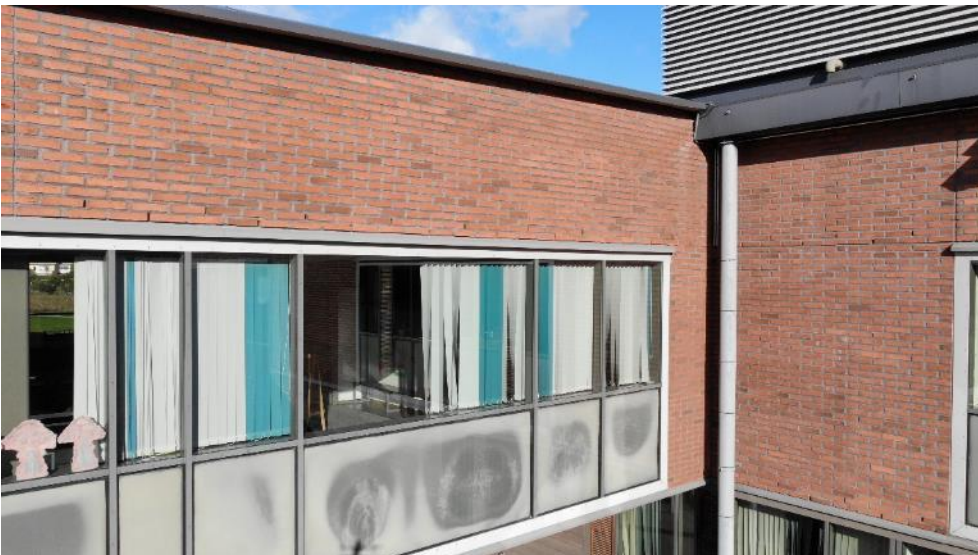
Kuva 4.2. Osana julkisivua olevia rikkoutuneita kovalevyjä.
