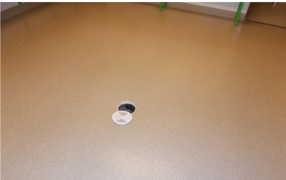
Kuva 5.2. Liikuntasalin pukuhuonetilojen lattiakaivoja on ilman vettä.
