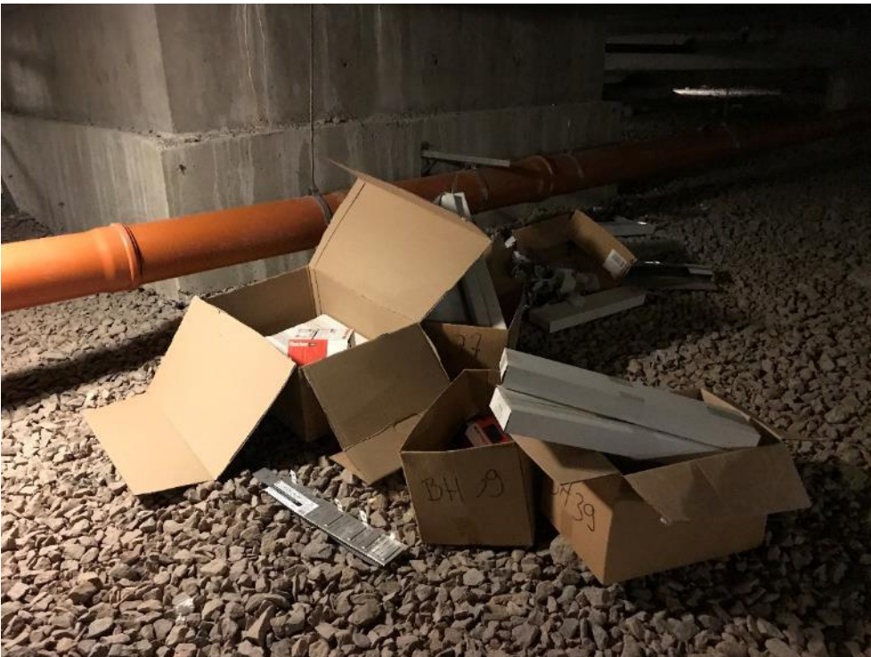
Kuva 4.4. Alapohjatilassa on roskaa.
