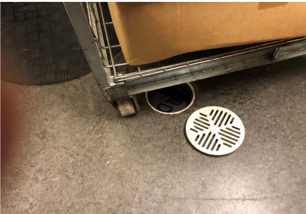
Kuva 5.4. Muiden varaston 1056 lattiakaivo on kuiva ja piilossa rullakon alla.
