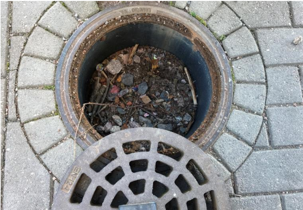
Kuva 5.6. Sadevesikaivoissa on soraa ja ylimääräistä tavaraa.
