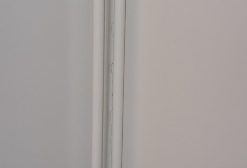
Kuva 4.5. Luokassa 1105 on seinien liittymä auennut.
