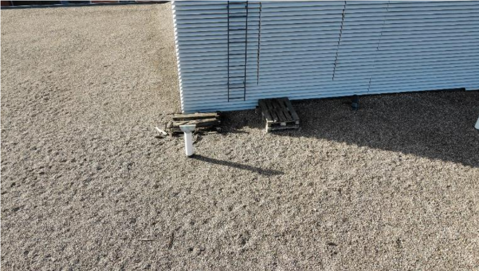
Kuva 4.3. Vesikatolla on rikkinäisiä kuormauslavoja.
