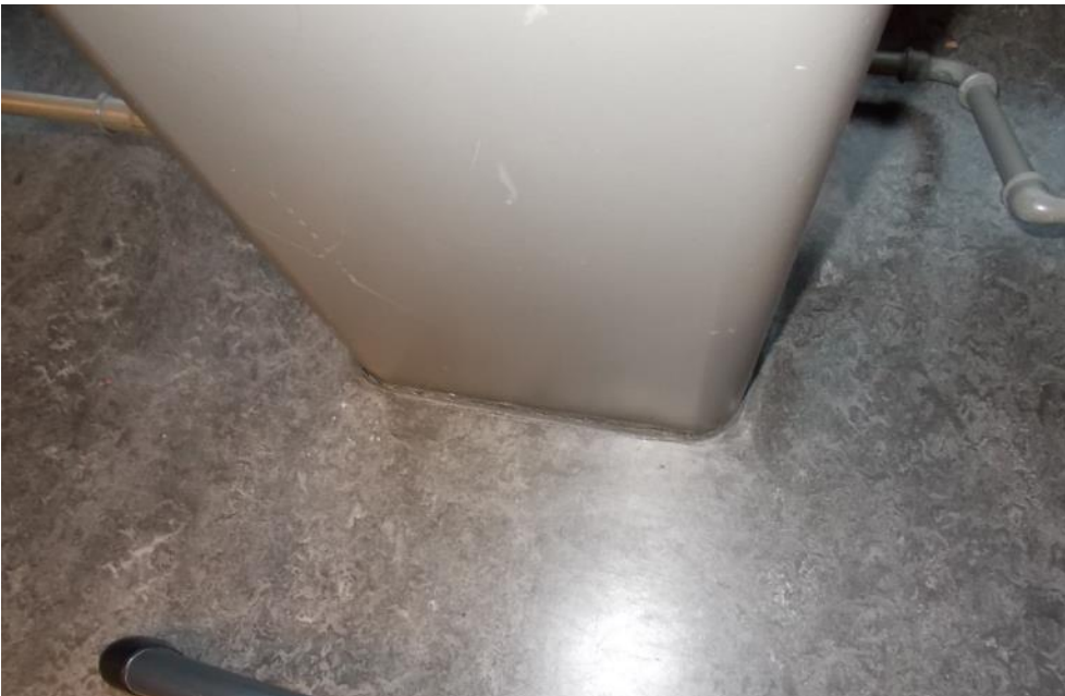
Kuva 4.8. Lattiamatto on osin irti luokassa 1135.
