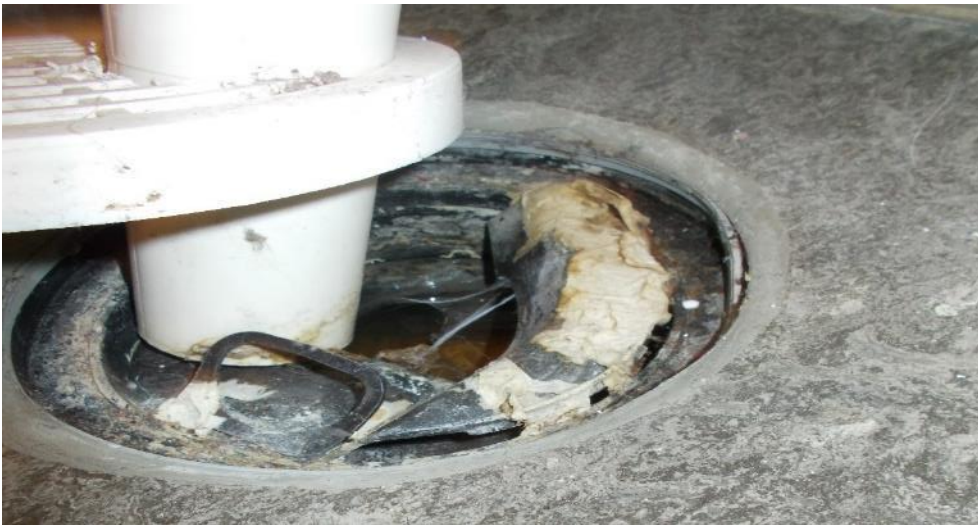
Kuva 5.1. Liikuntasalin pukuhuonetilojen lattiakaivon sisäosa on irti.
