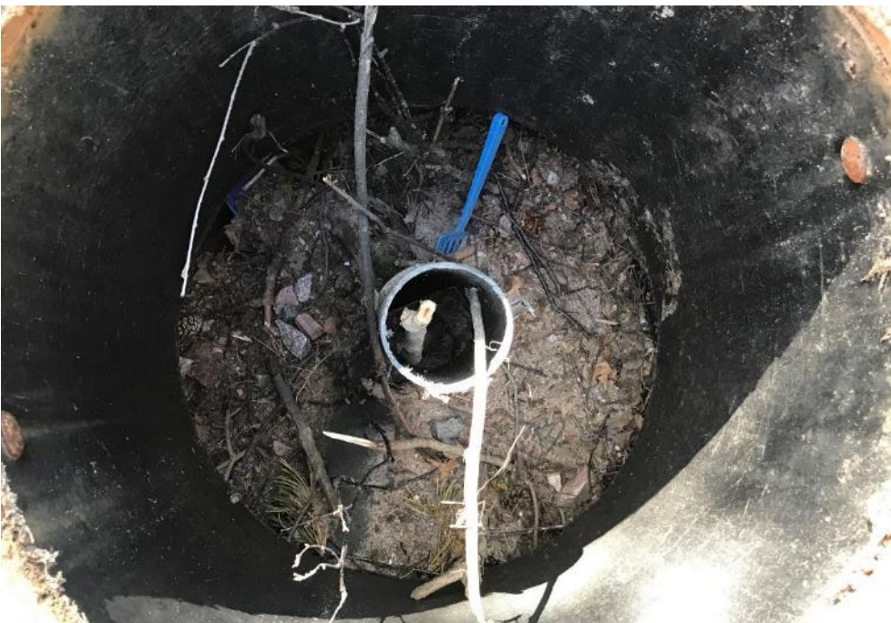
Kuva 5.16. Sadevesikaivoissa on hiekkaa ja muuta roskaa.
