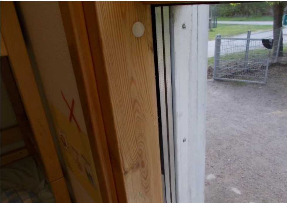
Kuva 4.7. Huonetiloissa lämpölasielementtien tiivistyksissä on puutteita.
