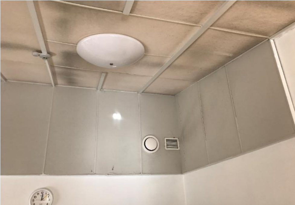
Kuva 4.12. Alakaton akustiikkalevyt ovat likaisia.
