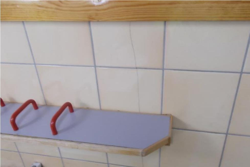
Kuva 4.10. Pesutiloissa on haljenneita laattoja.
