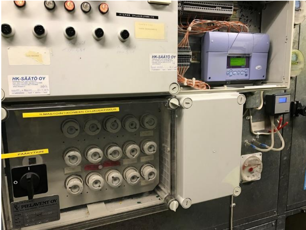
Kuva 6.1. Kevyt saneeraus on tehty rakennusautomaatioon ja palovaarallinen sähkökeskus.
