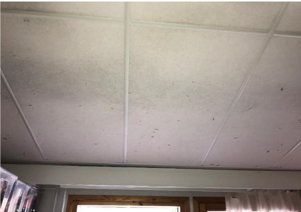
Kuva 4.13. Alakaton akustiikkalevyt ovat likaisia ja rikkoutuneet.
