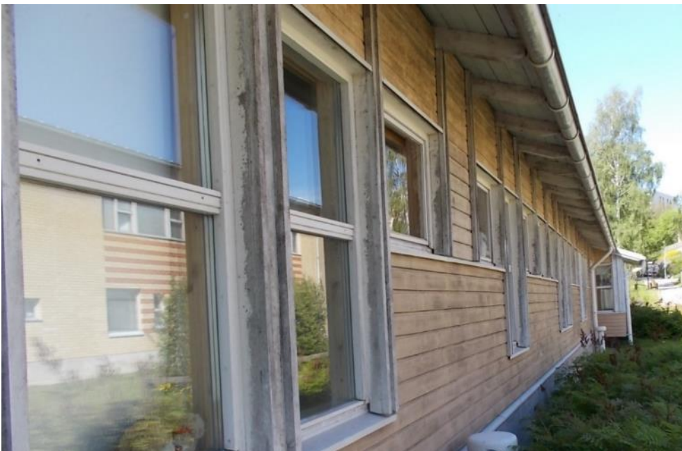
Kuva 4.1. Julkisivulaudoitus ja ikkunan puitteet ovat maalausta vailla.
