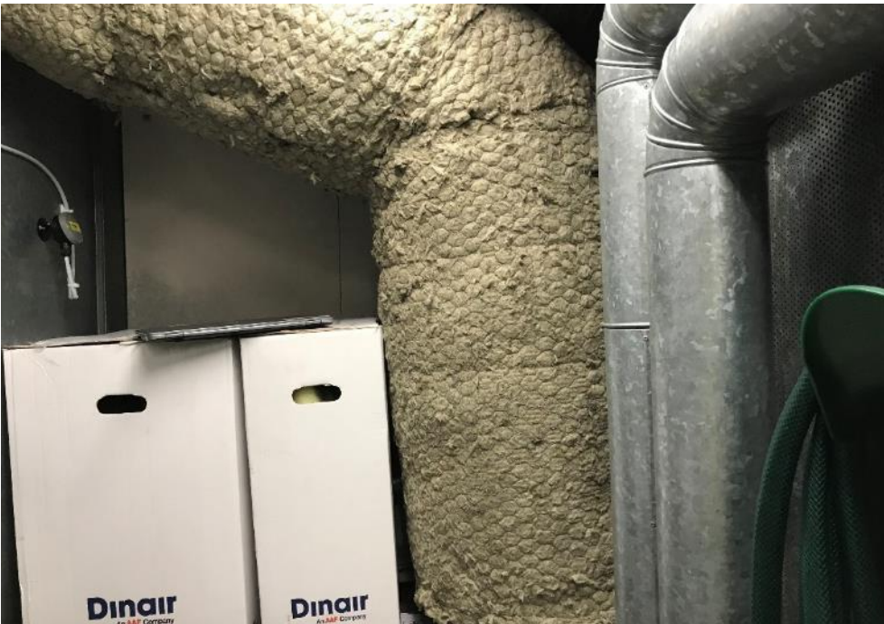
Kuva 5.4. Konehuoneessa on pinnoittamatonta villaa.
