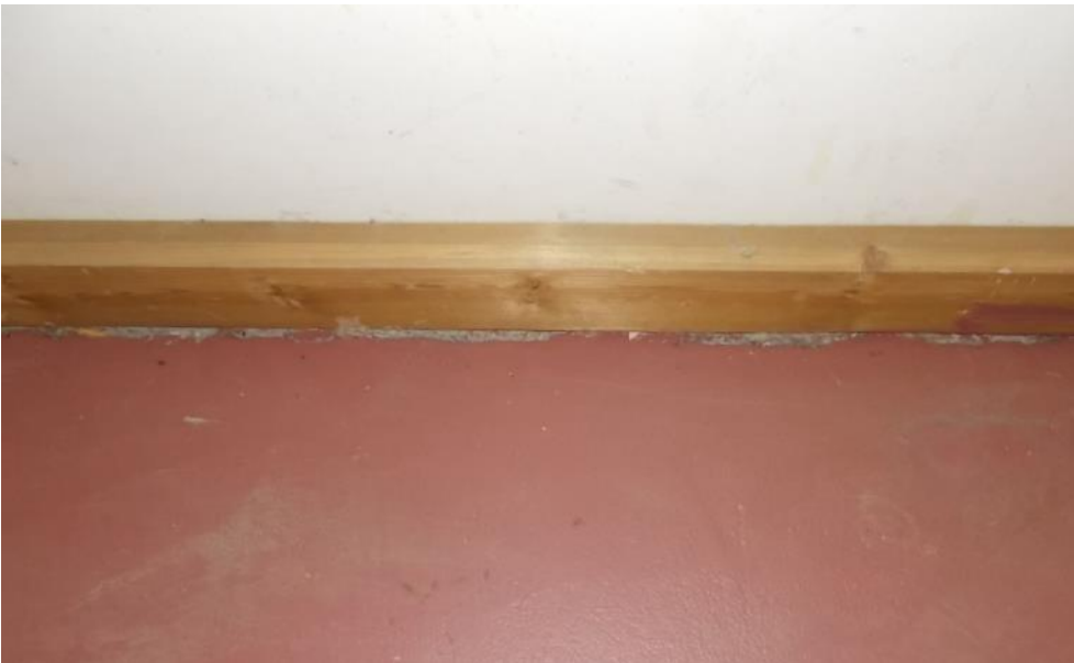
Kuva 4.11. Teknisessä tilassa seinän ja lattian liittymä ei ole tiivis.
