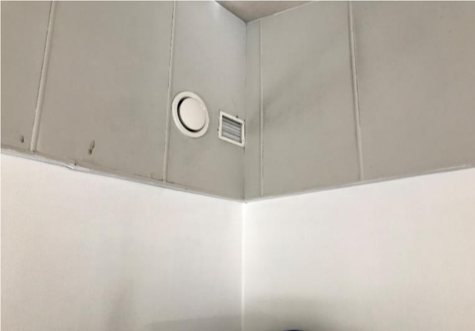
Kuva 5.11. Tulo- ja poistoilmaelimet on asennettu vierekkäin.
