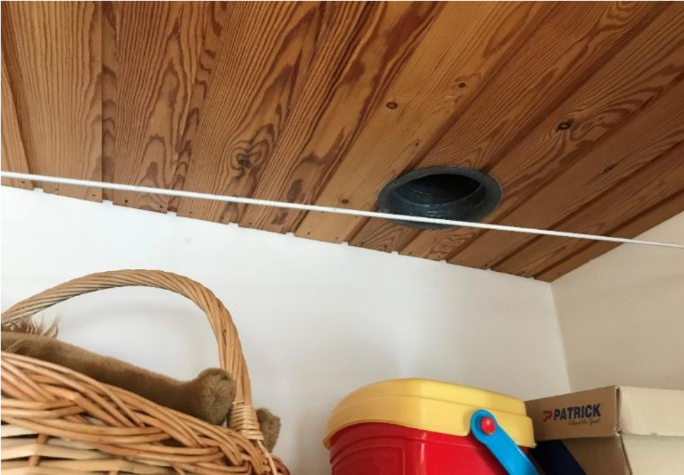
Kuva 5.13. Vesileikkihuoneen poistoilmaventtiili puuttuu.
