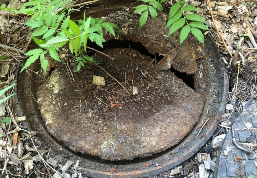
Kuva 5.15. Rasvanerotuskaivon sisäkansi on pahoin ruostunut.
