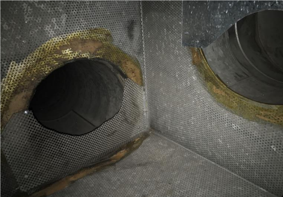
Kuva 5.3. Tuloilmakoneen sisäpuoli tehty reikäpellillä sekä villalla.
