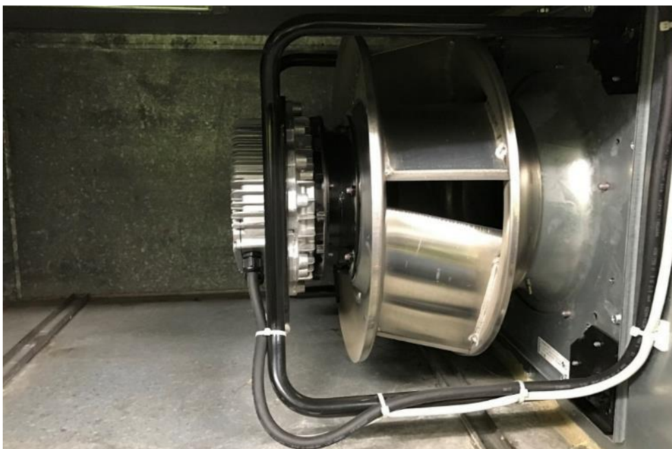
Kuva 6.2. TK1 puhaltimet on uusittu hiljattain.
