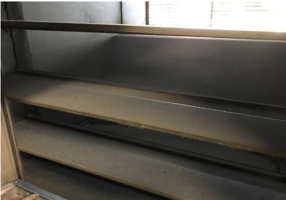
Kuva 5.2. Raitisilmakammiossa on roskaa ja viemärointi puuttuu.
