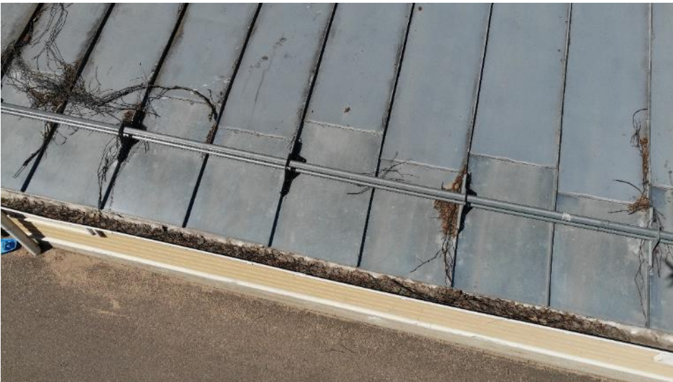
Kuva 4.5. Sadevesikourut ovat puhdistamatta.
