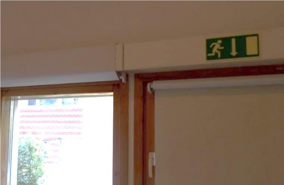
Kuva 4.6. Hätäpoistumistien kyltti on väärän ikkunan kohdalla.
