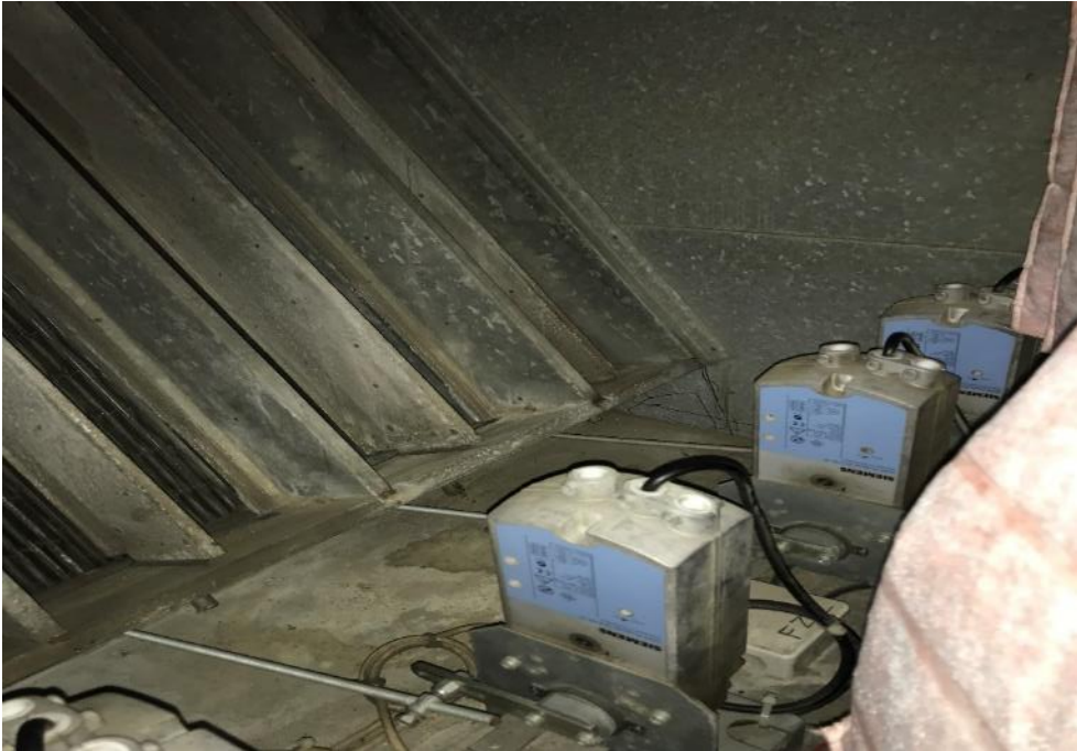
Kuva 5.5. Lämmöntalteenoton LTO:n pellistö on likainen.
