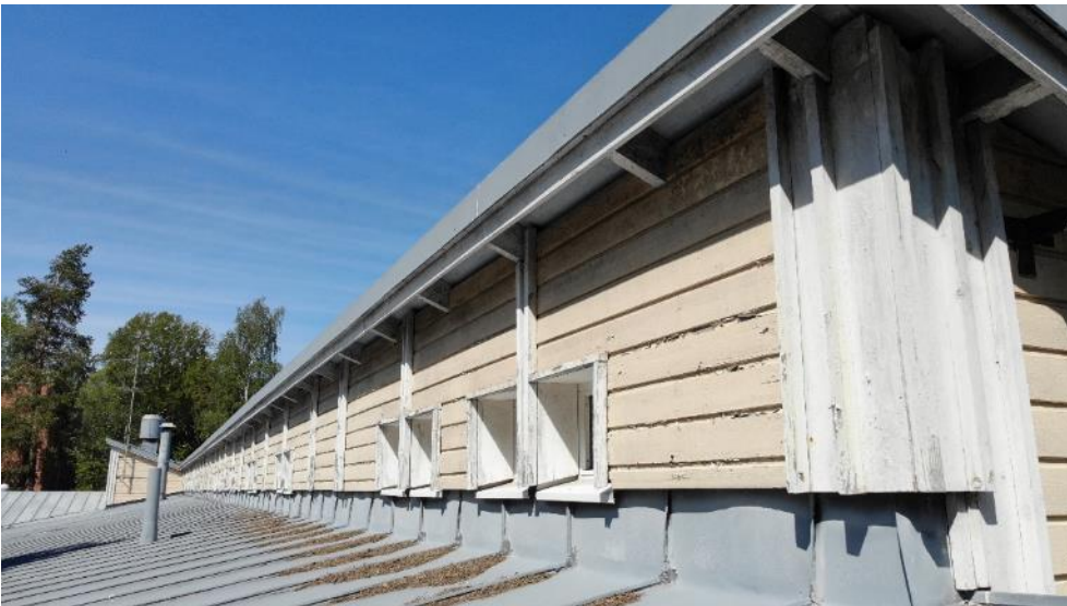
Kuva 4.3. Julkisivulaudoitus ja ikkunan puitteet ovat maalausta vailla sekä katto vaatii puhdistusta.
