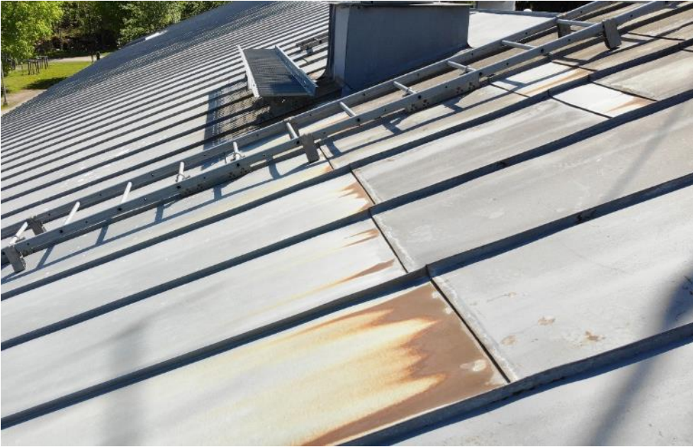
Kuva 4.4. Vesikatteessa on ruostetta.
