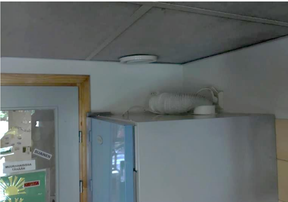
Kuva 5.14. Kuivauskaapin poistoletku on irti.
