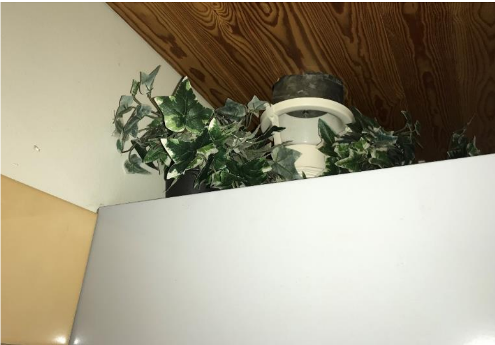
Kuva 5.12. Eteisen kuivauskaapin poistoilmaventtiin säätöosa puuttuu.
