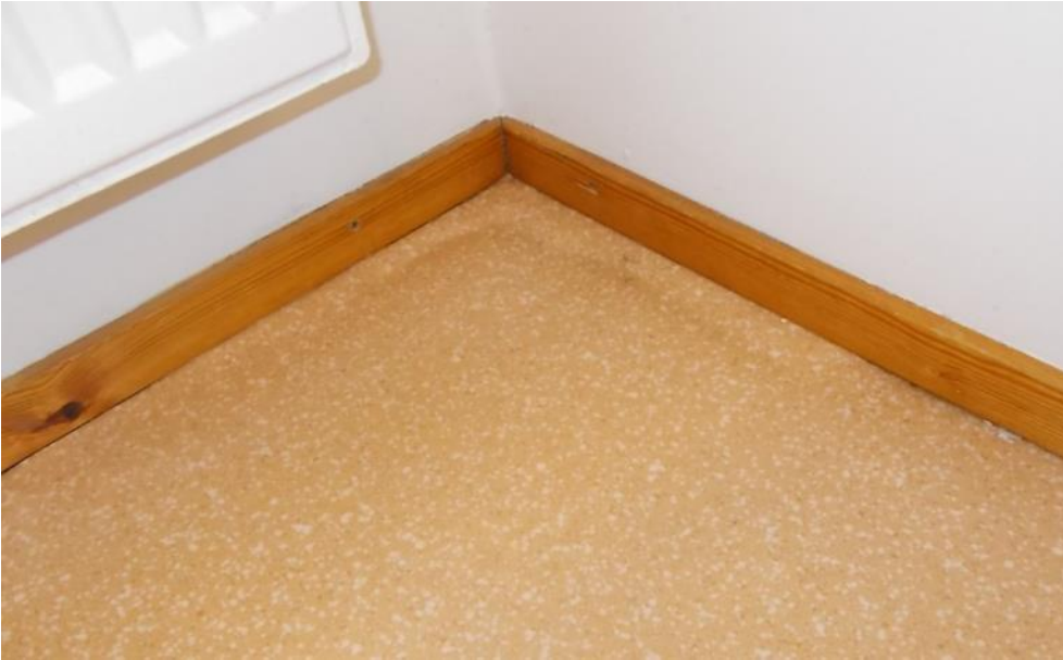
Kuva 4.8. Huonetilojen lattiamatoissa on korjattavaa.
