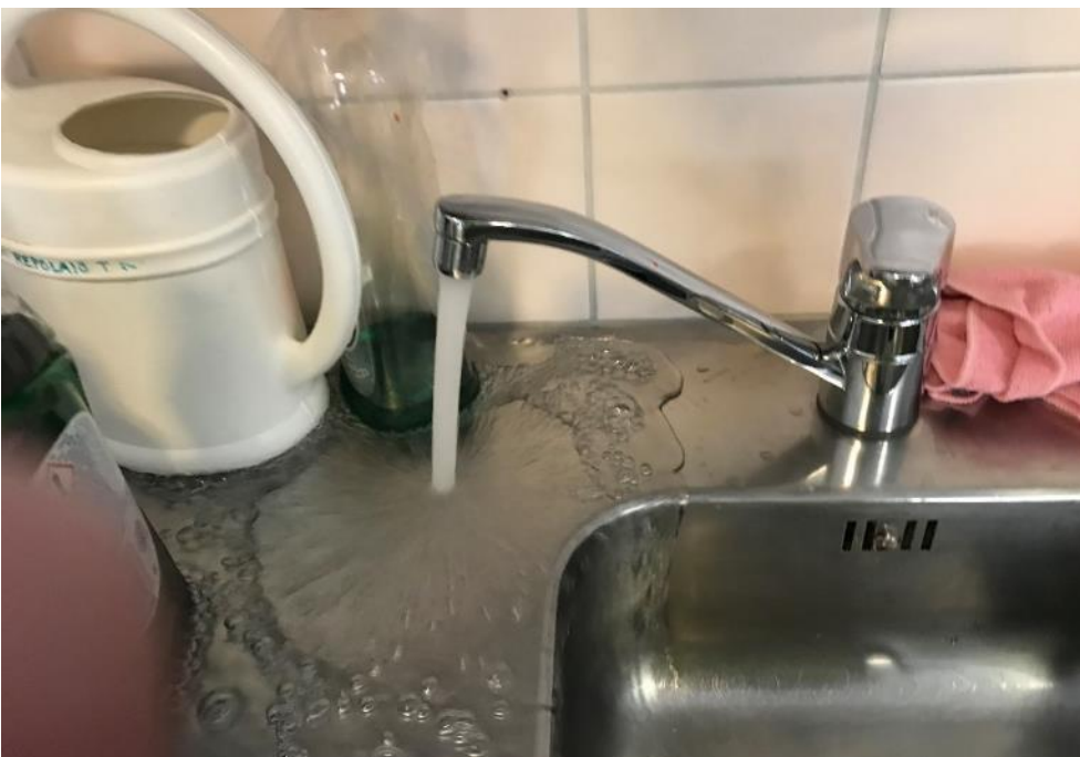
Kuva 5.8. Allashanan kääntörajoitin puuttuu.
