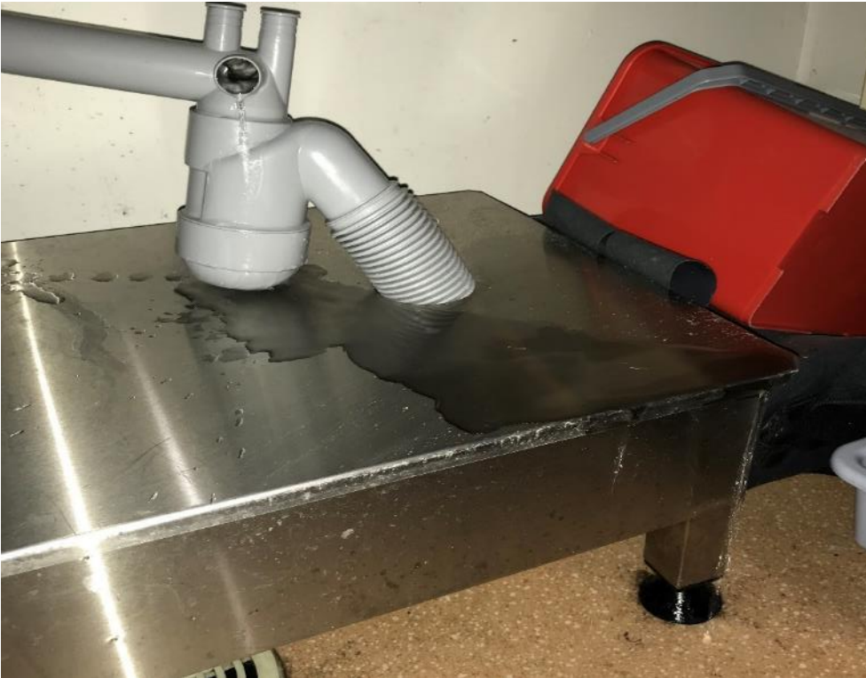
Kuva 5.7. Siivouskomeron pesualtaan vesilukko vuotaa ja kannakointi on puutteellinen sekä nukka-allas haisee, koska sitä ei ole puhdistettu.
