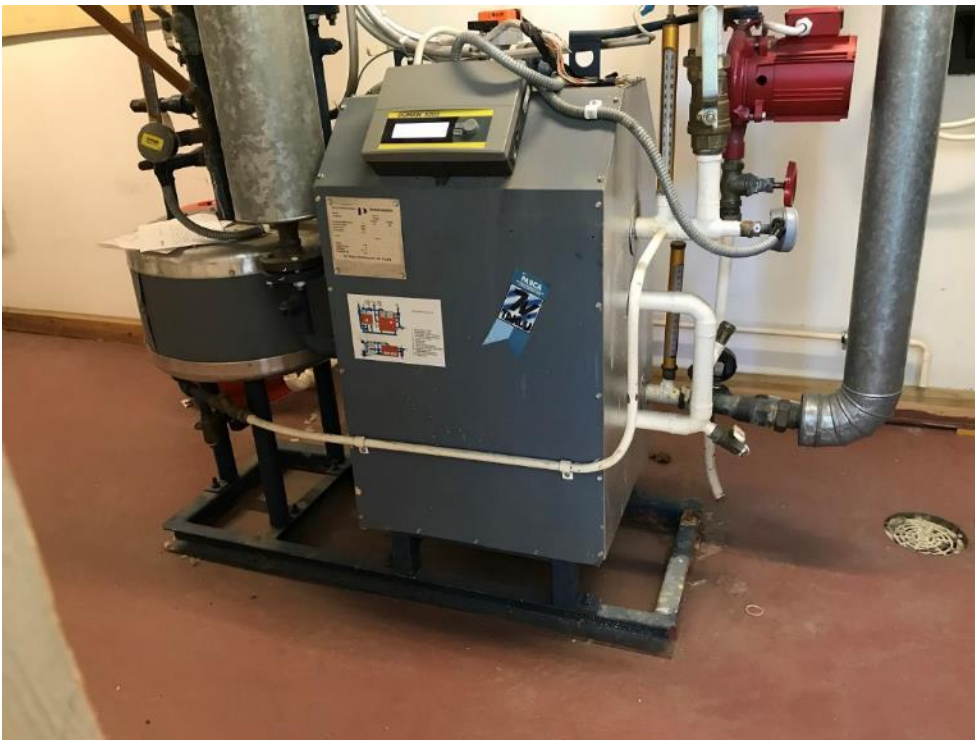
Kuva 6.4. Lämmönvaihdinpaketti on siistissä kunnossa ikäisekseen.
