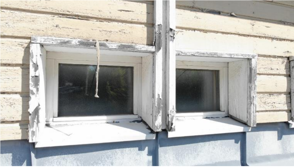
Kuva 4.2. Julkisivulaudoitus ja ikkunan puitteet ovat maalausta vailla.
