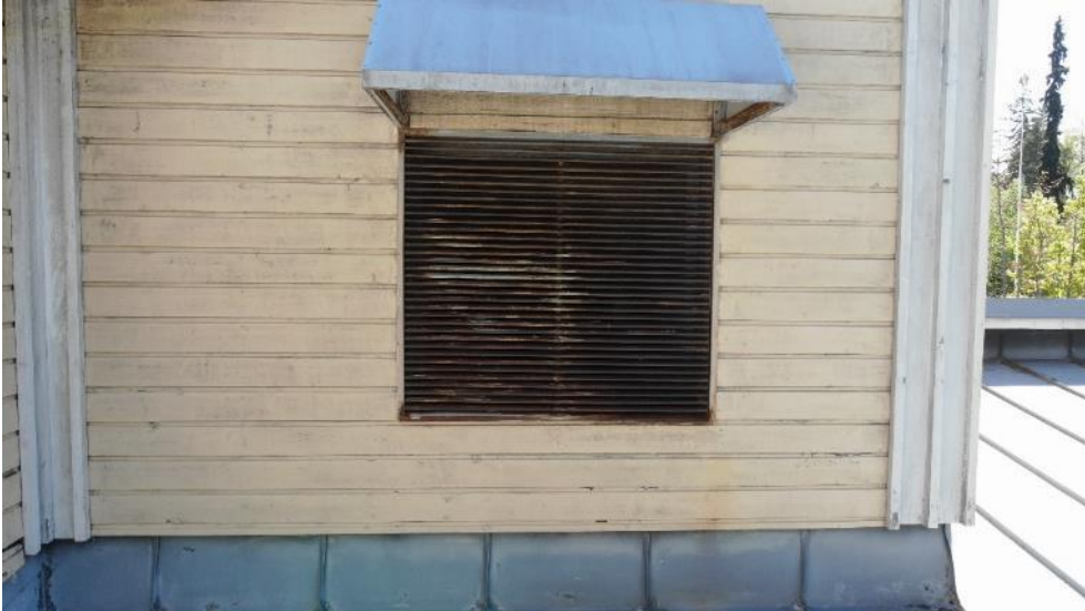
Kuva 5.1. Tuloilman ulkosäleikkö on täysin ruosteessa.
