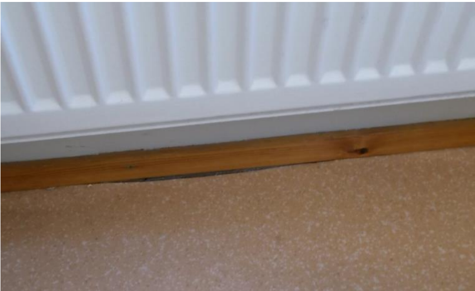
Kuva 4.9. Huonetiloissa seinän ja lattian liittymät eivät ole tiiviitä.
