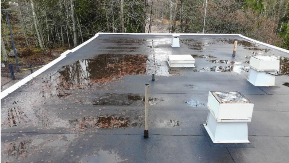
Kuva 4.1. Vesikatolla seisoo vettä.
