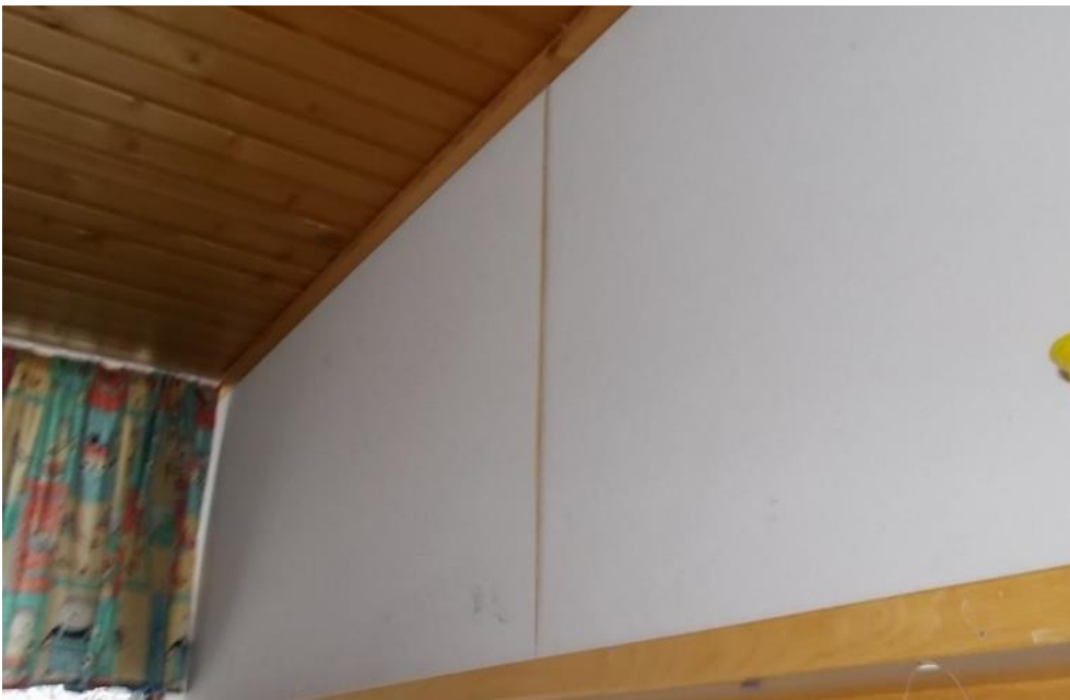
Kuva 4.2. Osassa akustolevystä on villaa näkyvissä.
