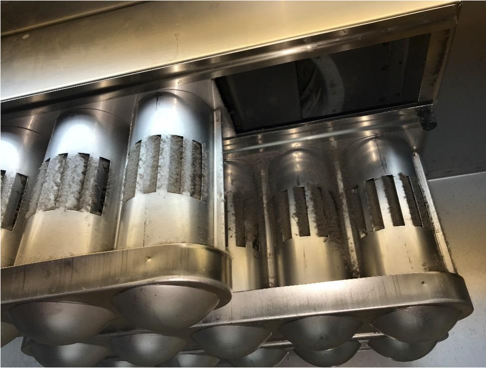
Kuva 5.6. Keittiön astianpesun rasvasuodattimet ovat pölyiset.
