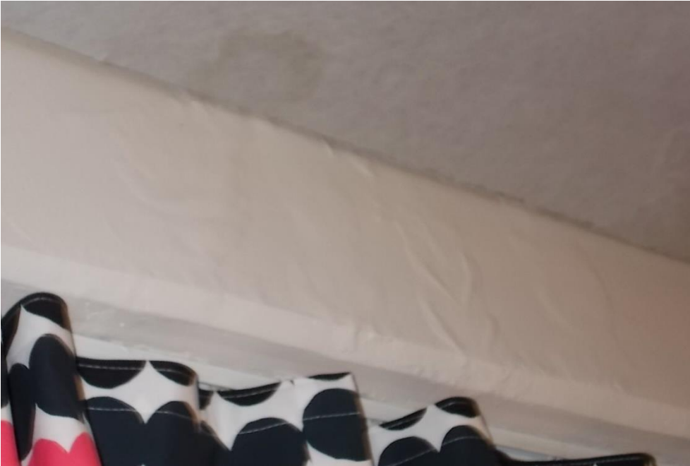
Kuva 4.7. Palkissa on vesivuotojälkiä.
