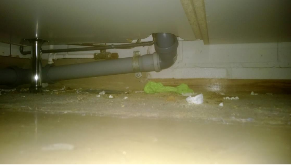
Kuva 4.15. Alakerran Keittiön sokkelin alla roskia ja likaa.
