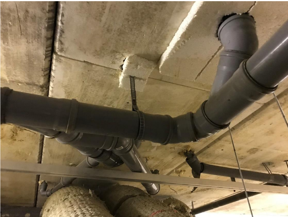
Kuva 5.9. Ryömintätilan viemärien tuenta puutteellinen.
