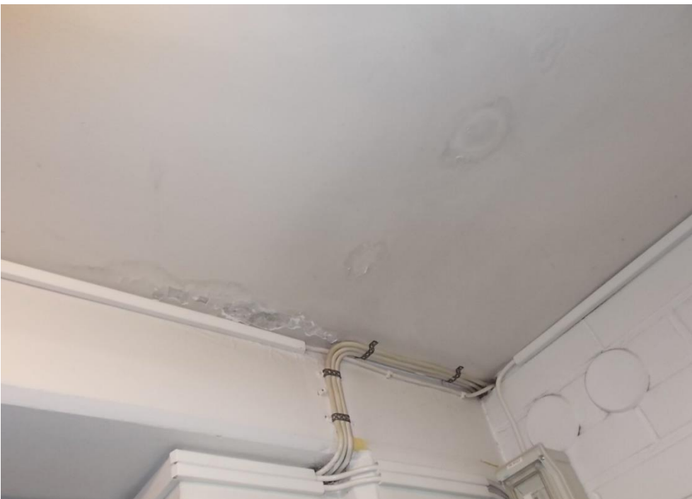
Kuva 4.10. Katossa on vesivuotojälkiä.
