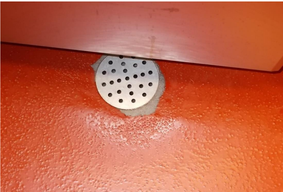
Kuva 4.20. 2. kerroksen Keittiön lattiapinnoitteessa vaurio.
