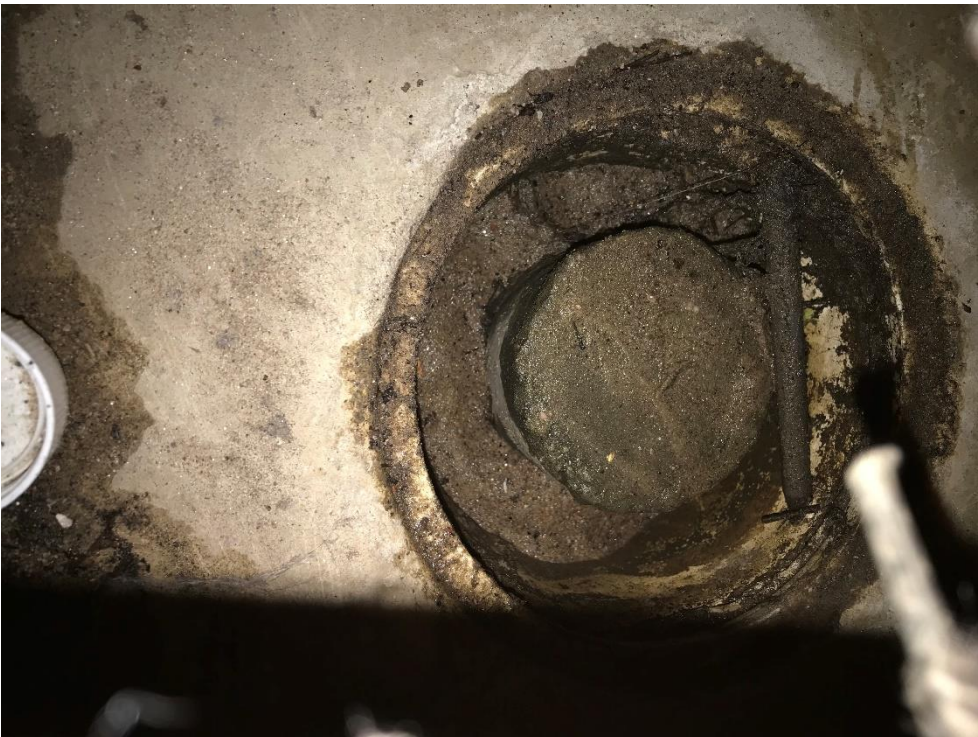
Kuva 5.1. Kuraeteisen lattiakaivo puhdistamatta.
