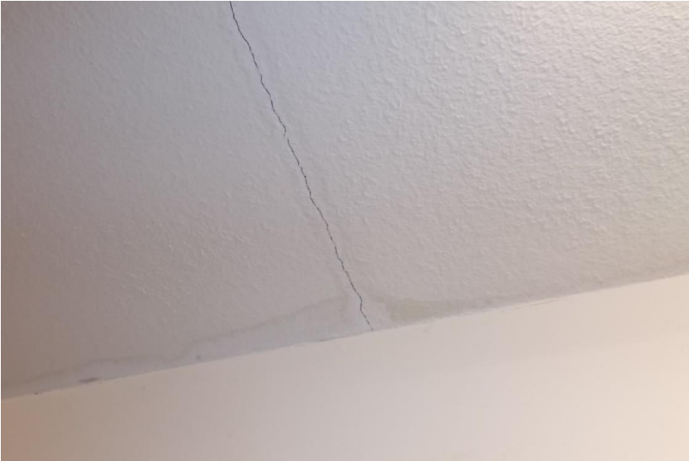
Kuva 4.11. Katossa on halkeama ja vesivuotojälki.
