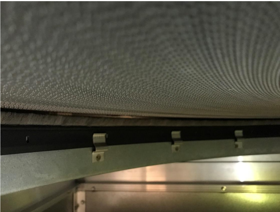
Kuva 5.5. LTO-kiekkö ei ole tiivis.
