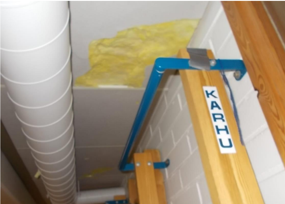
Kuva 4.4. Vaurioituneita akustolevyjä Salissa 216.
