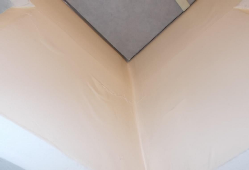
Kuva 4.9. Palkissa on vesivuotojälkiä.
