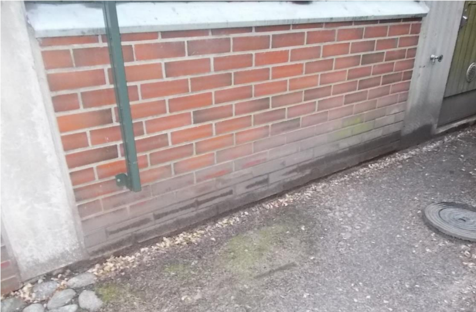
Kuva 4.3. Roiskevesi kastelee ja likaa tiiliverhouksen.
