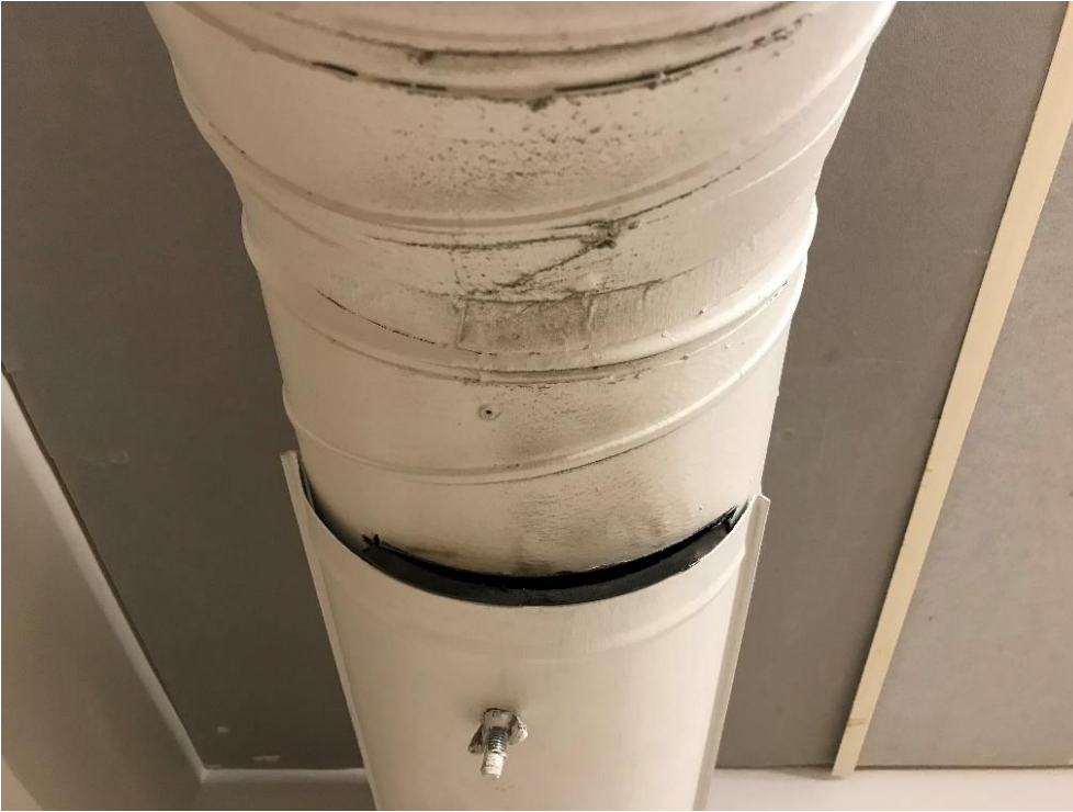
Kuva 5.4. Puhdistusluukku ei ole tiivis huonetilassa 120.
