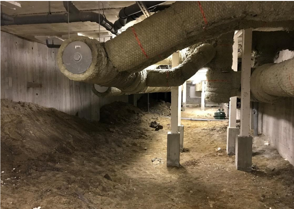
Kuva 4.22. Alapohjatilasta puuttuu kapillaarisen kosteuden nousun estävä sepelikerros sekä tilassa on ylimääräistä hiekkaa.
