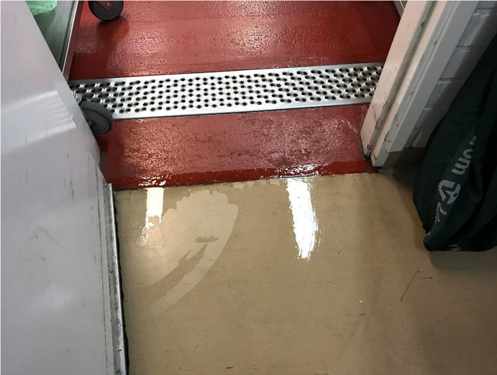
Kuva 4.21. 2. kerroksen Keittiön lattia vedenohjaus ei toimi.
