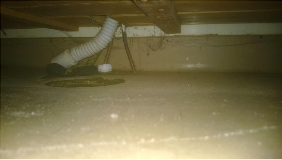
Kuva 5.2. Kuraateisen lavuaarin viemäriputki ohjaa vedet lattialle.
