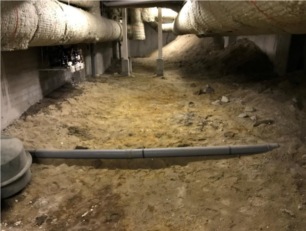
Kuva 5.8. Ryömintätilan vaakaviemärin tuenta puutteellinen.
