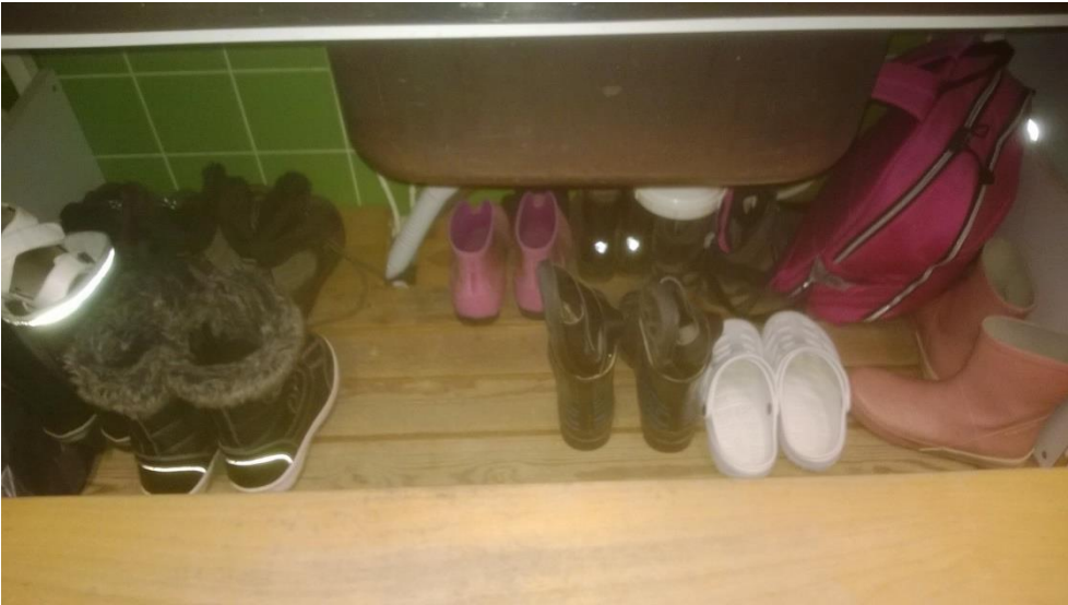
Kuva 5.3. Kuraateisten lavuaarien alla kiinteät kenkätelineet estävät lattiakaivojen puhdistuksen.
