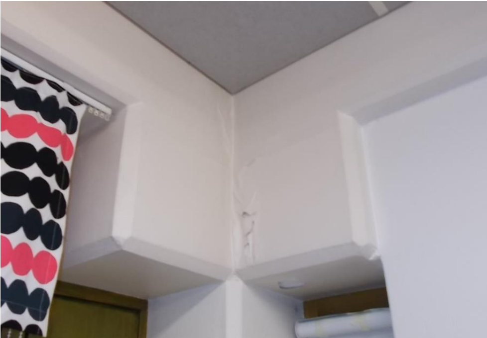
Kuva 4.6. Palkissa on vesivuotojälkiä.
