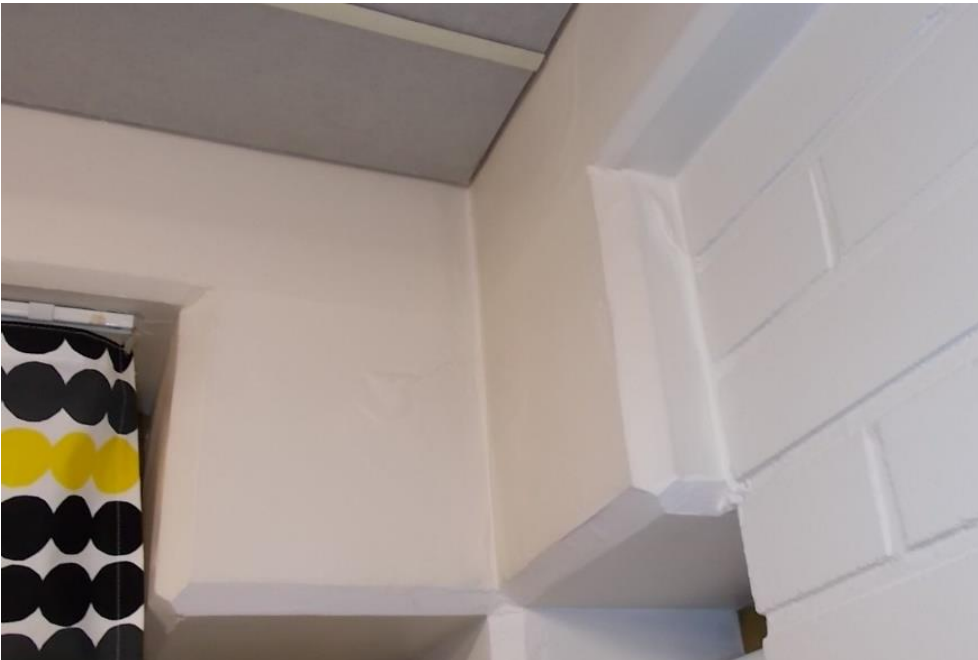
Kuva 4.8. Palkissa on vesivuotojälkiä.
