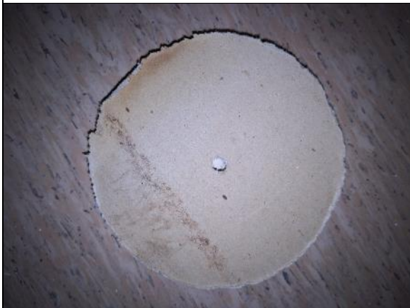
Kuva 136 RAK14. Kipsilevyn sisäpinnalla on värimuutosta.
