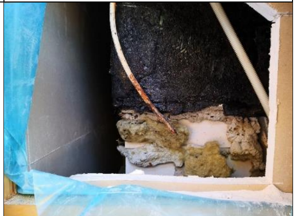
Kuva 251 Savupiippu sijaitsee tarkastusaukon kohdalla.
