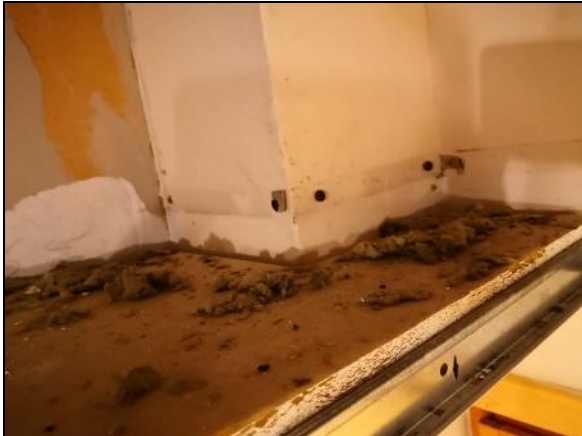
Kuva 242 Alas lasketun katon päällä on mineraalivillajäämiä ja hiiren ulosteita.
