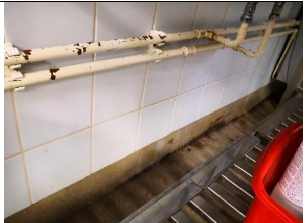
Kuva 34 Keittiön 28 (tuleva Keittiö 129) pesulinjaston kohdalla akryylibetonin ylösnostossa on tummaa kasvustoa.
