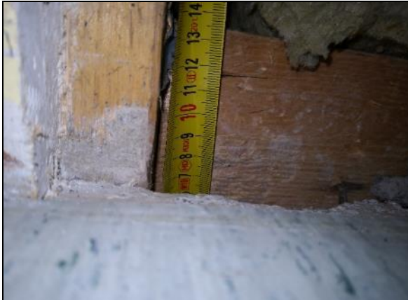
Kuva 189 RAK5. Alaohjauspuun yläpinta on n. 90 mm lattian pinnan tason alapuolella.
