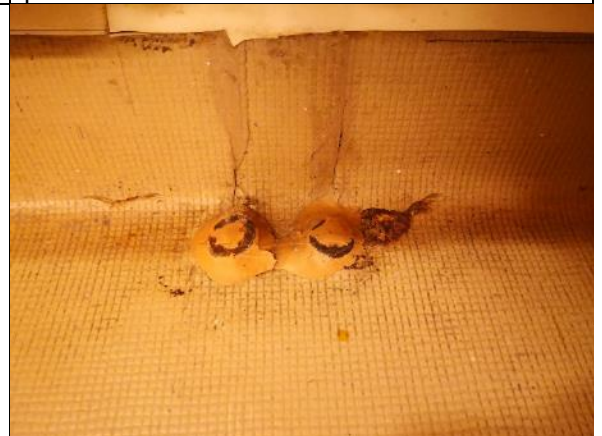
Kuva 32 WC-tiloissa on alkuperäistä muovimattoa, johon lika on pinttynyt. Läpivientejä on tiivistetty silikonilla.
