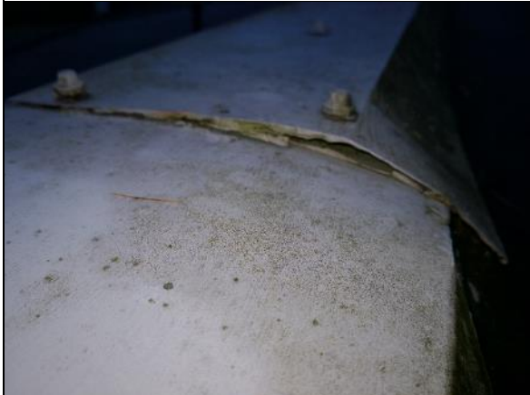
Kuva 222 Peltien liitoskohtia ei ole tiivistetty.
