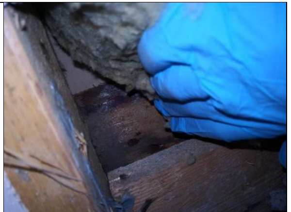
Kuva 171 Odotushuoneen 51 (tuleva Aula 150) kantavan väliseinän vaakarunkopuussa on kosteusjälkiä.
