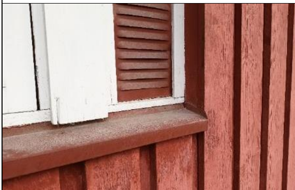
Kuva 92 Ikkunapellityksiä ei ole tiivistetty.
