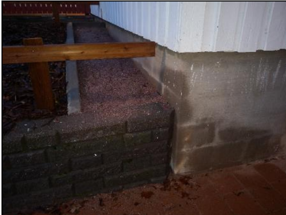
Kuva 82 Istutusaltaan kohdalla sokkeliä vasten on patolevy. Sokkeli on märkä.
