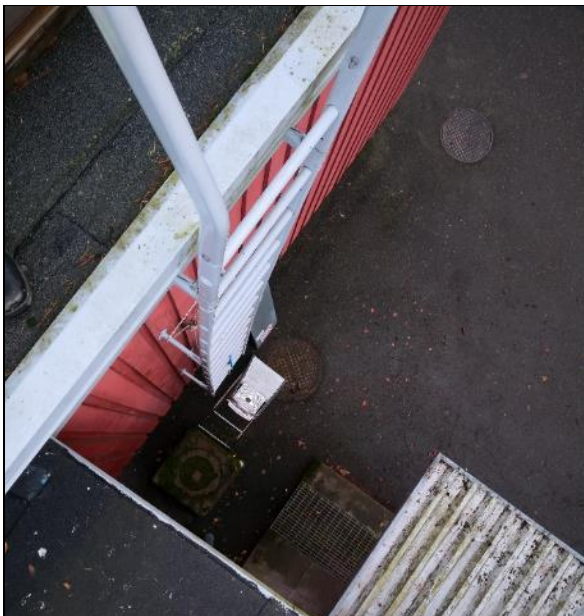
Kuva 228 Nousutikkailta on liian suuri etäisyys hammashoitolan vesikatolle siirtymistä varten.
