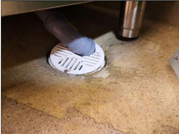
Kuva 43 Keittiön lattiassa on jyrkkä kaato lattiakaivolle. Kaluste ei pysy tukevasti pystyssä kaadon vuoksi.
