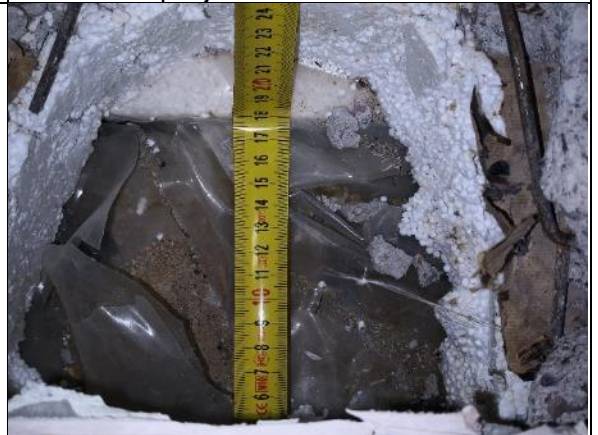
Kuva 60 RAK17. EPS-eristeiden alla on kaksinkertainen muovi muovi, jonka alla on leca-harkko. Muovi jatkuu EPS-eristeiden alle.
