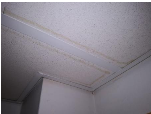
Kuva 240 Keittiön edustalla alaslaskulevyssä on kosteusjälkiä.
