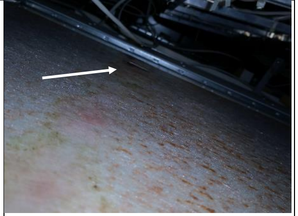
Kuva 245 Alaslaskulevyn yläpinnalla on kosteusjälkiä sekä pieni lätkäkö.
