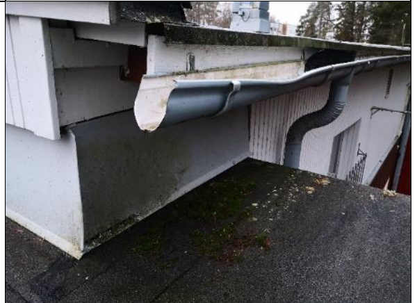
Kuva 225 Räystäskouru on vääntynyt.
