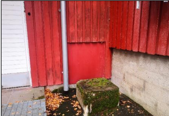
Kuva 17 Seinän ulkopinnalla on kosteusjälkiä syöksytorven ympärillä.
