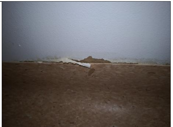
Kuva 103 Tulevan Lepohuoneen 154 ulkoseinän sisäpinnassa olevia kosteusjälkiä.
