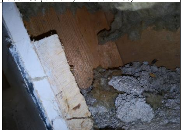
Kuva 196 RAK6. Pystyrunkopuu jatkuu valun alapuolelle.
