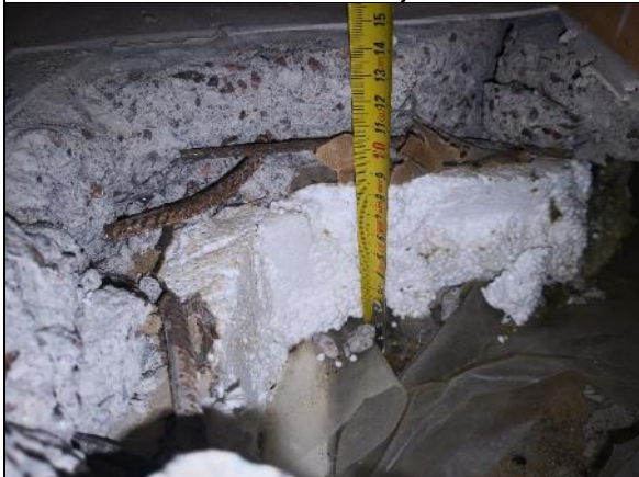
Kuva 59 RAK17. Teräsbetonilaatan alla on paperi ja EPS-eriste.
