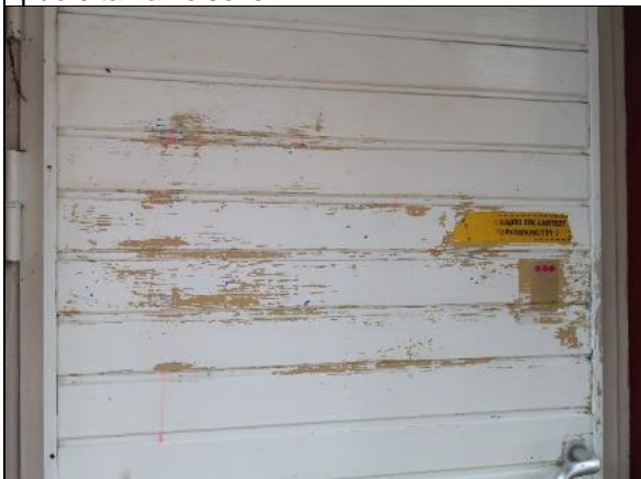
Kuva 98 Puuvien maalipinta on kulunut.
