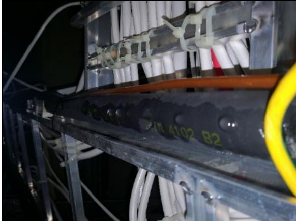
Kuva 244 Jäähdytysputken alapinta on kostea ja siinä on pisaroita.
