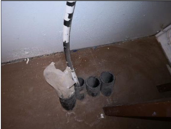
Kuva 39 Tulppaamattomia läpivientejä sähköpääkeskuksessa 71 (tuleva Sähköpääkeskus 159).
