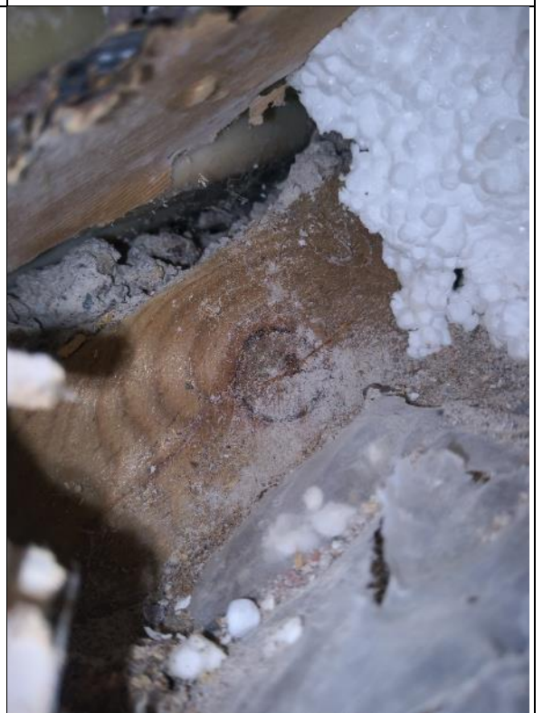
Kuva 192 RAK5. Leca-harkon päällä oleva alaohjauspuu. Alaohjauspuuta vasten on ESP-eriste.
