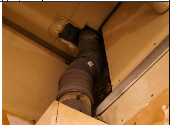
Kuva 233 Tiivistämätön läpivienti Käytävällä 21 (tuleva Käytävä 121).
