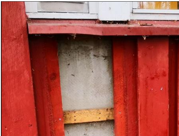
Kuva 102 Tulevan Lepohuoneen 154 ulkoseinän ulkopinnassa olevia kosteusjälkiä.
