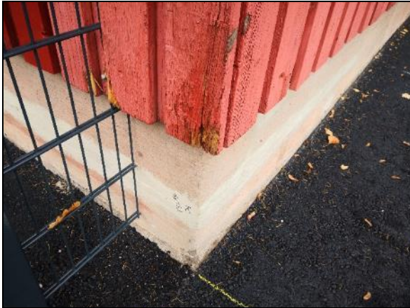
Kuva 76 Julkisivulaudoituksessa on lahovaurioita.
