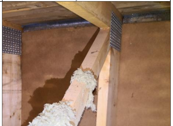
Kuva 269 Tuuletusraoissa on verkot.
