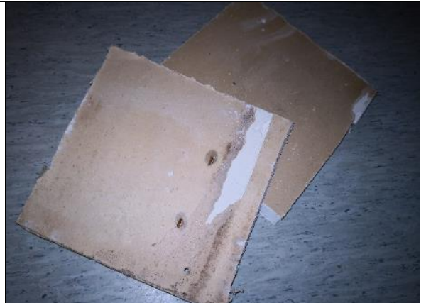
Kuva 190 RAK5. Kipsilevyn sisäpinnalla on kasvustoa.
