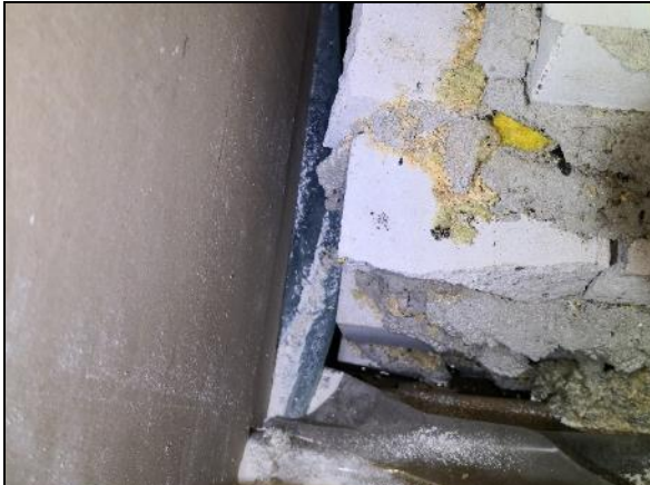
Kuva 252 Piipun läpivienti yläpohjassa ei ole tiivis.
