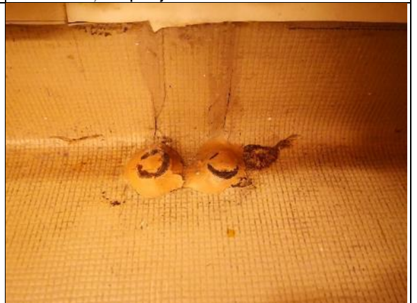
Kuva 38 Läpivientejä, joiden tiivistysmassa on alkanut irtotamaan alustastaan.
