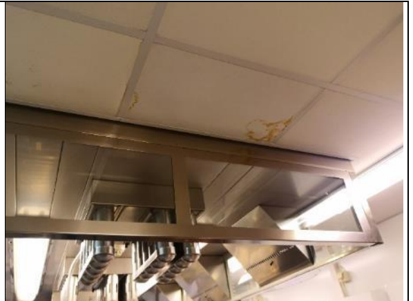
Kuva 243 Keittiön alaslaskulevyn alapinnalla on kosteusjälkiä.
