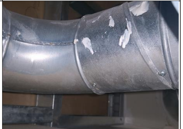
Kuva 281 Kotelorakenteen sisäpuolella levypinnat ovat siistejä. Kanavien pinnoilla on pölyä.
