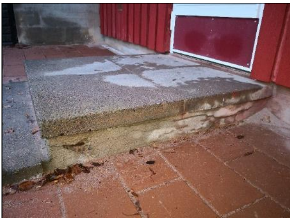
Kuva 284 Sähköpääkeskuksen edustalla oleva portas.
