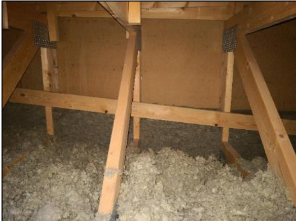
Kuva 264 Levytyksen sisäpinnalla on kosteusjälkiä.
