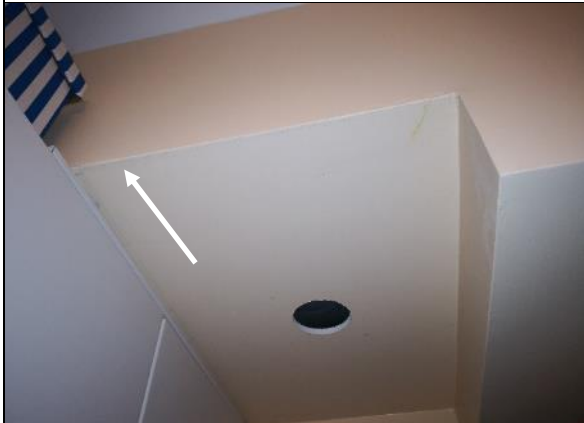
Kuva 280 Kotelorakenteen levyjen liitos on auennut.
