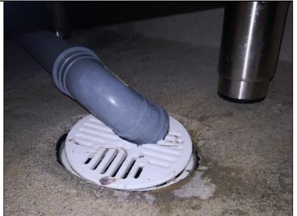
Kuva 44 Keittiön lattiassa on jyrkkä kaato lattiakaivolle. Kaluste ei pysy tukevasti pystyssä kaadon vuoksi.
