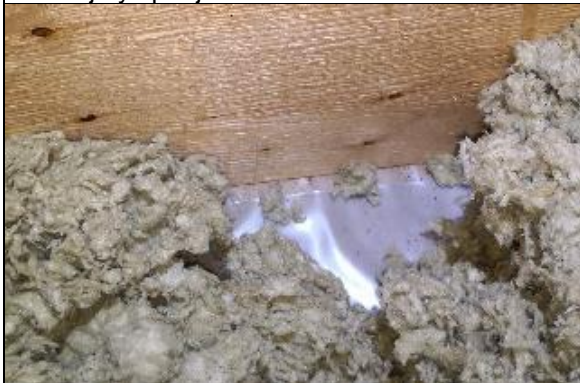
Kuva 234 Limitetty höyrynsulkumuovi yläpohjassa.
