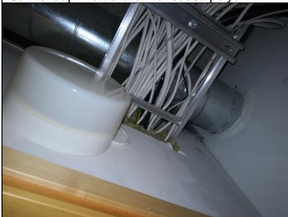
Kuva 297 Epätiivis läpivienti, jossa on mineraalivillaa.
