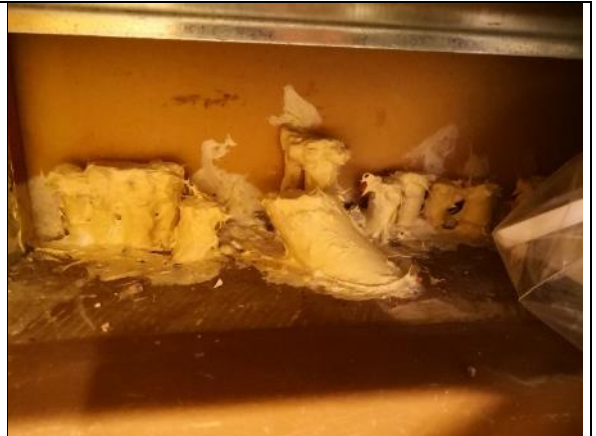
Kuva 40 Asianmukaisesti tiivistettyjä ja tulpattuja läpivientejä hammashoitolassa.
