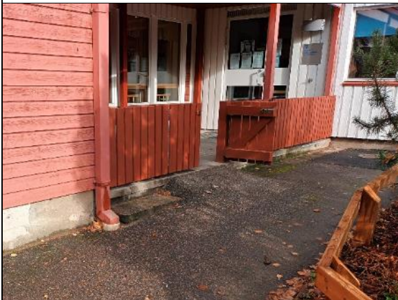
Kuva 290 Menninkäisten sisäänkäynnin betonirakenteisen tasanne.
