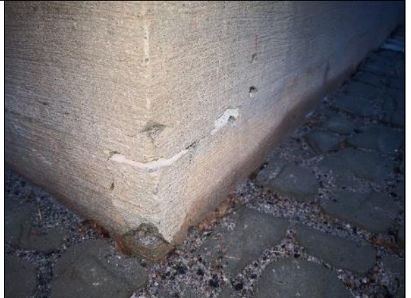
Kuva 79 Paikallisesti sokkeli on murtunut.
