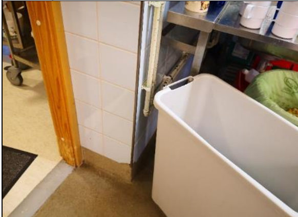
Kuva 162 Keittiön 28 (tuleva Keittiö 129) seinän laatoituksessa on lohkeama.
