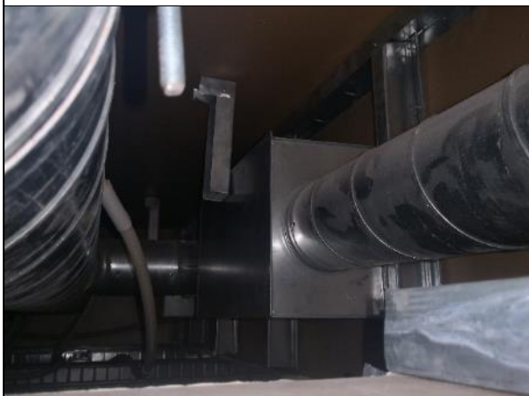
Kuva 282 Kotelorakenteen sisäpuolella levypinnat ovat siistejä. Kanavien pinnoilla on pölyä.
