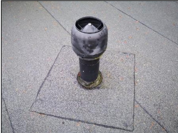
Kuva 216 Läpiviennit on toteutettu asianmukaisesti.
