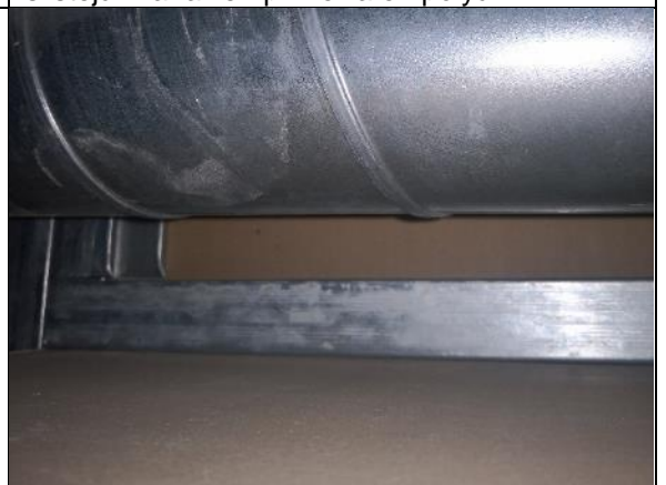
Kuva 283 Kotelorakenteen sisäpuolella levypinnat ovat siistejä. Kanavien pinnoilla on pölyä.
