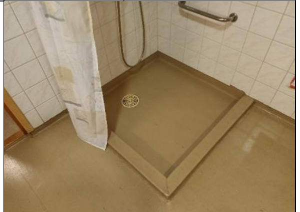
Kuva 163 Päiväkodin pesuhuoneessa on rikkoutuneita seinälaattoja.
