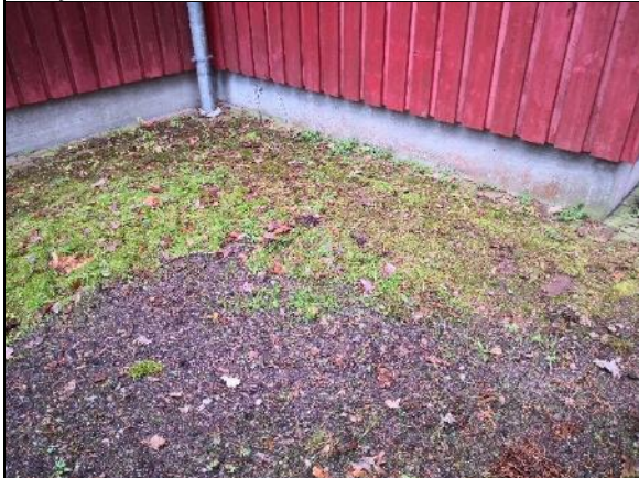
Kuva 84 Päiväkodin Lounais-seinustalla ei ole patolevyjä.
