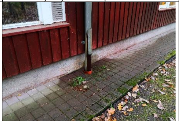
Kuva 20 Vuotavan tarkastusluukun kautta tippuva vesi kastelee maata ja sokkelia.
