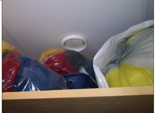
Kuva 306 Varaston 12 (tuleva Varasto 119) poistoilma- venttiili on kiinni.
