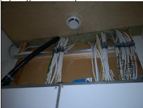
Kuva 232 Käytävällä 21 (tuleva Käytävä 121) sijaitsevan sähkökaapin alueella on tiivistämättömiä läpivientejä yläpohjassa.
