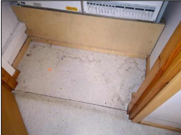
Kuva 295 Sähkökaapin lattialla on runsaasti pölyä.
