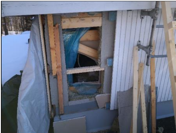
Kuva 248 Monitoimihallin ullakon väliaikainen tarkastusaukko.
