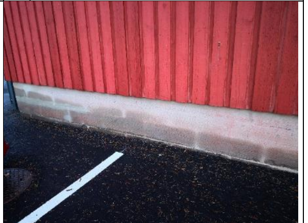
Kuva 85 Sade kastelee sokkeliä parkkialueen kohdalla.
