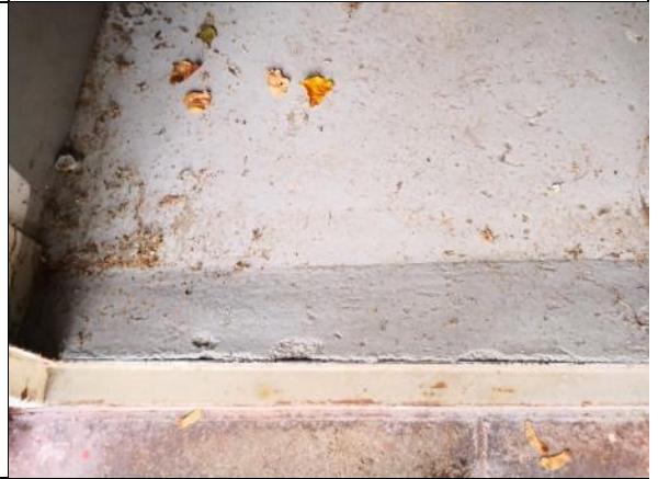
Kuva 36 Lämmönjakohuoneen 70 (tuleva Lämmönjakohuone 157) alapohjassa on maali.
