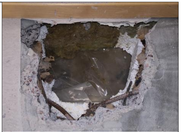
Kuva 145 RAK20. Betonirakenteen ja EPS-eristeenkohdalla ulkoseinässä on mineraalivillakaistale, jonka takana on rakennusmuovi ja sokkelin betonirakenne.
