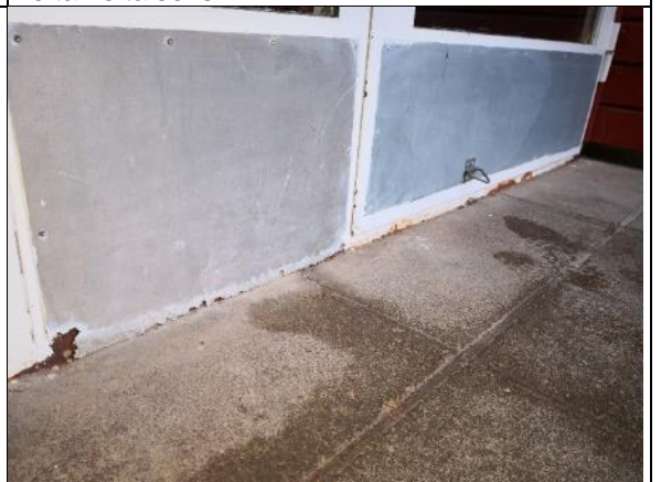
Kuva 99 Teräsovissa on korroosiovaurioita.
