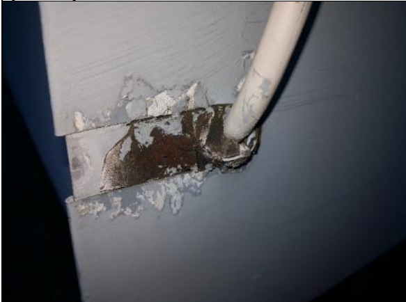
Kuva 214 Vesikatolla olevien IV-laitteiden tiivistysmassaukset ovat huonossa kunnossa.
