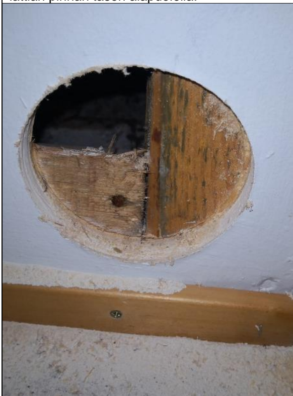
Kuva 191 RAK5. Väliseinän toisella puolella on vain yksi kipsilevy.
