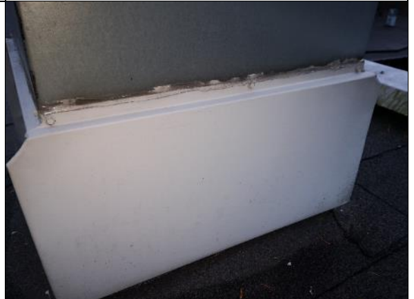
Kuva 215 Vesikatolla olevien IV-laitteiden massaukset ovat huonossa kunnossa.
