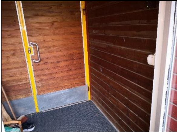
Kuva 303 Päiväkodin keskiosan sisäänkäynnin tuuli- kaapissa on mikrobiperäinen haju.
