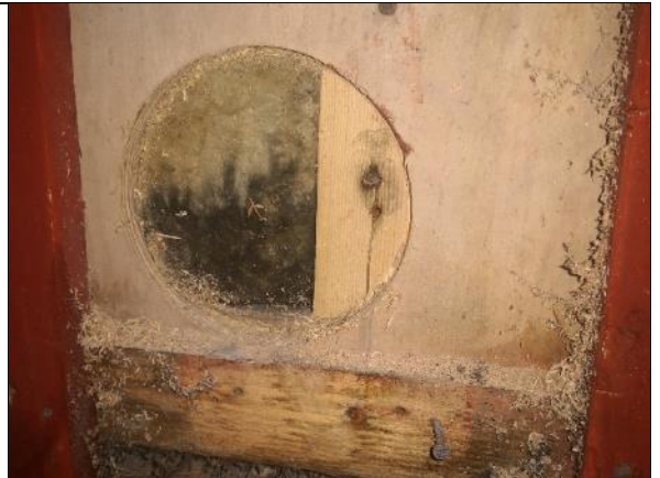
Kuva 125 RAK12. Laudoituksen takana olevassa rimassa ja vanerissa on kosteusjälkiä.
