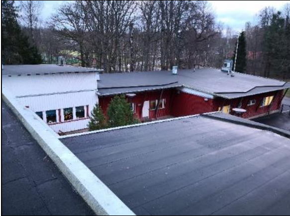
Kuva 210 Sirotepintainen kermi on hyväkuntoinen.
