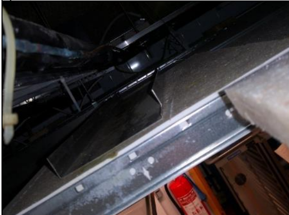
Kuva 246 Alaslaskulevyn yläpinnalla on kosteusjälkiä
