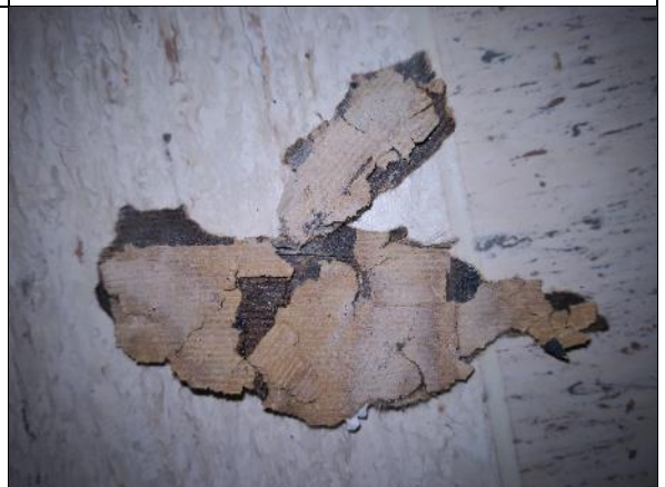
Kuva 64 RAK18. Betonivalun ja ESP-eristeen välissä oleva paperi.
