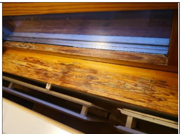
Kuva 91 Kosteusvauriojälkiä ikkunoiden puurakenteissa.
