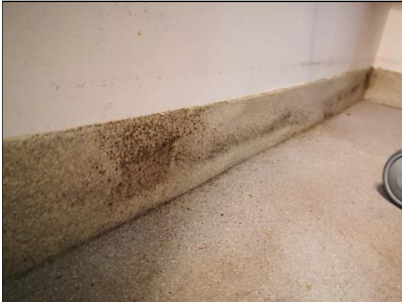
Kuva 33 Keittiön kuiva-ainevaraston 30 (tuleva Varasto 130) akryylibetonin ylösnostossa on tummaa kasvustoa.
