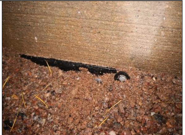
Kuva 83 Istutusaltaan kohdalla sokkeliä vasten on patolevy.
