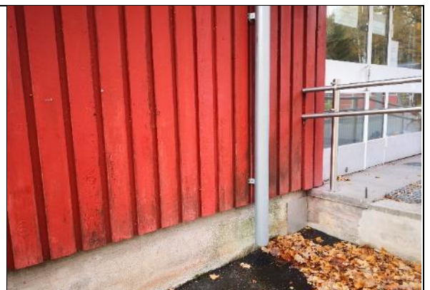
Kuva 16 Koillis-seinustalla sisäänkäyntikatosten syöksytorvet ohjaavat sadeveden sokkelin viereen asfaltin pinnalle.
