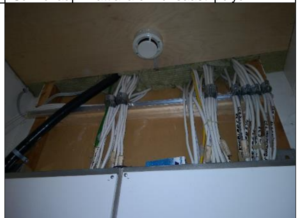
Kuva 298 Epätiivis läpivienti, jossa on mineraalivillaa.
