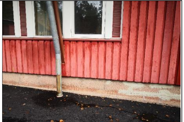
Kuva 18 Syöksytorvien tarkastusluukkujen kautta vuotaa vettä syöksytorven ulkopuolelle maahan.
