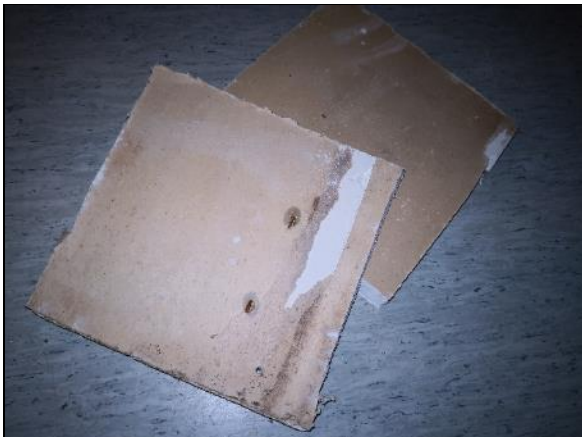
Kuva 170 Odotushuoneen 51 (tuleva Aula 150) kantavan väliseinän kipsilevyssä on kasvustoa.
