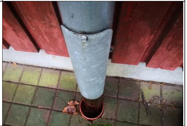
Kuva 22 Vuotavan tarkastusluukun kautta tippuva vesi kastelee kiveystä rännikaivon ympärillä.
