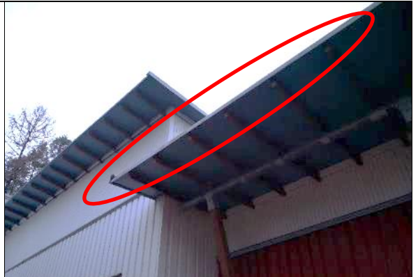
Kuva 24 Kerhon sisäpihan puoleiselta räystäältä tippuu sadevettä maahan.
