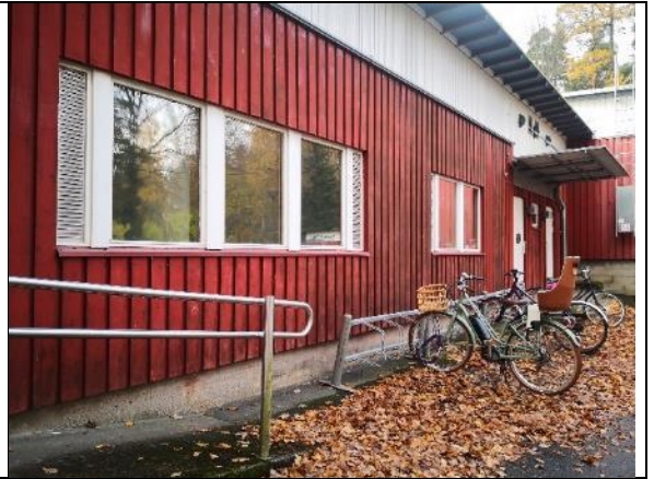
Kuva 77 Laudoituksen pinnalla on kasvustoa.
