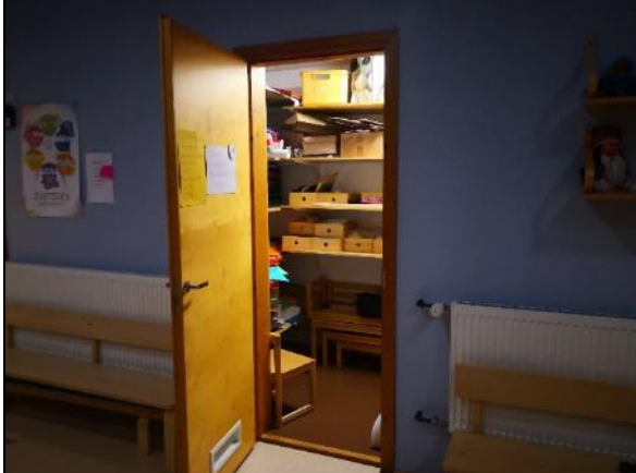
Kuva 305 Varastossa 12 (tuleva Varasto 119) on tunkkai- nen haju.
