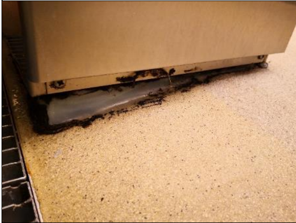
Kuva 35 Keittiön laitteiden tiivistysmassoissa on tummaa kasvustoa.
