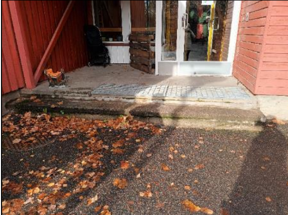
Kuva 286 Päiväkodin keskiosan sisäänkäynnin porras.
