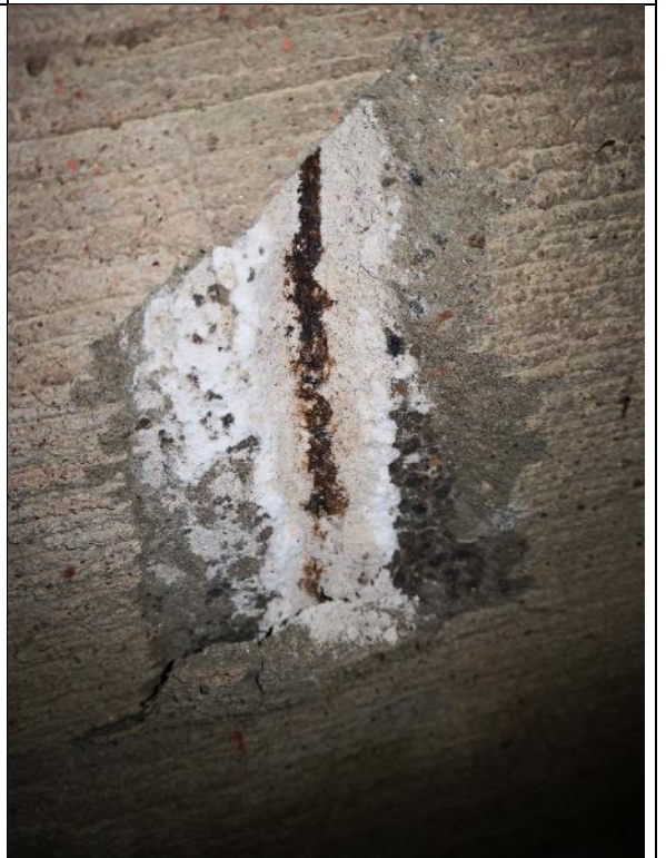
Kuva 81 Harjateräs sekä sen ympärillä oleva muuraus- laasti ovat vaurioituneet.
