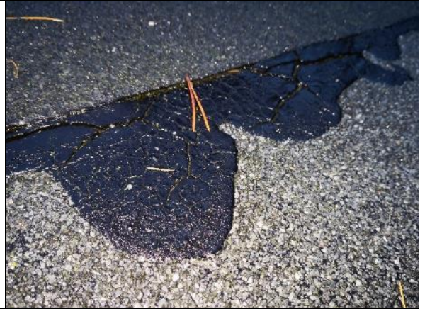
Kuva 211 Bitumimassa on suomuuntunutta.
