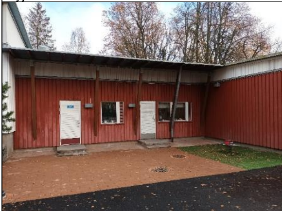
Kuva 86 Sokkeli on matala sähköpääkeskuksen ja kerhon sekä hammashoitolan kohdalla sisäpihan puolella.
