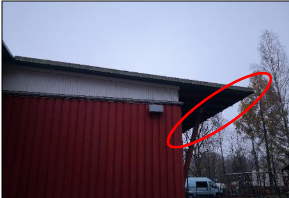
Kuva 23 Hammashoitolan sisäpihan puoleiselta räystäältä tippuu sadevettä maahan.
