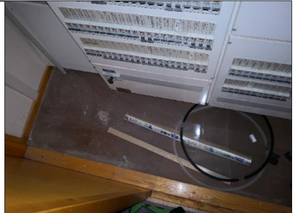
Kuva 296 Sähkökaapin lattialla on runsaasti pölyä.
