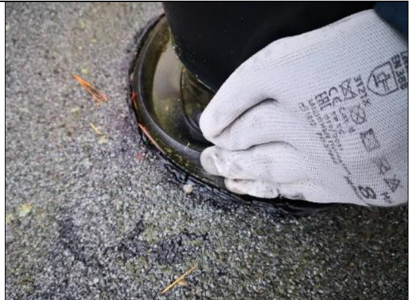
Kuva 217 Läpiviennin massa on haurastunut.
