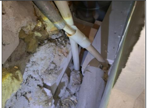
Kuva 253 Yläpohjan epätiivittä läpivientejä.
