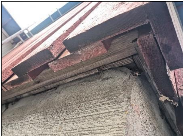
Kuva 74 Ulkoseinä tuulettuu seinän alaosasta lomalaudoituksen rakojen kautta vain heikosti.
