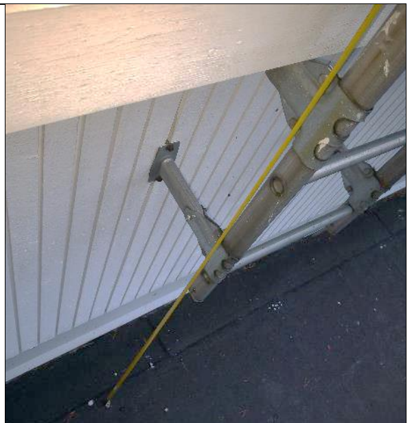
Kuva 229 Nousutikkaat sijaitsevat alempaan kattotasanteeseen nähden liian korkealla.
