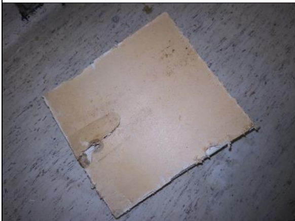
Kuva 172 Hammaslääkärin tila 63 (tuleva Ryhmähuone 153) kantavan väliseinän kipsilevyssä on kasvustoa.
