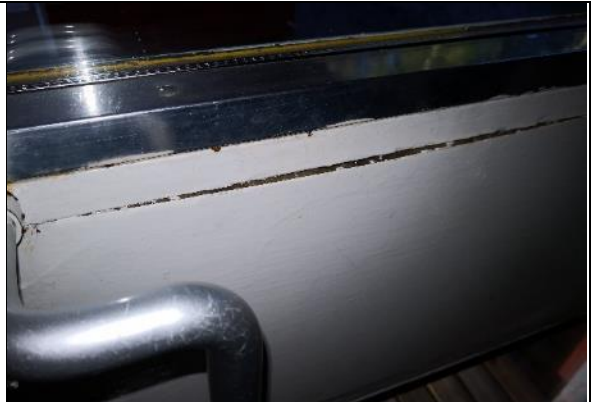
Kuva 101 Teräsovien pellitysten liitokset ovat auenneet.
