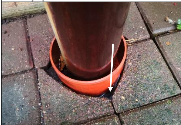
Kuva 19 Takapihan puolella syöksytorven tarkastusluukusta tippuu vettä sadevesikaivon ulkopuolelle maahan.
