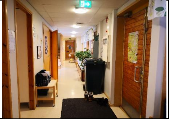
Kuva 95 Puurakenteinen ulko-ovi on sisäpuolelta maa-laamaton.
