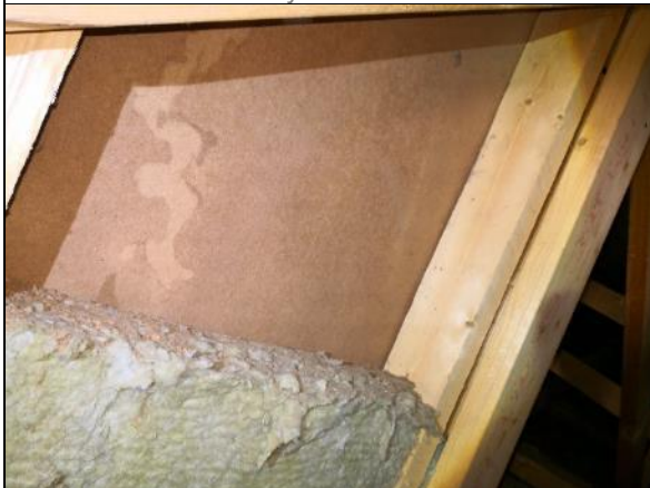
Kuva 260 Levyn sisäpinnalla on kosteusjälkiä.
