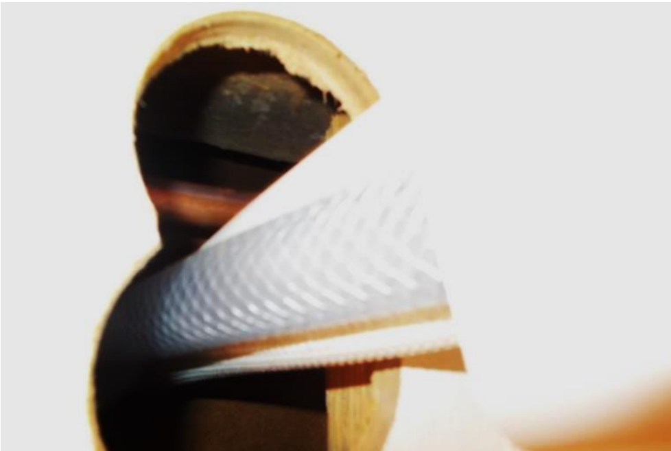
Kuva 4.5. Suttuhuone 17 ilmalämpöpumpun läpiviennit ovat tiivistämättä.
