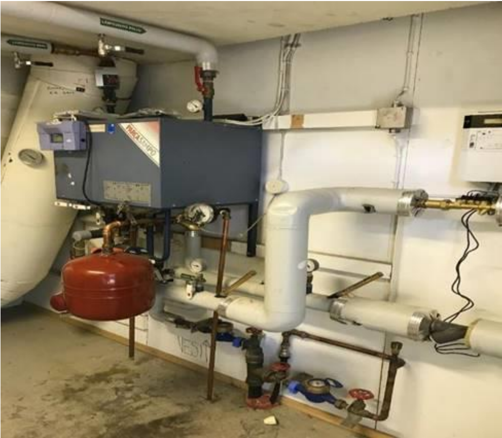
Kuva 5.3. Teknisen tilan lattia on huonossa kunnossa ja vesimittarin kannake on irti.
