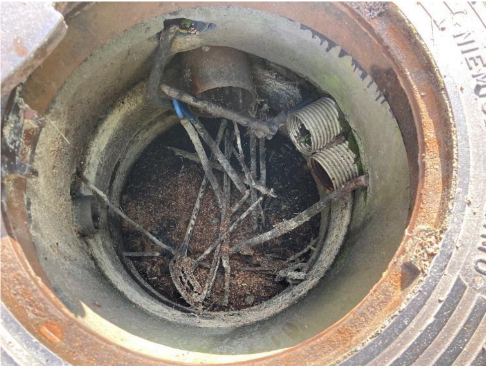
Kuva 5.6. Sadevesikaivossa on hiekkaa ja tavaraa.
