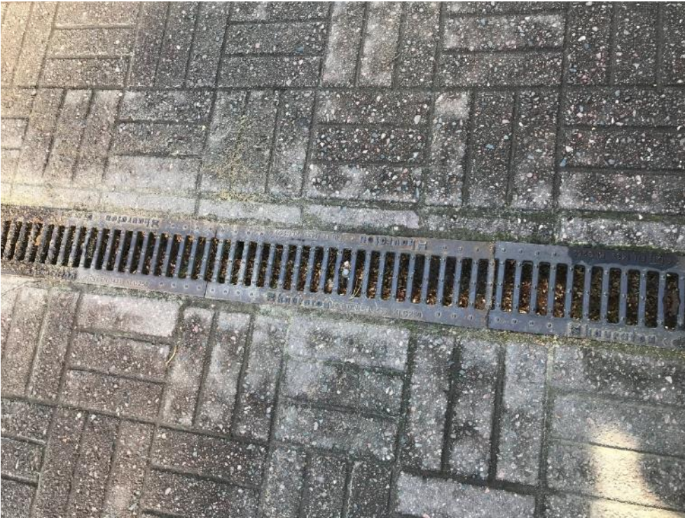
Kuva 5.7. Sadevesiritilässä on paljon hiekkaa ja lehtiä.
