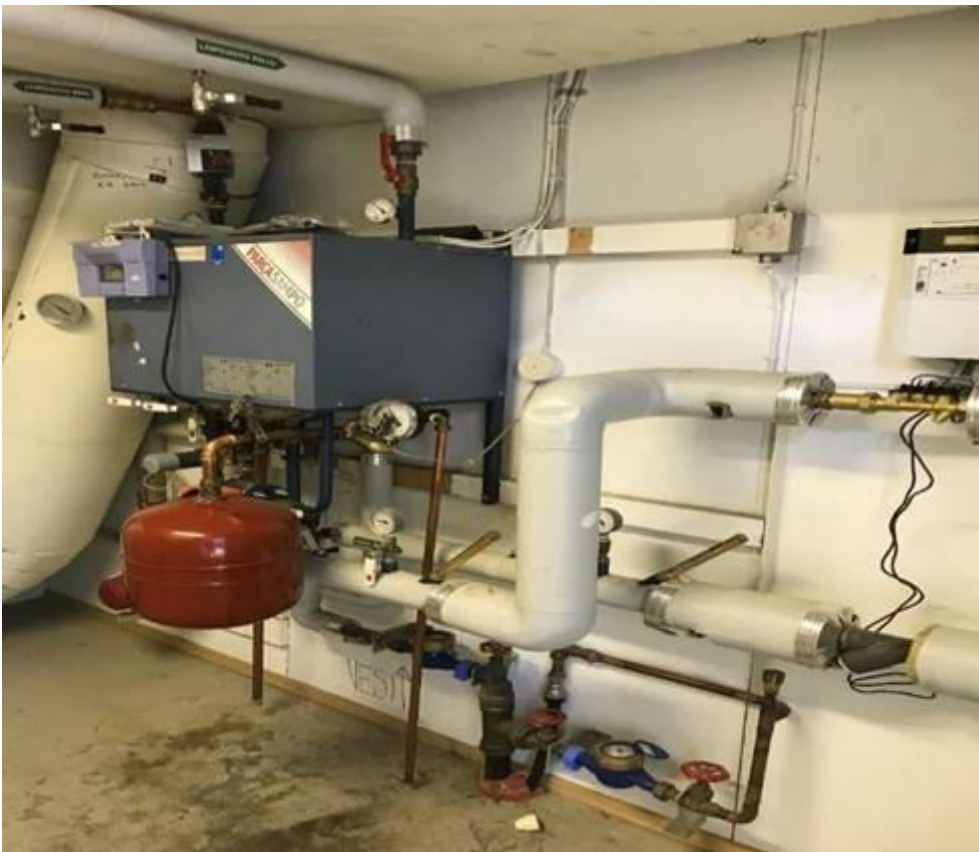
Kuva 6.2. Teknisessä tilassa oleva lämmönvaihdinpaketti.
