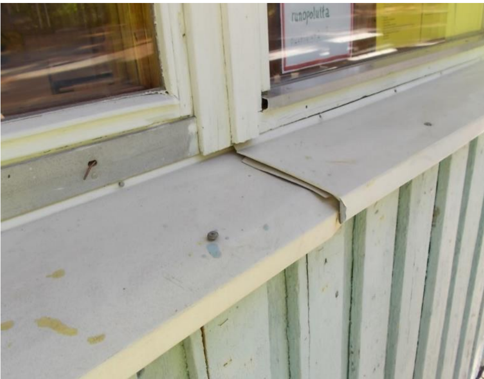
Kuva 4.3. Ikkunoiden vesipeltien jatkokset ovat auki ja kaadot ovat loivat.
