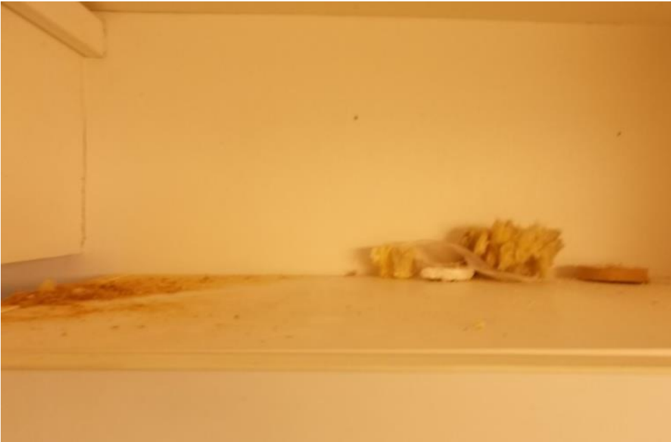
Kuva 4.6. Suttuhuone 17 ilmalämpöpumpun asennuksen roskat ovat siivoamatta.
