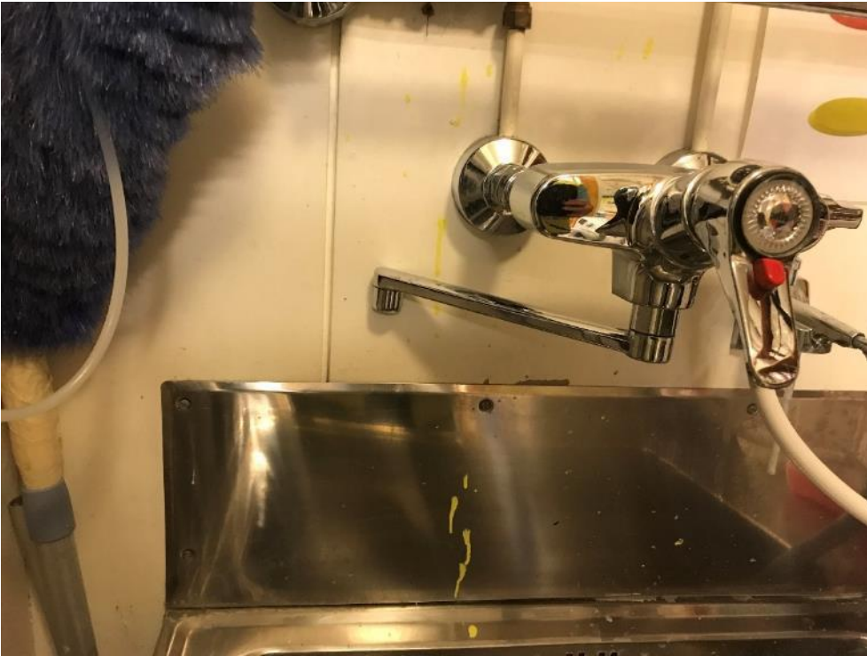
Kuva 5.5. Allashanan sivuliikerajoitin puuttuu.
