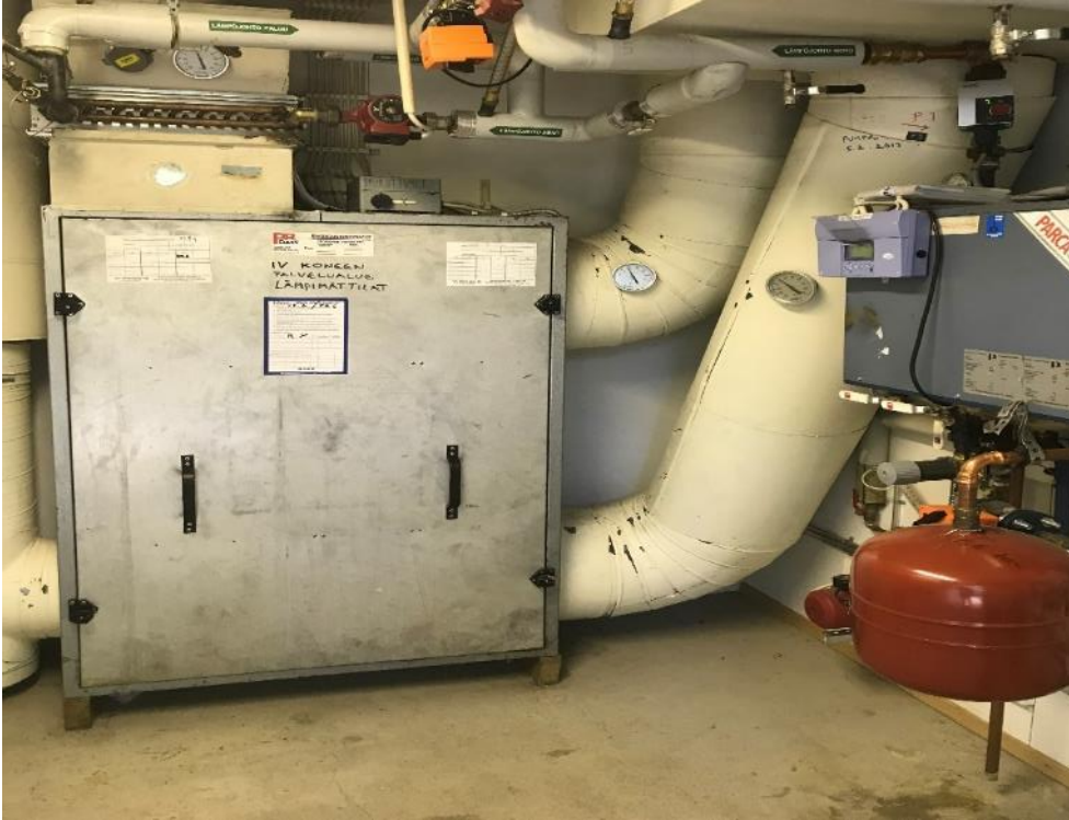
Kuva 5.1 Ilmanvaihtokoneesta puuttuu vedenpoistoviemäröinti.
