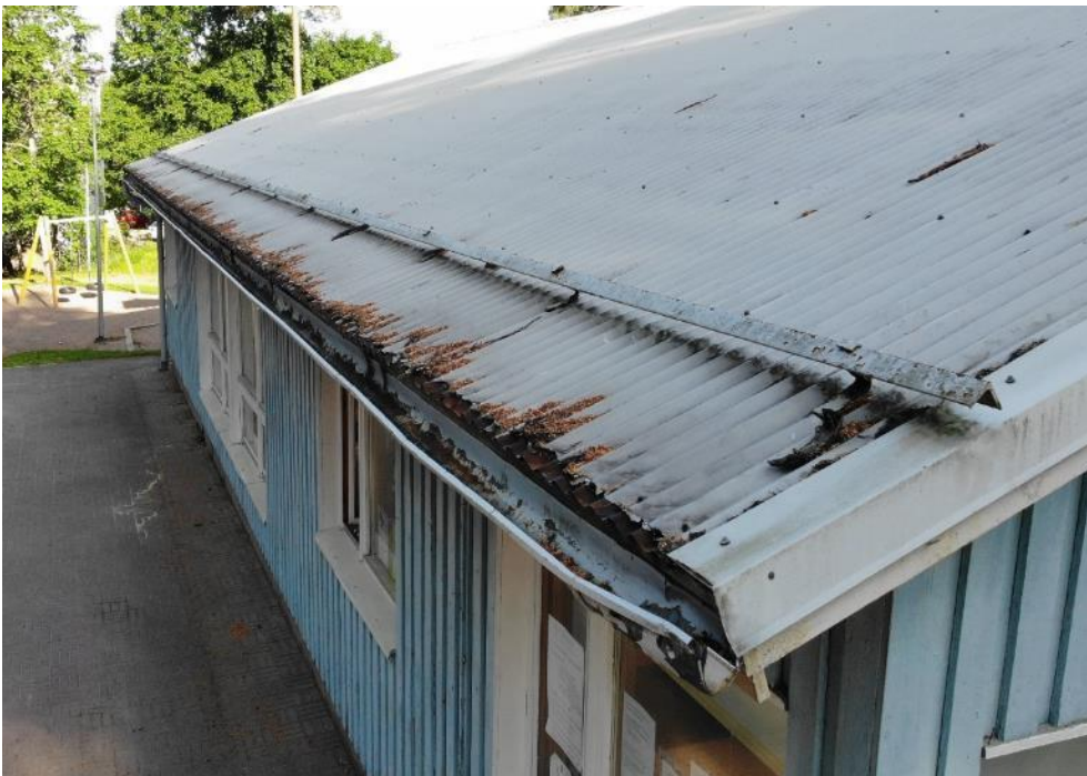
Kuva 4.1. Kattopellit ovat osin ruosteessa ja sadevesikouru on vaurioitunut sekä kourussa on roskaa.
