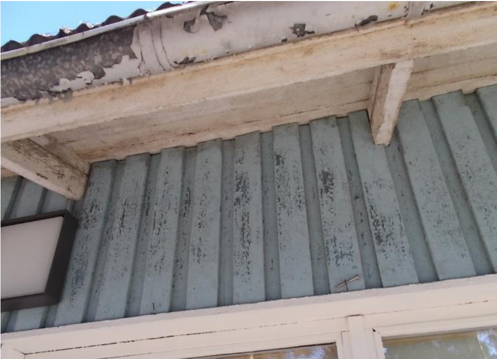
Kuva 4.2. Julkisivut ja vesikourut ovat maalauksen tarpeessa.
