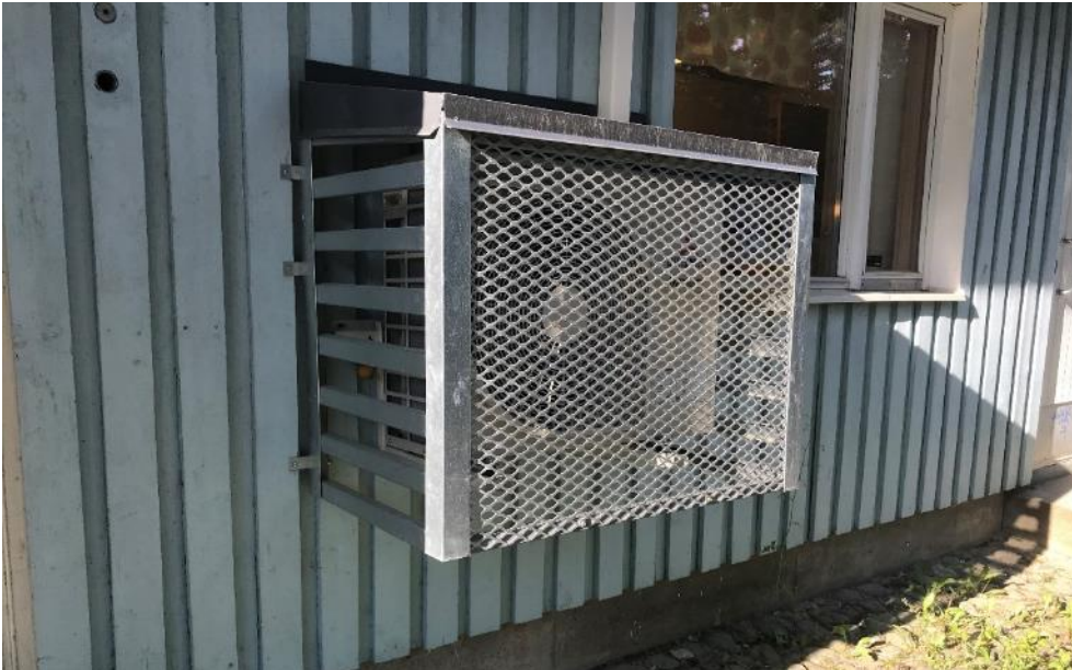
Kuva 5.9. Ilmalämpöpumpun ulkoyksikkö ilkivaltasuojan sisällä.
