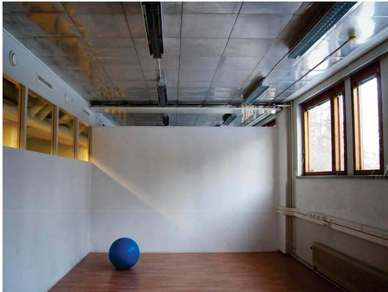
Huone 106b: mosaiikkibetonin päälle on asennettu laminaattilattia.
