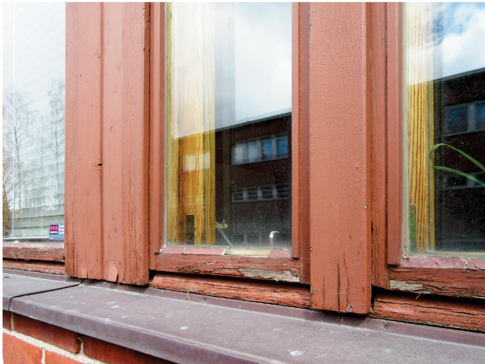
Ikkunoiden ulkopuutteet ovat kunnostuksen tarpeessa erityisesti läntisellä julkisivulla, jossa aurinko ja säävaihtelut ovat selkeästi kuluttaneet puuosia.
