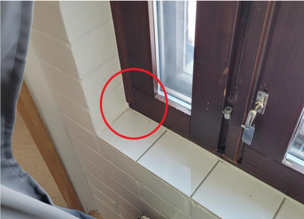
Kuva 4.5. Lepohuoneen 160 ikkunanurkassa on ilmavuotoa.
