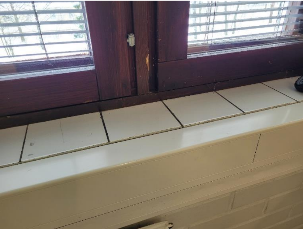
Kuva 4.3. Tilan 128 ikkunoissa on ilmavuotoa.
