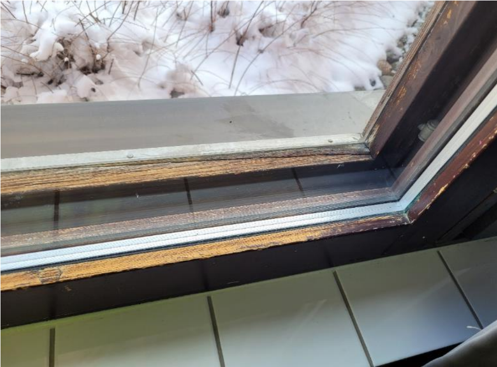
Kuva 4.1. Päiväkodin 1.kerroksen Lepohuoneen 156 ikkunan ulkopuitteen alareuna on halki.
