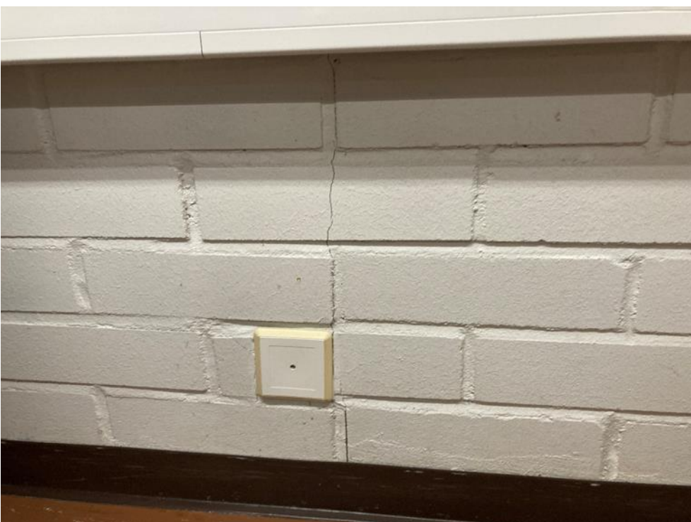
Kuva 4.2. Ryhmätilan 128 ulkotiliseinässä on halkeama.
