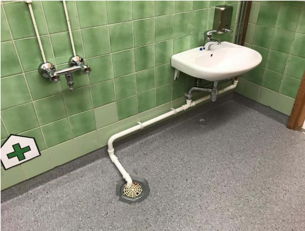
Kuva 5.2. Huoneen 174 vesihana on tulpattu ja lattiakaivon täytöstä on huolehdittava.
