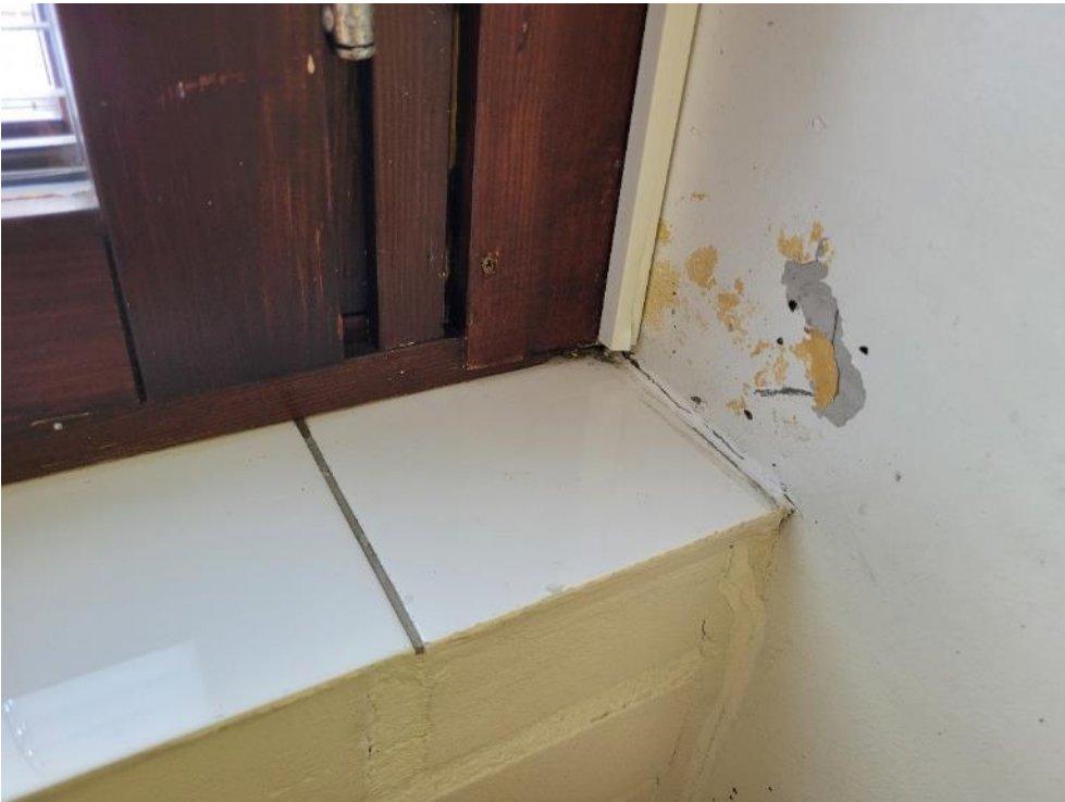
Kuva 4.4. Tilan 129 ikkunanurkassa on ilmavuotoa.
