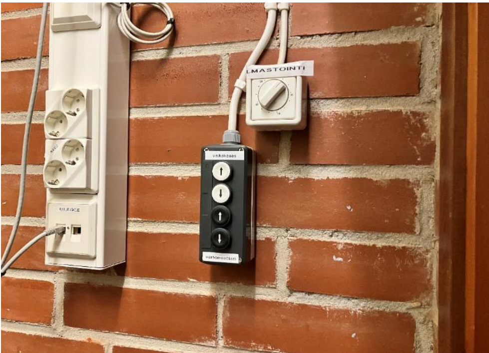
Kuva. 5.3. Liikuntasalin ilmanvaihdon ohjauskytkin.
