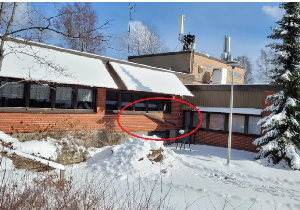
Kuva 4.6. Sisäpihalla ikkunapeltiä on irti.
