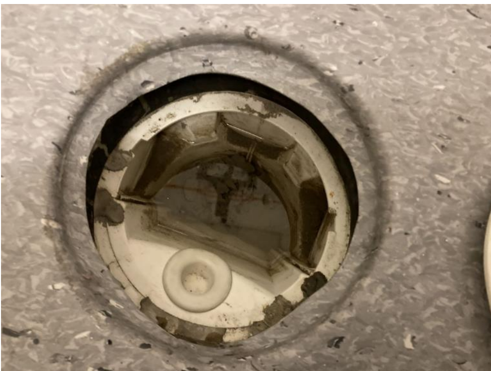
Kuva 5.1. Tilan 187 lattiakaivo on tukossa.
