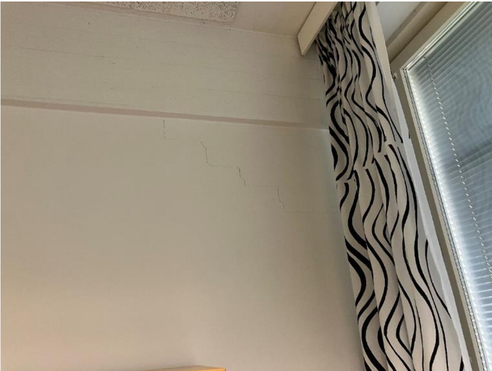
Kuva 4.10. Tilan 225 tiiliväliseinässä on halkeama.
