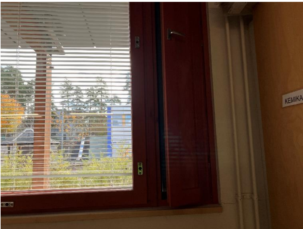
Kuva 4.29. Tilassa 184 tuuletusikkunan lukitusmekanismi on jumissa.
