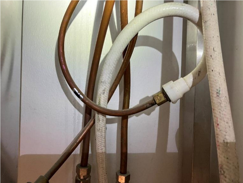
Kuva 4.23. Tilassa 115 on vuotava käsisuihkuliitos.
