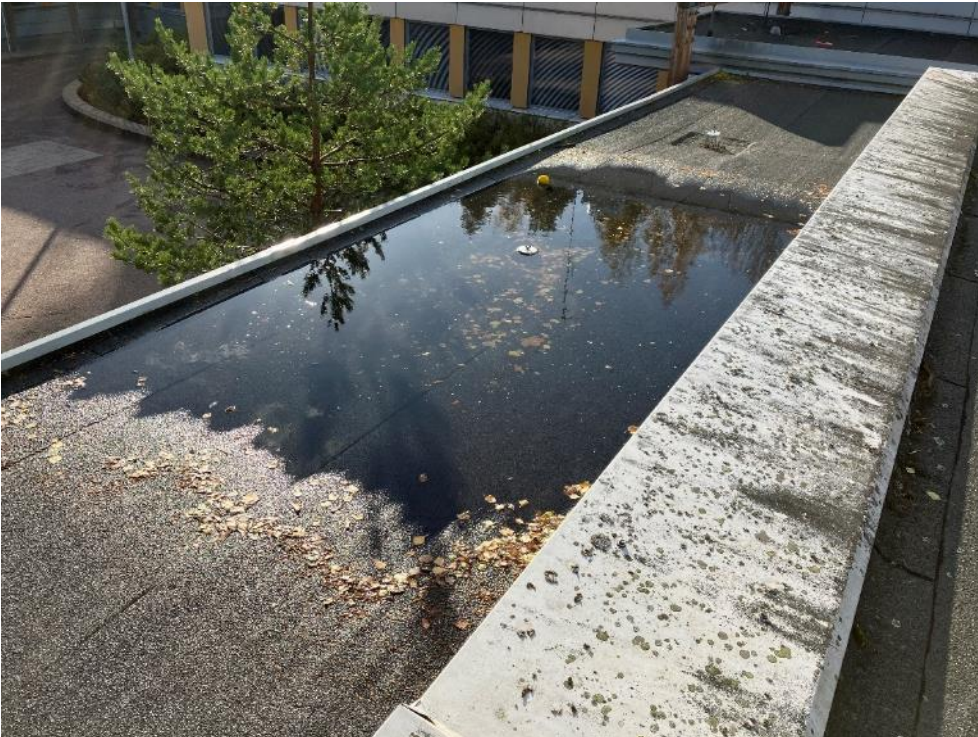
Kuva 4.37. Vesikatolla on lammikoitumista, koska kattokaivoja on tukossa.
