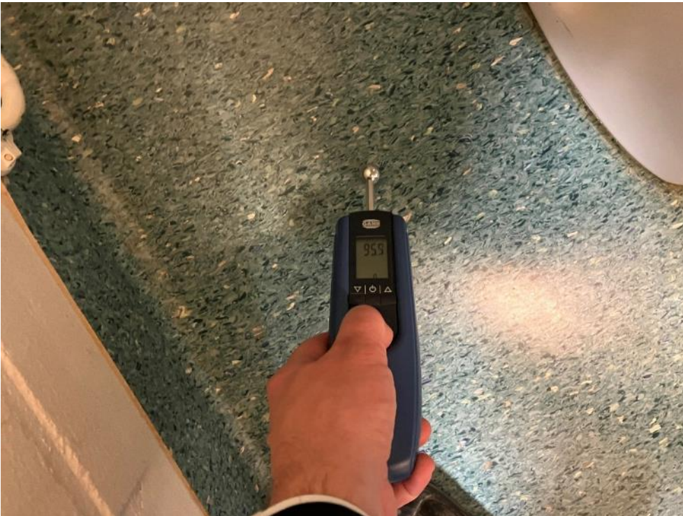
Kuva 4.46. Hopsulan tilassa 110 havaittiin pintakosteudenosoittimella kohonneita arvoja.
