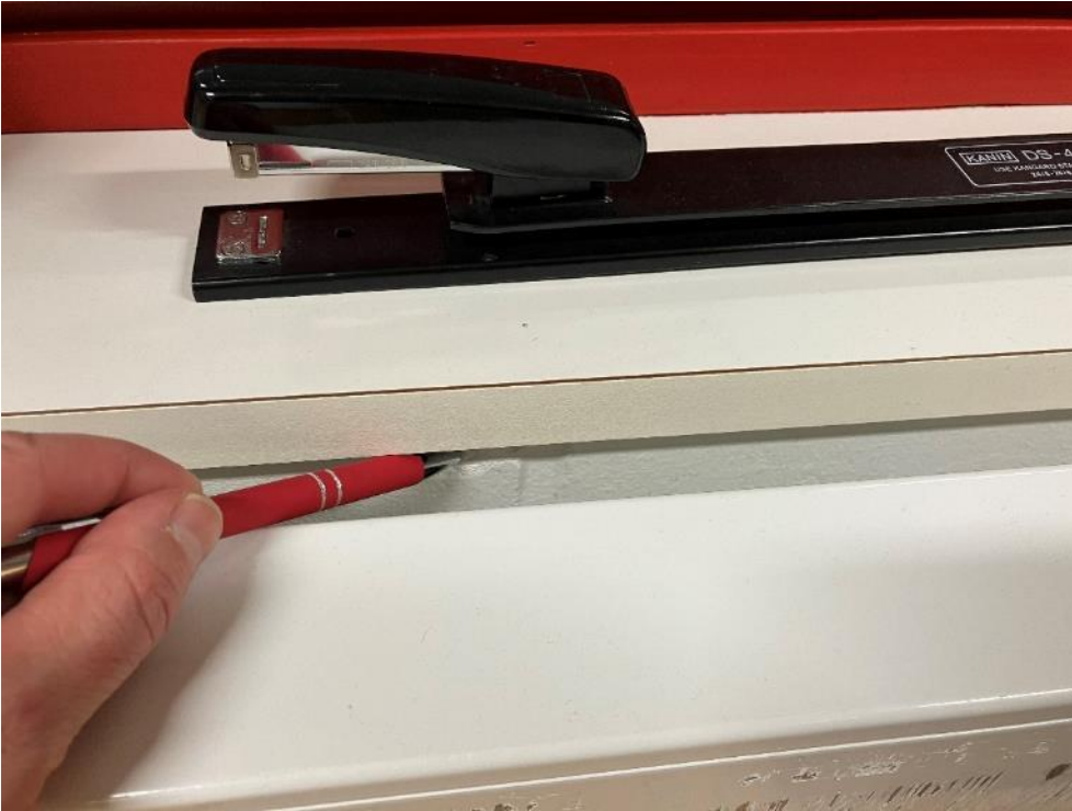
Kuva 4.43. Hopsulan tilassa 114 ikkunapenkin ja ulkoseinän liitos on epätiivis.
