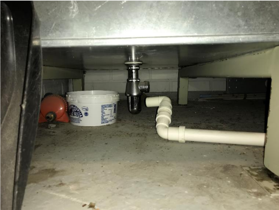
Kuva 5.12. Hopsula ilmanvaihtokoneen raitisilmakammion viemäröinti on irronnut.
