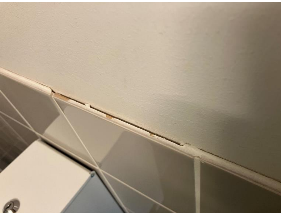
Kuva 4.2. Tilassa 250 seinälaattojen kiinnityssauma on avoimena.
