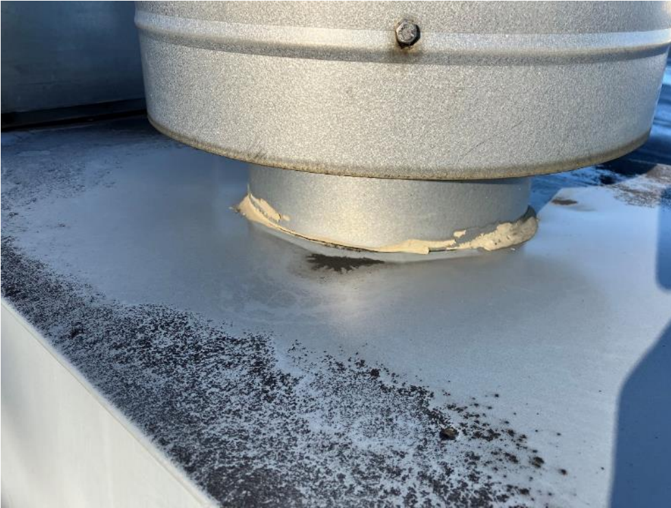
Kuva 4.39. Vesikaton kattohajottajien juurien saumaukset ovat epätiiviiit.
