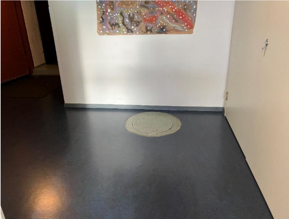
Kuva 4.27. Tilassa 128 on tiivistämätön kansi ja sitä kautta on ilmayhteys alapohjaan.
