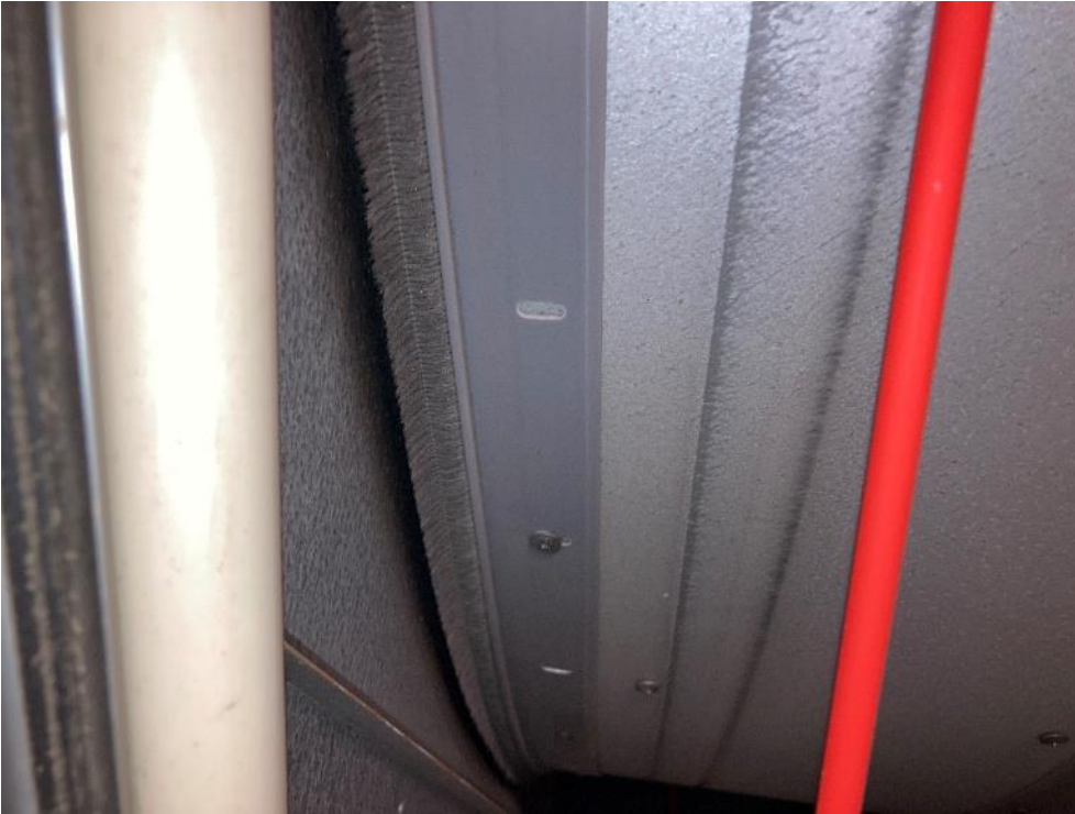
Kuva 5.4. TK1/PK1 lämmöntalteenotossa on ohivirtausta.
