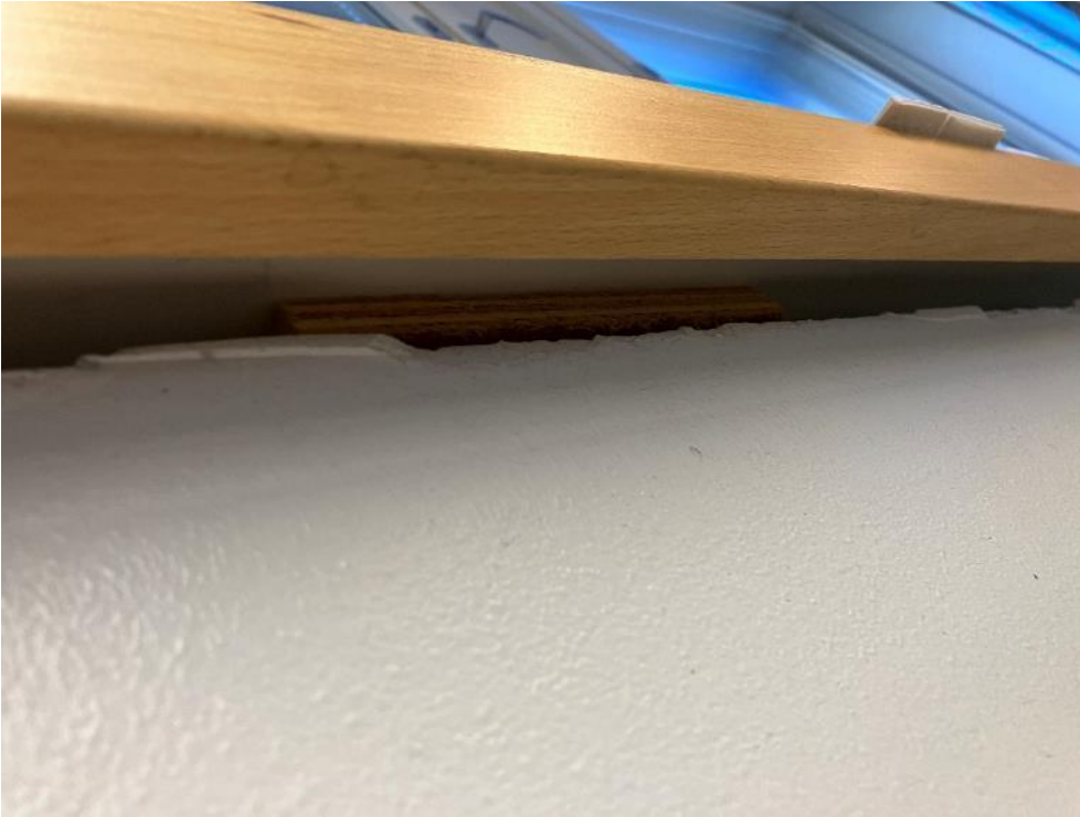
Kuva 4.13. Tilassa 207 ikkunapenkin alapuoli on tiivistämättä ja sitä kautta on todennäköinen ilmayhteys ulkoseinän eristekerrokseen.
