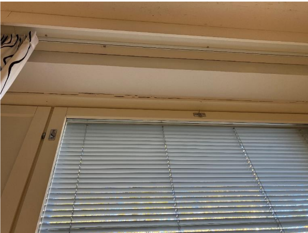
Kuva 4.12. Tilassa 223 ikkunakarmin sisäpuolinen tiivistys on auennut.
