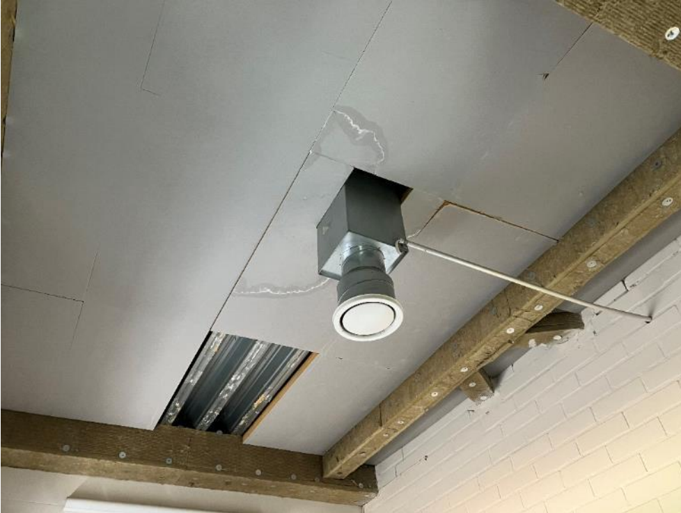
Kuva 4.32. Tilassa PR3 on runsaasti avoimia villapintoja. Lisäksi kattolevyissä on kosteusjälkiä.
