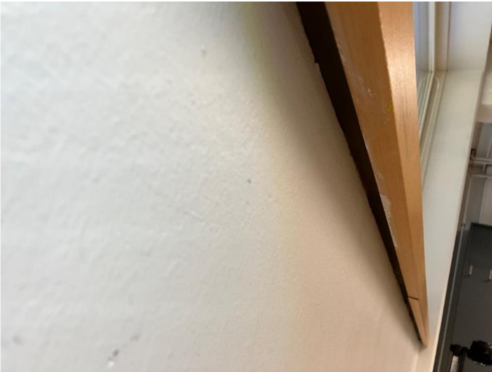
Kuva 4.22. Tilassa 115 ikkunapenkin alapuoli on tiivistämättä ja sitä kautta on todennäköinen ilmayhteys ulkoseinän eristekerrokseen.
