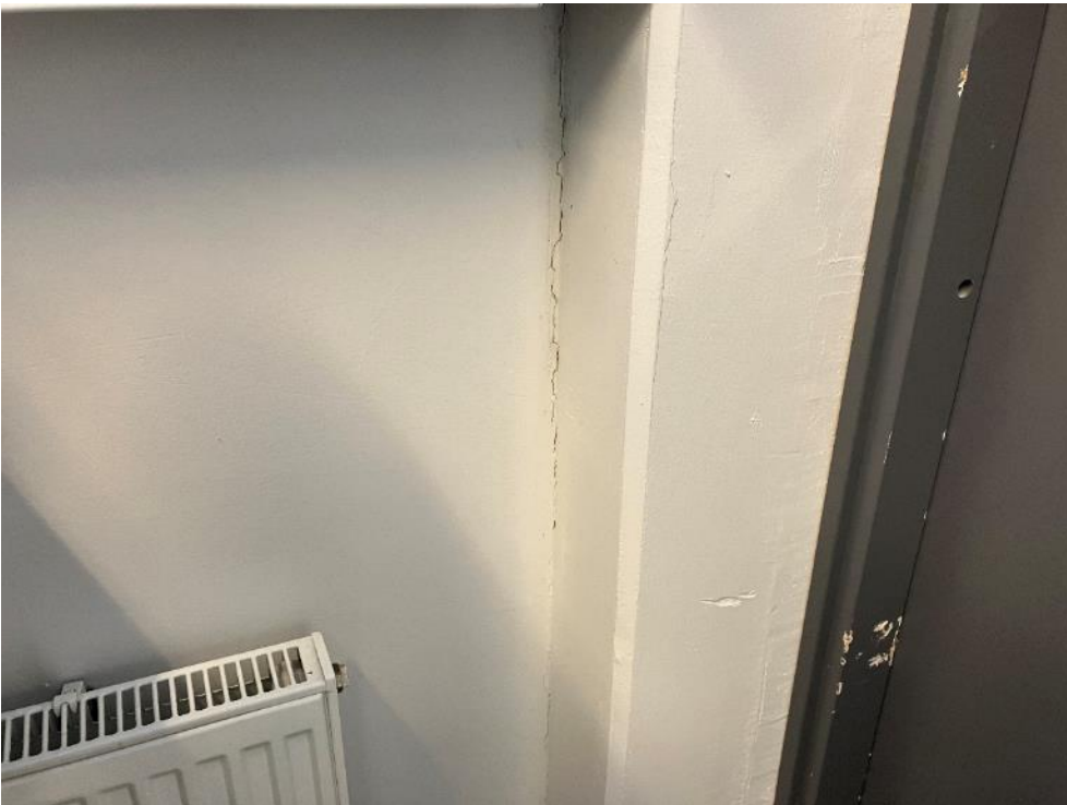
Kuva 4.18. Tilassa 220 pilarin ja ulkoseinän liitoskohdassa on halkeama.
