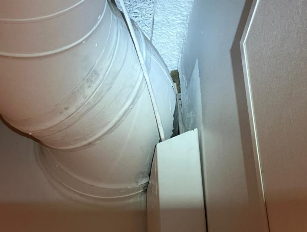
Kuva 4.9. Tilassa 226 on pinnaltaan sulkemattomia tiivistevilloja.
