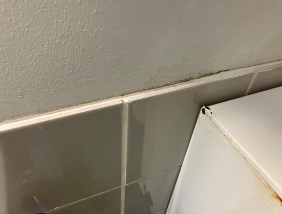
Kuva 4.1. Tilassa 249 seinälaattojen kiinnityssauma on avoimena.
