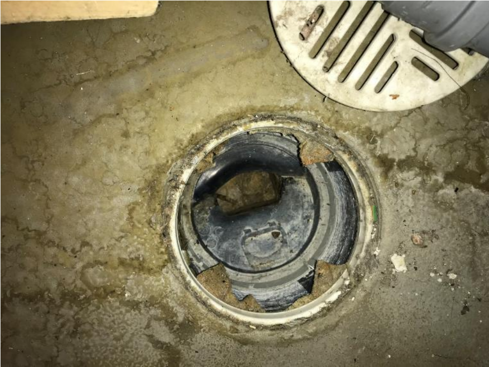
Kuva 5.2. A-osan ilmanvaihtokonehuoneen lattiakaivo on kuivunut.
