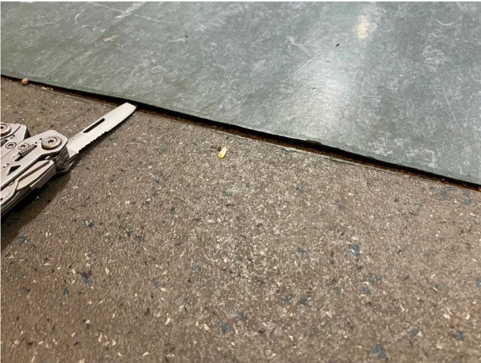
Kuva 4.6. Lattian muovimatto on irti alustasta tilaan 233 johtavan oven edustalla.
