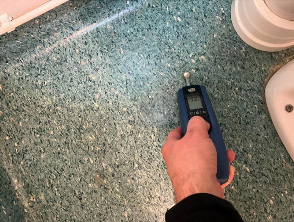
Kuva 4.45. Hopsulan tilassa 105 havaittiin pintakosteudenosoittimella kohonneita arvoja.
