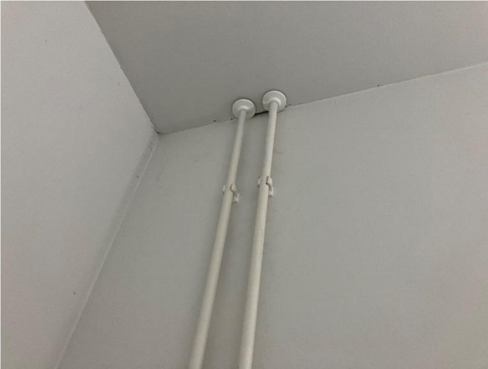
Kuva 4.5. Tilassa 253 on epätiivis katon ja seinän liittymä.
