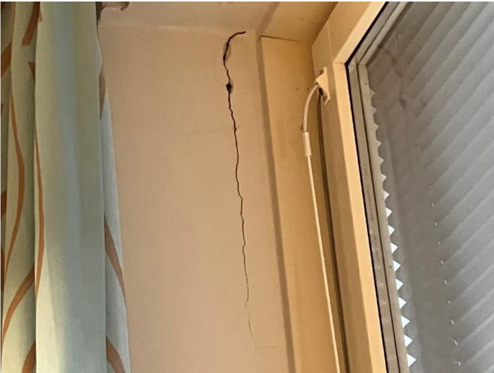
Kuva 4.4. Tilan 247 ulkoseinäpilarissa on halkeama.
