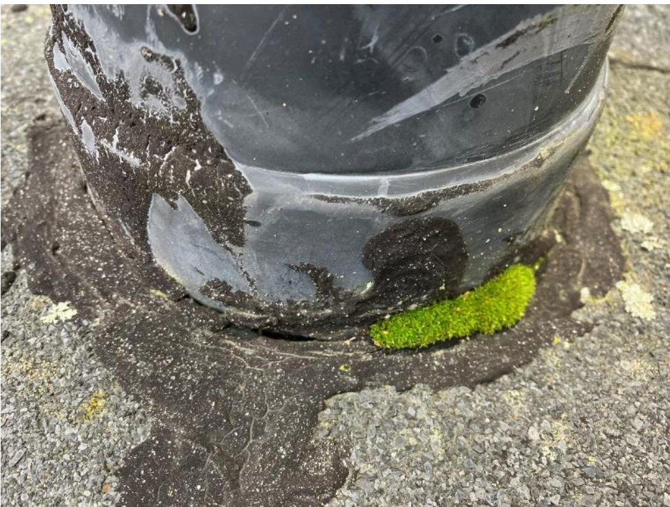
Kuva 4.38. Vesikaton läpivientien tiivistyksissä on puutteita.
