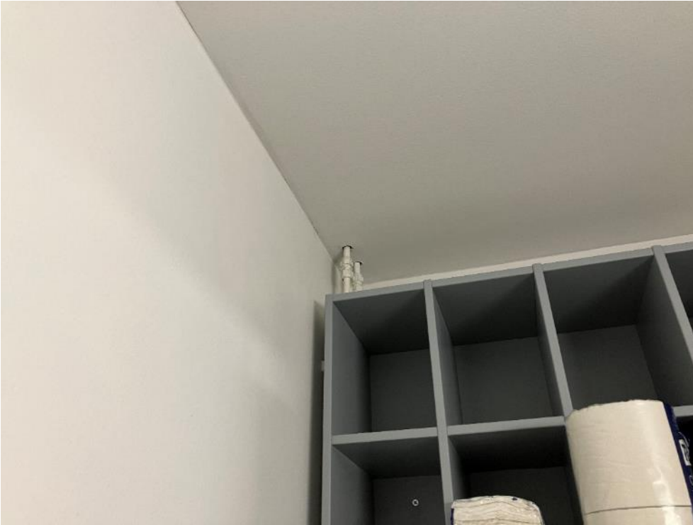
Kuva 4.17. Tilassa 214 on tiivistämättömiä läpivientejä.
