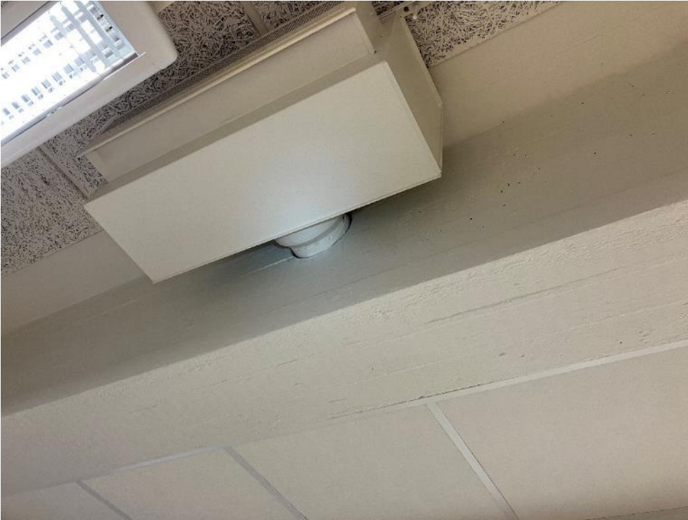
Kuva 4.41. Hopsulassa tilan 126 tuloilmakanavien läpiviennit ovat tiivistämättä.
