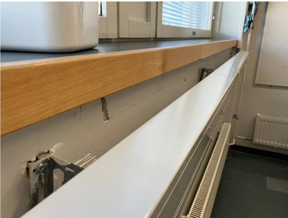
Kuva 4.26. Tilassa 111 kaapelikotelo on irti ja putoamaisillaan. Lisäksi ulkoseinässä on halkeamia.
