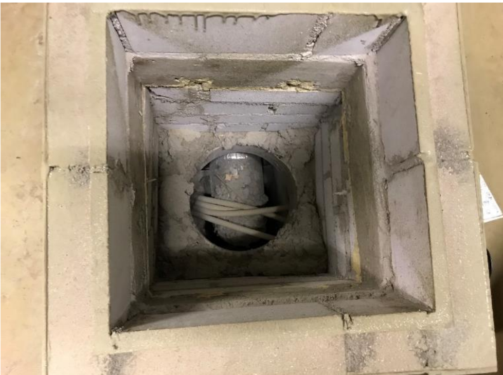
Kuva 5.1. A-osan ilmanvaihtokonehuoneen lattiassa on epämääräinen läpivienti.
