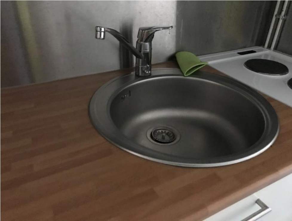
Kuva 5.8. Ruokalan linjaston takana olevassa allashanassa on väärä sivuliikerajoitin ja vesi pääsee pöydälle.
