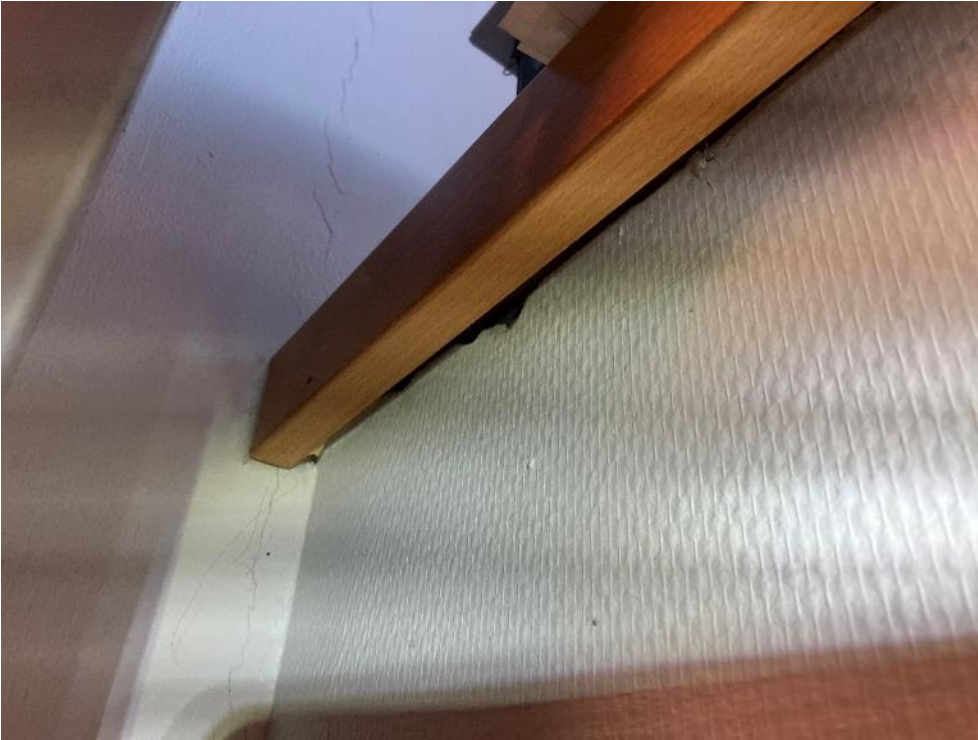
Kuva 4.7. Tilassa 242 ikkunapenkin alapuoli on tiivistämättä ja sitä kautta on todennäköinen ilmayhteys ulkoseinän eristekerrokseen.
