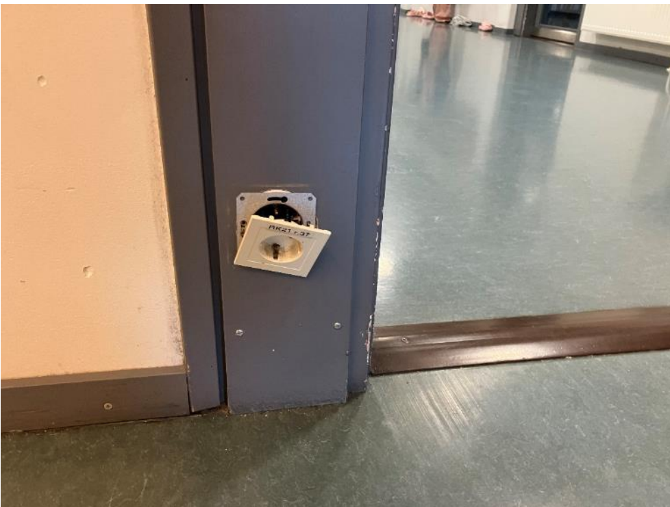
Kuva 4.14. Tilassa 206 on viallinen pistorasia.
