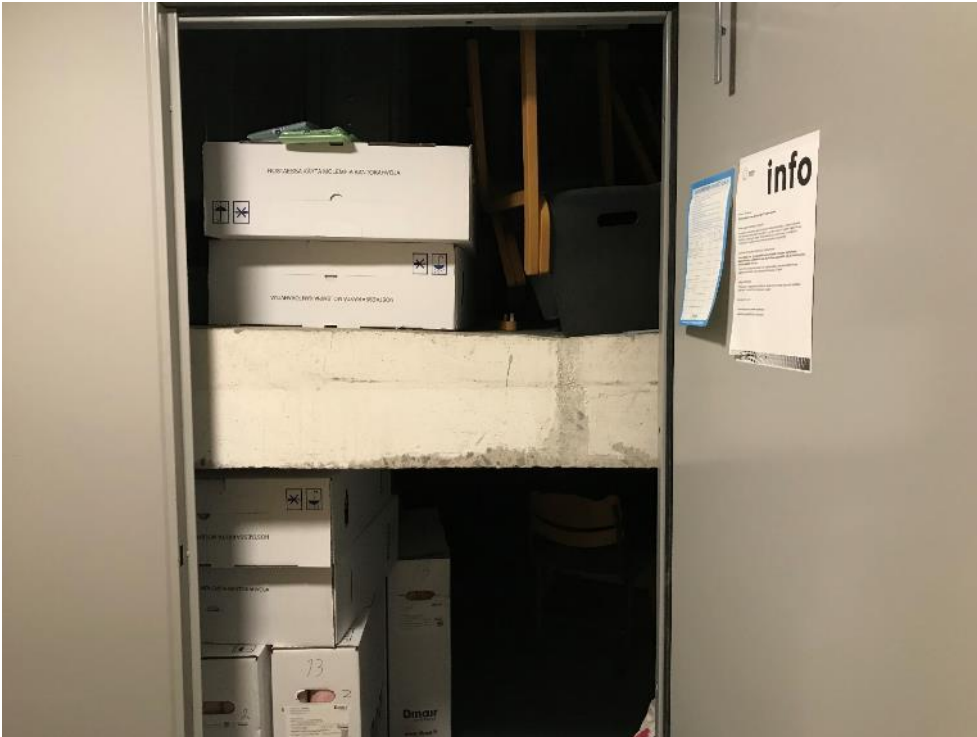
Kuva 5.10. Teknisentyön luokan ilmanvaihtokonehuoneessa B126 on betoninen välipohja.
