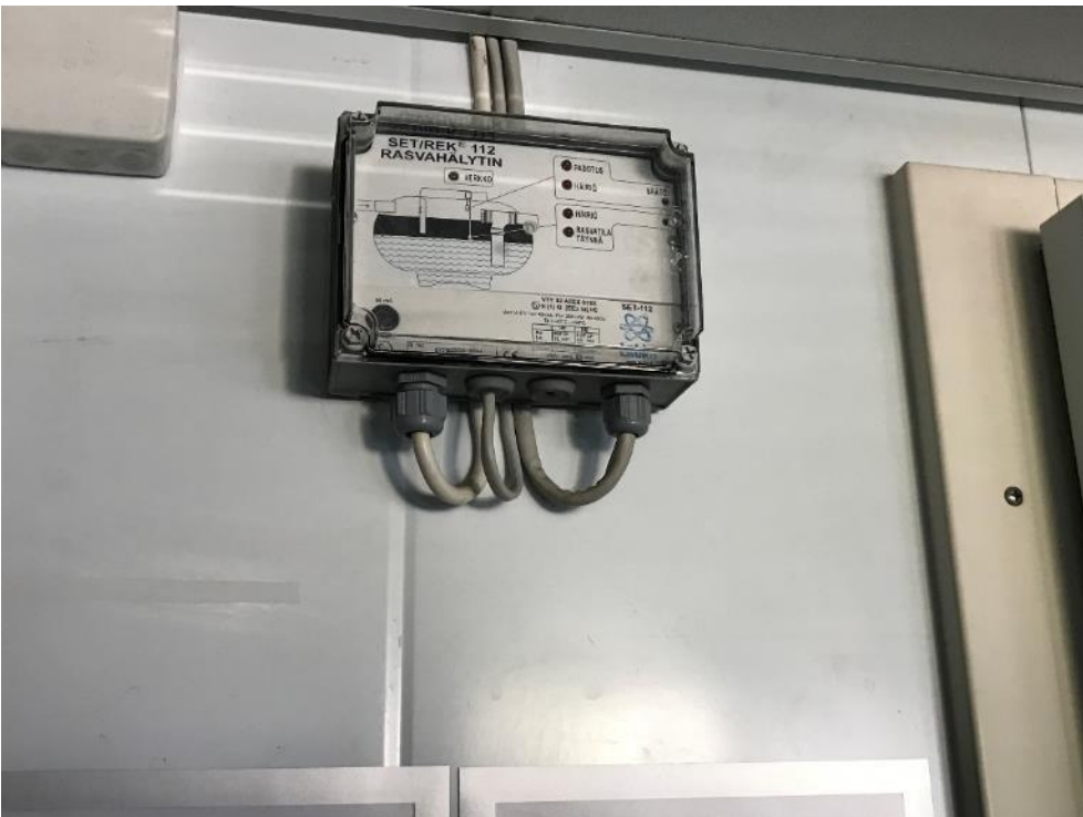
Kuva 5.7. Rasvanerotuskaivon ohjauspaneelissa ei ole virta päällä.
