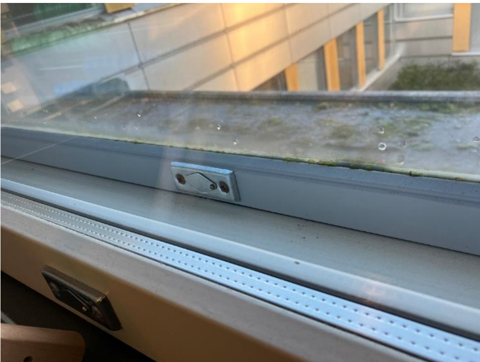
Kuva 4.8. Tilassa 242 ulomman ikkunanlasin alalaidassa on vihreää kasvustoa. Ikkunan ulkolasi huurtunut sisäpuolelta.
