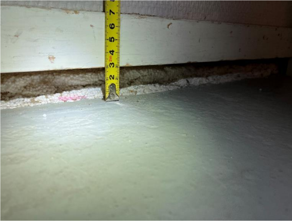
Kuva 4.30. Tilassa 184 ulkoseinän ja lattian välinen liitos avoin.
