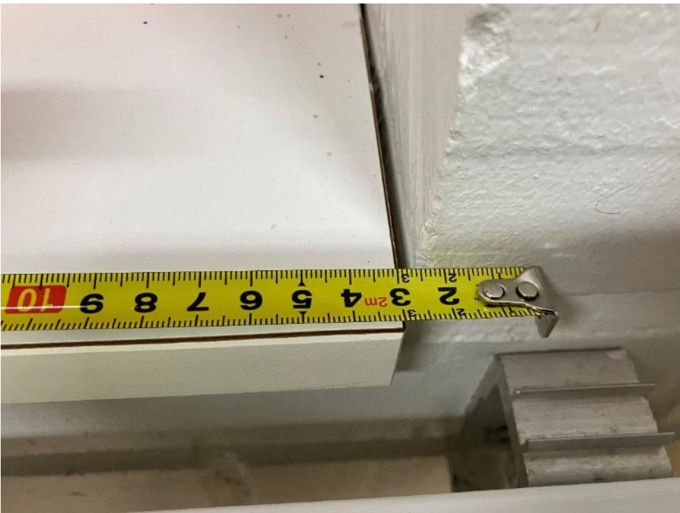
Kuva 4.44. Hopsulan tilassa 121 ikkunapenkin ja ulkoseinän liittymä on tiivistämättä.
