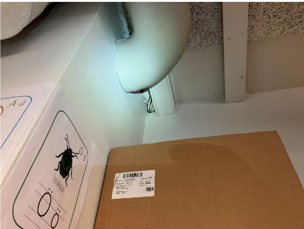
Kuva 4.16. Tilassa 204 on tiivistämättömiä läpivientejä.
