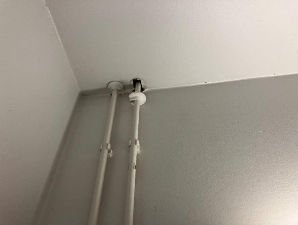
Kuva 4.3. Tilassa 250 on tiivistämättömiä katon läpivientejä.
