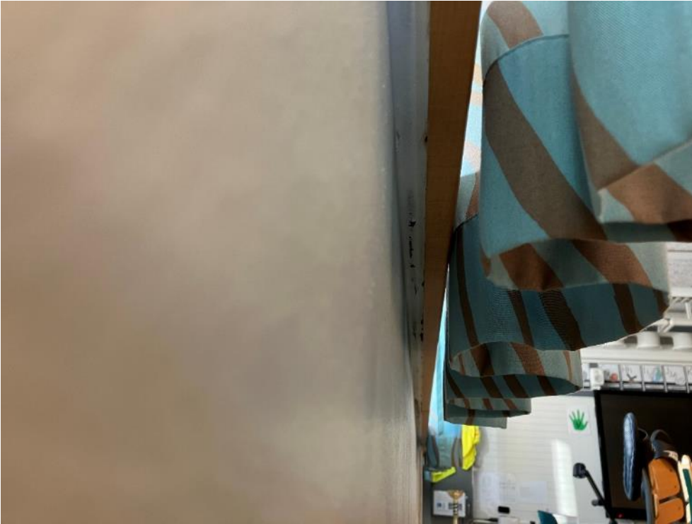
Kuva 4.15. Tilassa 202 ikkunapenkin tiivistys on puutteellinen. Saumanauha paistaa kitin alta ja sitä kautta on mahdollinen ilmayhteys ulkoseinän eristekerrokseen.
