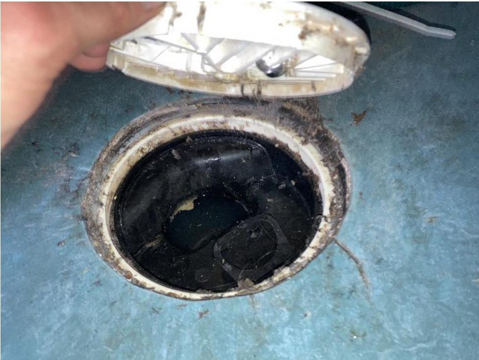
Kuva 5.5. Ruokalan linjaston lattiakaivoista pääsee tilaan viemärihajua, koska vesilukko-osa ei ole tiivis ja kunnolla paikallaan.
