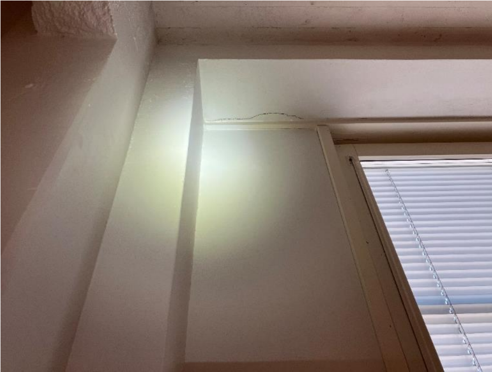
Kuva 4.19. Tilan 232 ulkoseinässä on halkeama ja ikkunakarmista irtoilee maalia.
