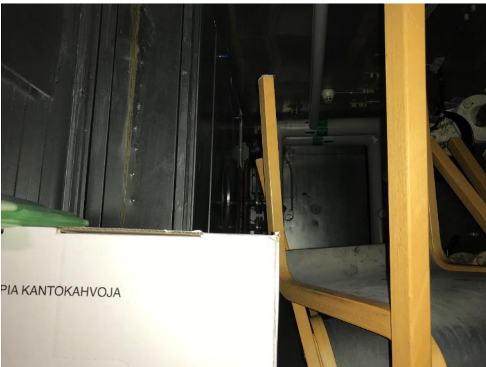
Kuva 5.11. Teknisentyön luokan ilmanvaihtokonehuoneessa B126 varastoidaan tuoleja ja muuta materiaalia, mitkä estävät koneen huoltoa.
