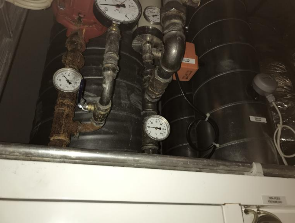
Kuva 5.6. TK4 lämmin kiertovesipumppu vuotaa ja putkisto on osin ruosteessa.
