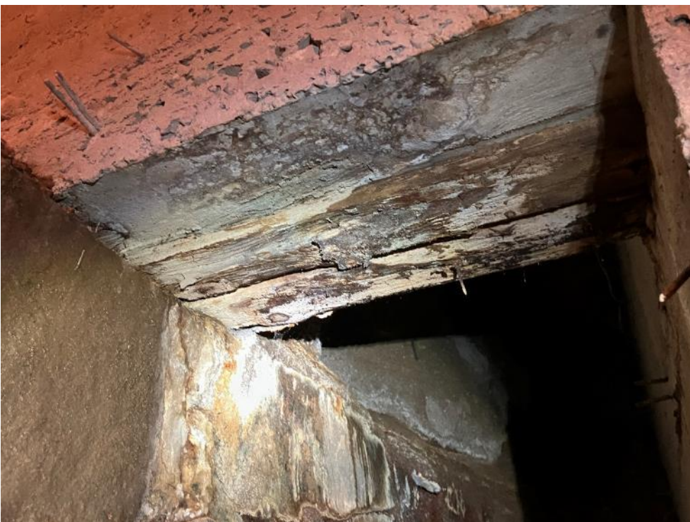
Kuva 4.34. A-osan alustatilassa (tilan 129 viereinen tila) on mikrobivaurioitunutta puuta.
