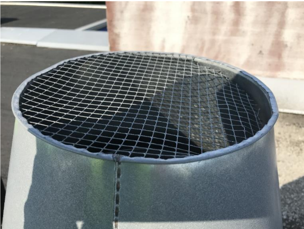
Kuva 5.3. Kattohajottimien verkko on osin irti.
