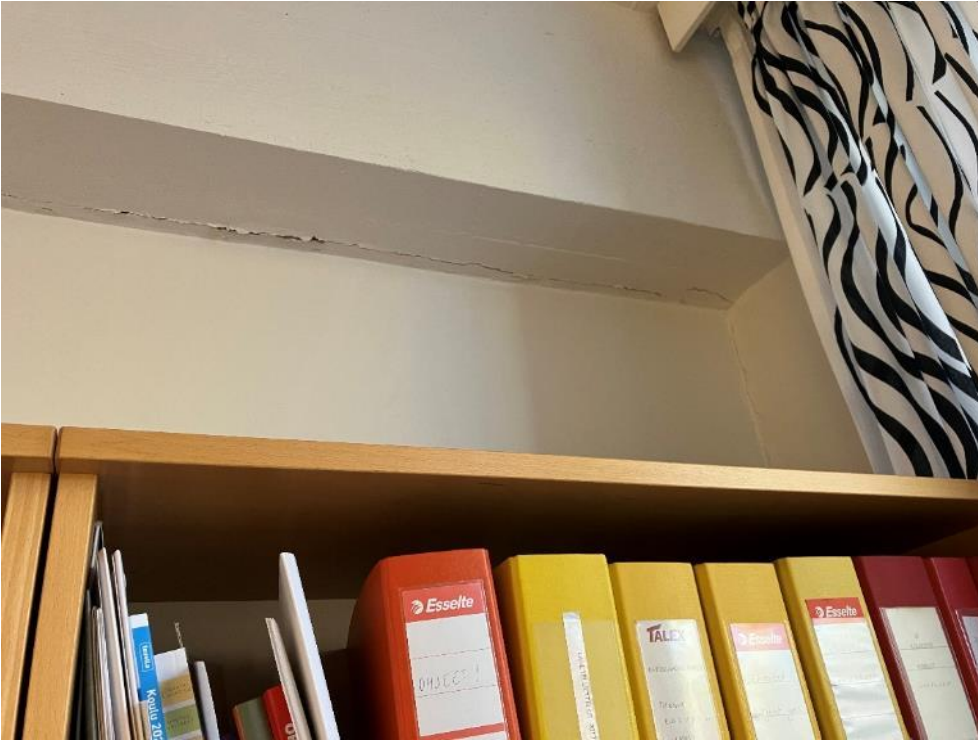
Kuva 4.11. Tilan 224 palkissa on halkeama ja irtoavaa maalia.
