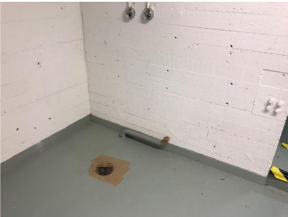
Kuva 5.9. Väestösuojuksissa on lattiakaivoja, joiden täyttäminen on työlästä tulpattujen vesipisteiden takia.
