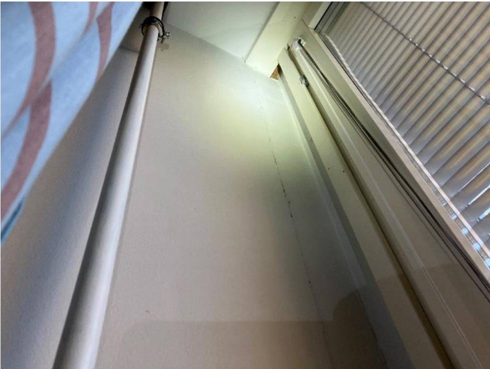
Kuva 4.24. Tilassa 114 on halkeama ulkoseinäpilarissa ja paljaita villapintoja.
