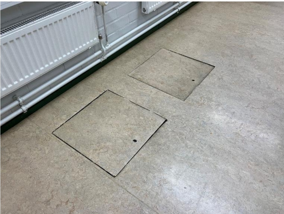
Kuva 4.40. Hopsulassa tilan 126 lattian tarkastusluukut ovat tiivistämättä. Vanhan raportin mukaan ovat käyttiluukkuja koulun puoleisen reunan putkikuiluun.
