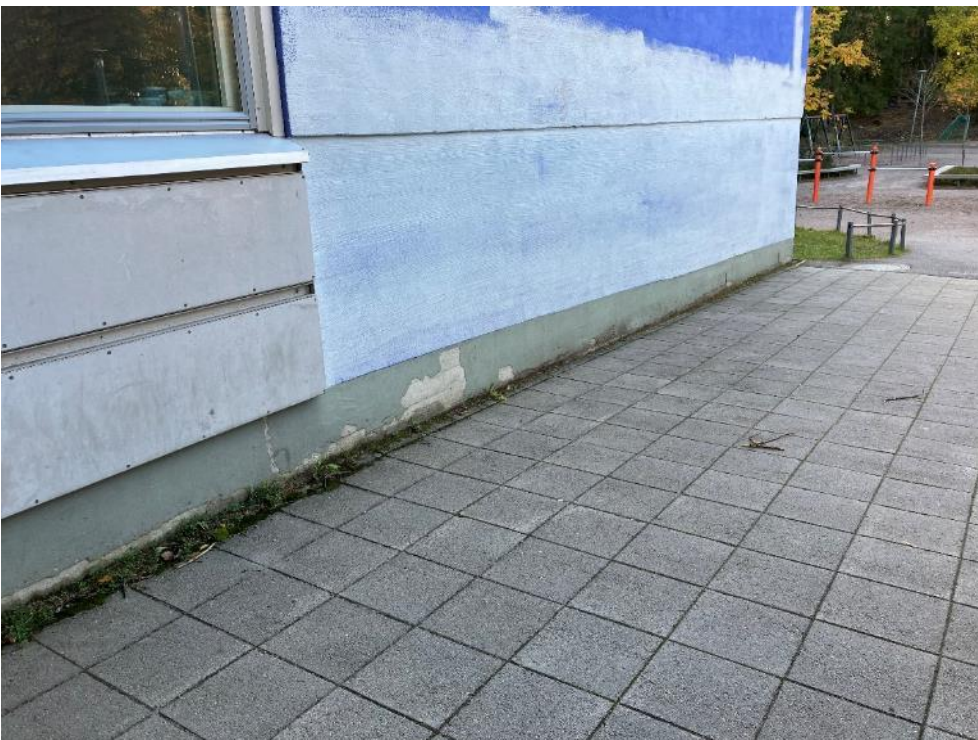
Kuva 4.36. Sokkelin pinnoite irtoilee takapihan sisäänkäynnin vieressä.
