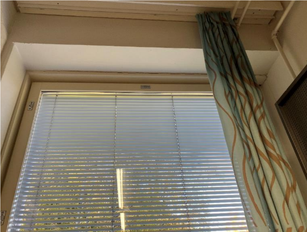
Kuva 4.25. Tilassa 113 ikkunakarmin sisäpuolinen tiivistys on auennut.
