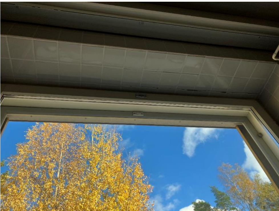
Kuva 4.31. Tilan 117 ikkunasyvennyksessä on avoimia laattasaumoja.
