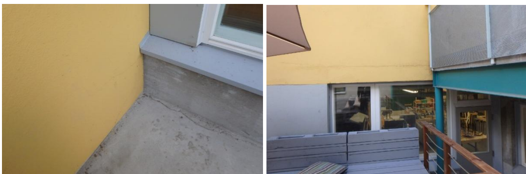
Kuva 19. Laajennusosan parvekelaatta on kiinni vanhan osan ulkoseinässä ja vanhan osan siporex ulkoseinään on syntynyt halkeamia.
