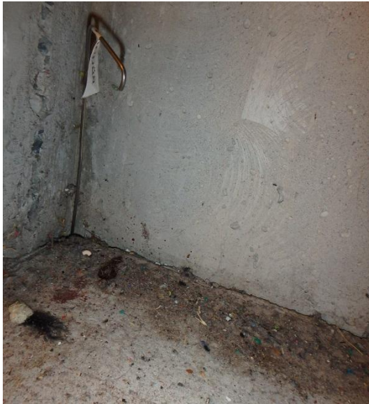
Kuva 11. Nostettavan näyttämön alapuolella seinän ja alapohjan väliset saumat ovat auki, eikä saumassa ole radontiivistyskermiä.
