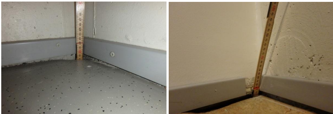
Kuva 7. Porrashuoneen 157 ja Luokan 166, nurkassa alapohjalaatta ja ulkoseinän raosta mitta uppoaa 200-600 mm alapohjaan. Ko. kohdista puuttuu radontiivistyskermi.
