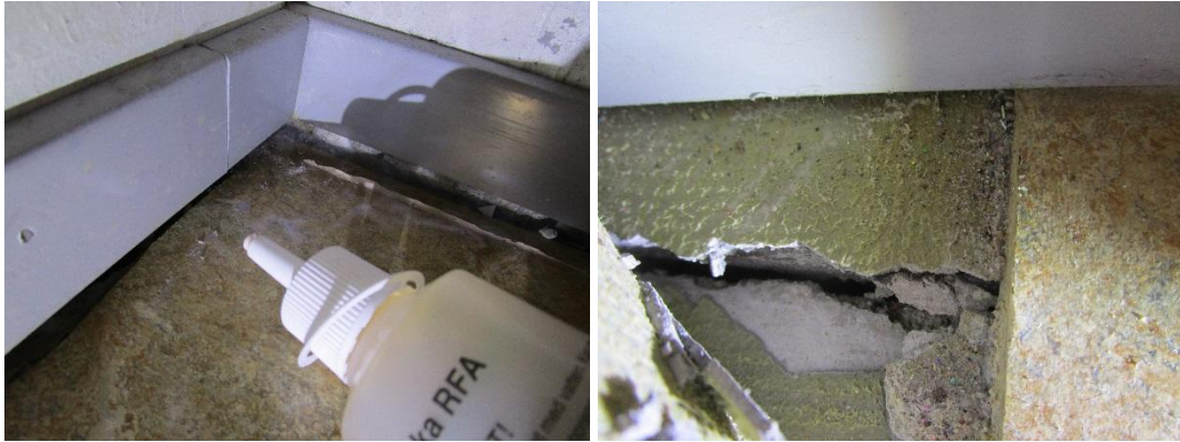
Kuva 5. Luokan 166 pohjoispäässä alapohjarakenne oli painunut ja linoleum-maton alla oli halkeama. Lattia-seinäliitoksesta ja lattian halkeamasta tuli viileää ilmaa sisäänpäin.
