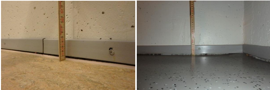
Kuva 8. Luokka 165 ja voimistelusalin viereinen porrashuone. Alapohja on painunut/kutistunut siten että jalkalistat ovat noin 10 mm ilmassa.
