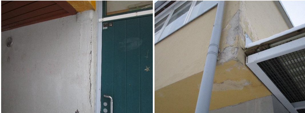
Kuva 17. Ulkoseinärakenteessa matalan ja korkean osan liittymässä kosteusvaurion alapuolella on halkeama. Rakennuksen eteläpäädyssä seinärappaus on halkeillut katoksesta tulleen kosteusrasituksen vaikutuksesta.
