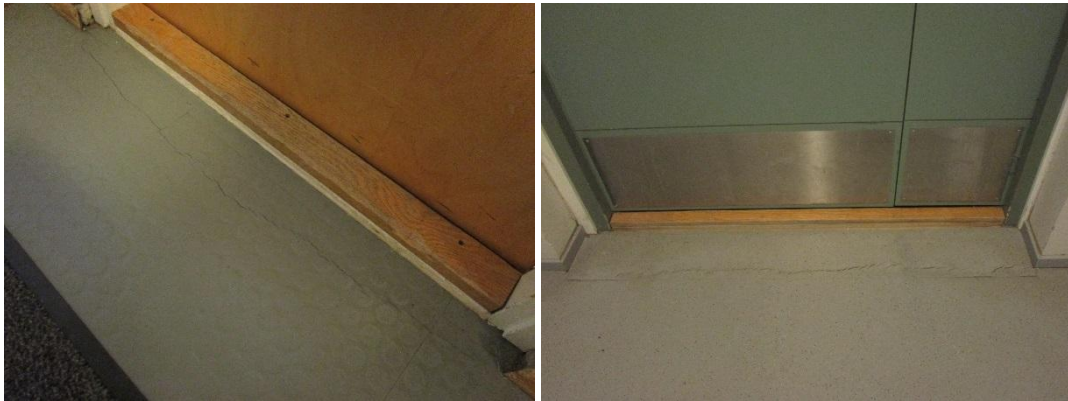
Kuva 6. Luokan 143 eteistilassa ja porrashuoneessa 157 alapohjarakenteen (AP1) kumimatto oli haljennut ovien edustoilta.
