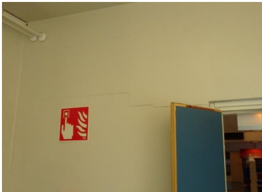
Kuva 12. Porrashuoneen 157 tiilimuuratussa väliseinässä on oviaukon karmikiinnityksestä alkava porrasteinen halkeama.
