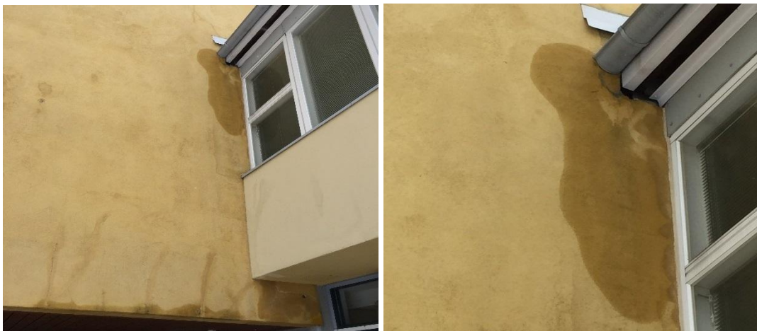
Kuva 16. Rakennuksen lännen puoleisella sivulla matalan ja korkean osan liittymässä sadevesikourusta on todennäköisesti lumien sulaessa valunut vettä julkisivulle.
