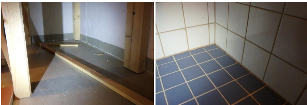
Kuva 10. Väestönsuojan viereinen varasto ja kellarin siivouskomero. Alapohjalaatan painuma/kutistuminen on nostanut varastohyllyn jalat ilmaan. Laatoituksen silikonisauma on revennyt.
