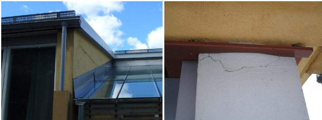
Kuva 18. Luokka 249 ulkoseinärakenteen ja länsipuolella pääsisäänkäynnin pilarin yläosassa oli halkeamia.
