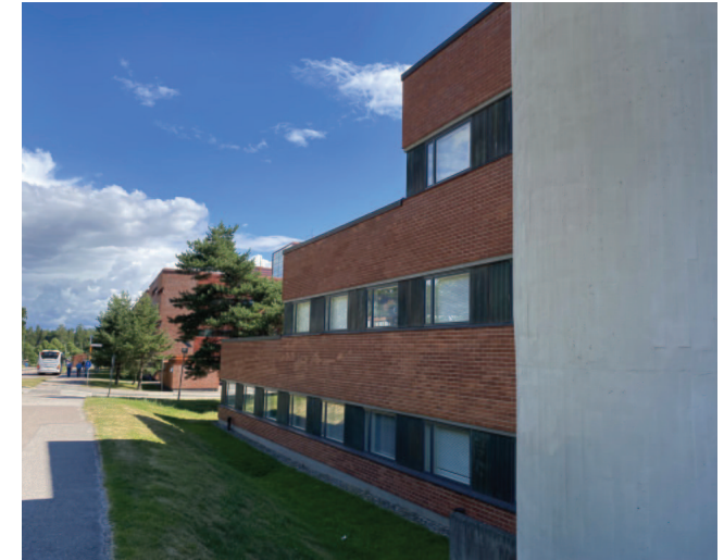
Koillispuolen julkisivun porrastus, jolla on saatu valoa 2. ja 3. kerroksen toimisto- ja laboratoriotiloihin. Oikealla betoninen porrashuoneen seinä.
