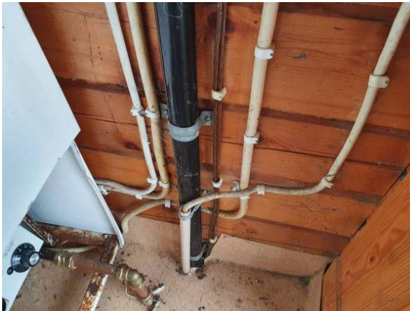
198. Saunarakennuksen nousujohto ja maadoitusjohtimet.
