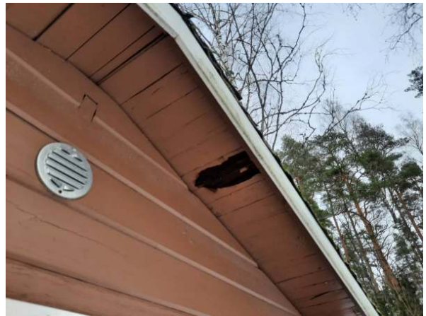
74. Mökit 13-18 osin ulkoseinien osalta osin kuluneita. Mökki 18 räystäs laho.
