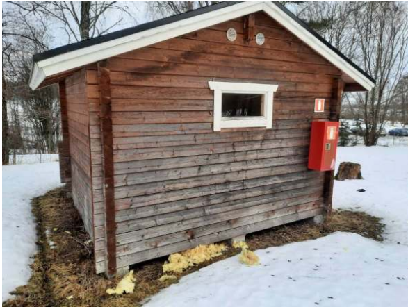
32. Paikoin eläimet päässeet alapohjarakenteisiin. Mökki 5.
