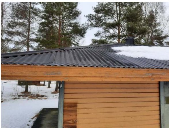
115. Vesikatto vanha huoltorakennus, pinnoite irtoaa.
