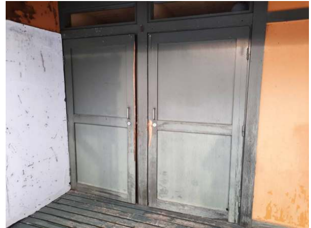
104. Ulko-ovet vastaanotossa vaatimattomassa kunnossa.
