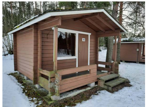
40. Mökin 14 osalla vaurioita.
