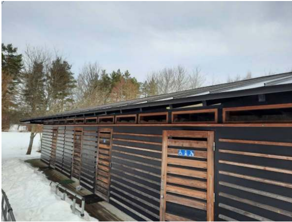
5. Uudemman huoltorakennuksen kattovesien ohjausta. Kattovedet valuvat kuistille.
