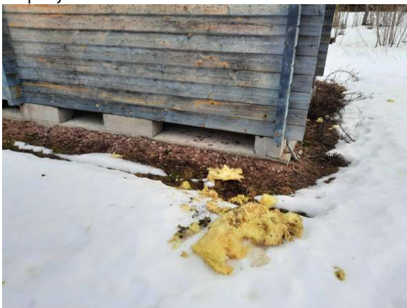
34. Paikoin eläimet päässeet alapohjarakenteisiin. Mökki 23.
