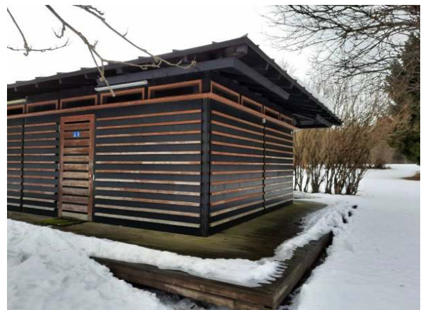
4. Uudemman huoltorakennuksen vierustaa ja kattovesien ohjausta. Kattovedet valuvat kuistille.
