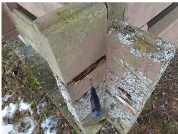
41. Mökin 14 osalla vaurioita.
