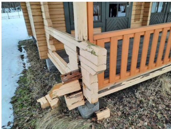
39. Saunan runkorakenteissa vaurioita.
