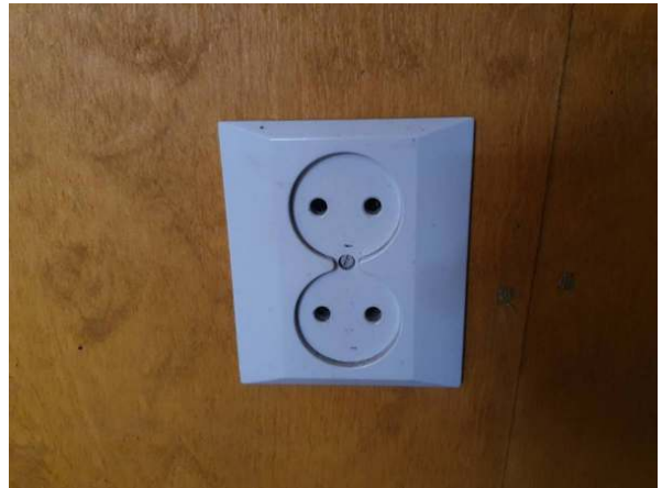
200. 0 luokan pistorasioita, vastaanottorakennus.
