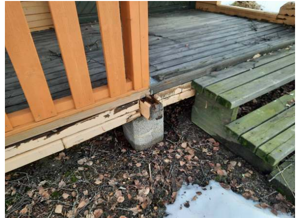
38. Saunan runkorakenteissa vaurioita.
