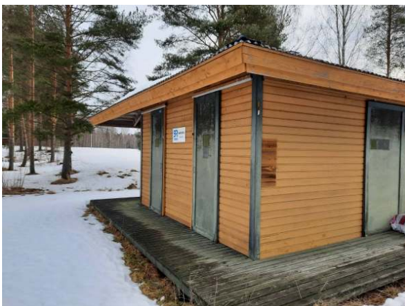
3. Vanhan huoltorakennuksen vierustaa. Kattovedet valuvat kuistille.
