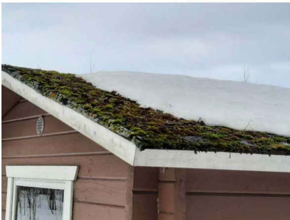
121. Mökkien katot ovat likaantuneita ja osin jo kuluneita.
