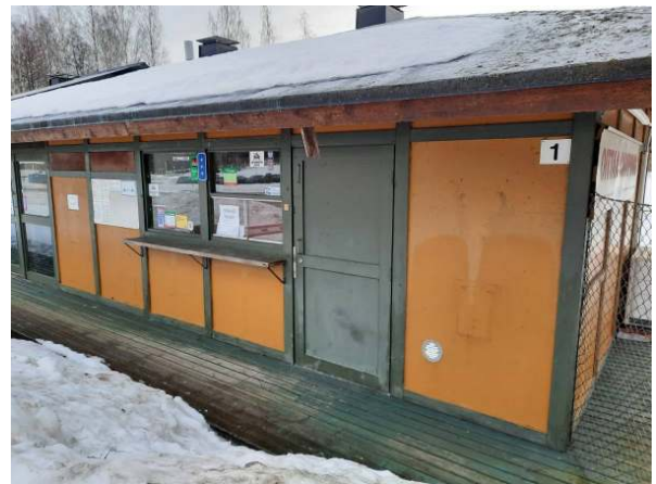
2. Vastaanoton osalla kattovedet valuvat kuistille.
