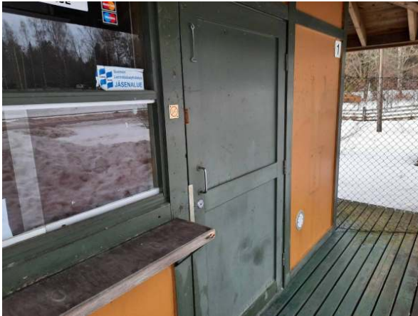
103. Ulko-ovet vastaanotossa vaatimattomassa kunnossa.
