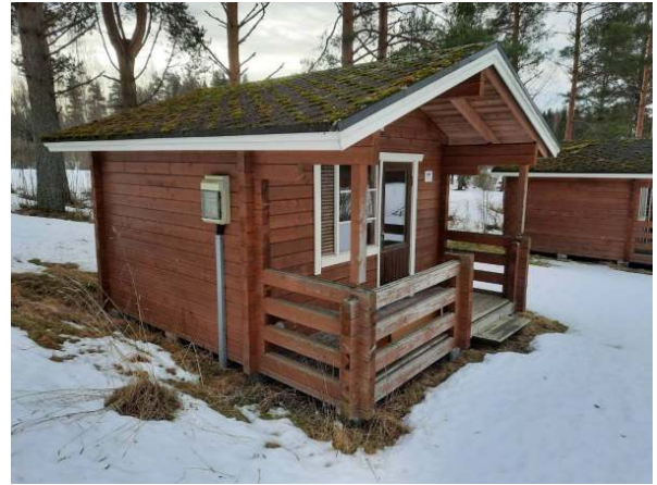
120. Mökkien katot ovat likaantuneita ja osin jo kuluneita.
