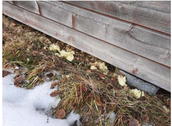
33. Paikoin eläimet päässeet alapohjarakenteisiin.
