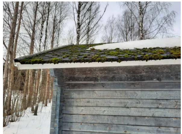
122. Mökkien katot ovat likaantuneita ja osin jo kuluneita.
