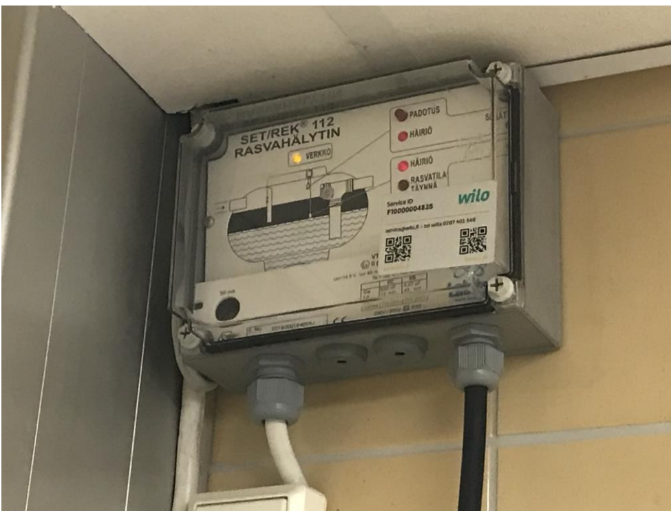
Kuva 5.5. Rasvanerotuskaivon hälytyskeskuksessa häiriö päällä.
