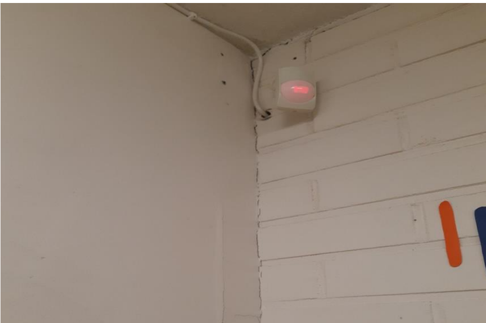
Kuva 4.8. Aula 102 nurkassa rakenneliittymä on haljennut.
