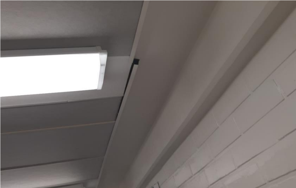
Kuva 4.5. Tila 205 katon akustolevyn reunalista on irronnut.
