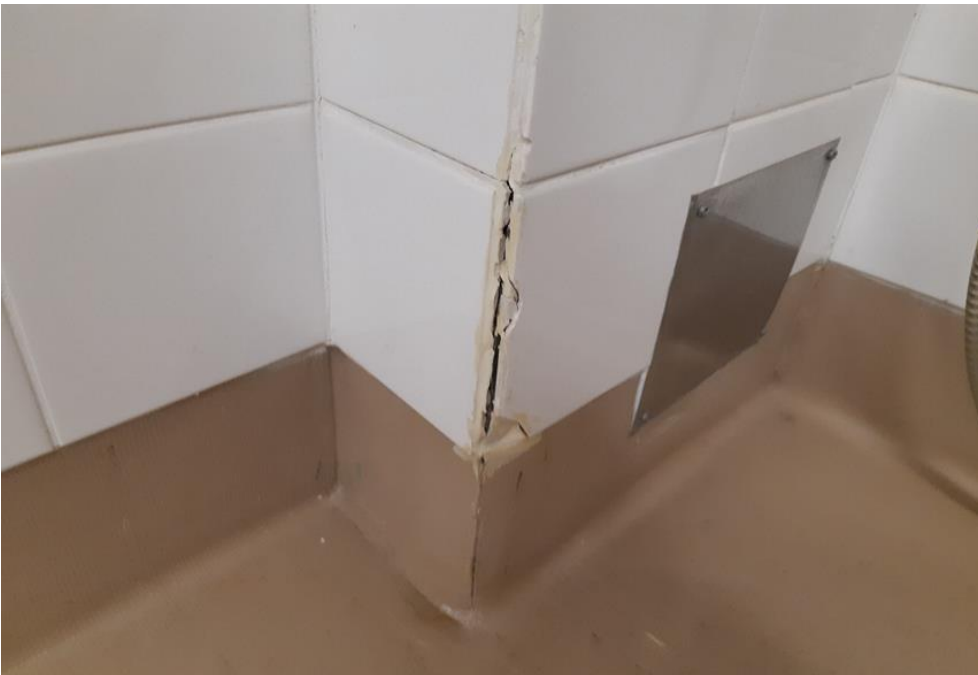
Kuva 4.12. WC-tila 118 pystykotelossa alareunan laatoitus on rikkoutunut.
