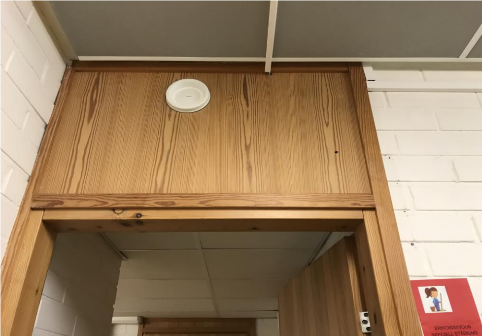
Kuva 5.2. Kokoustilassa 104 poistoilmaventtiili tulpattu. Huoneesta poistuu ilma oviraon kautta pukuhuoneeseen ja käytävälle.
