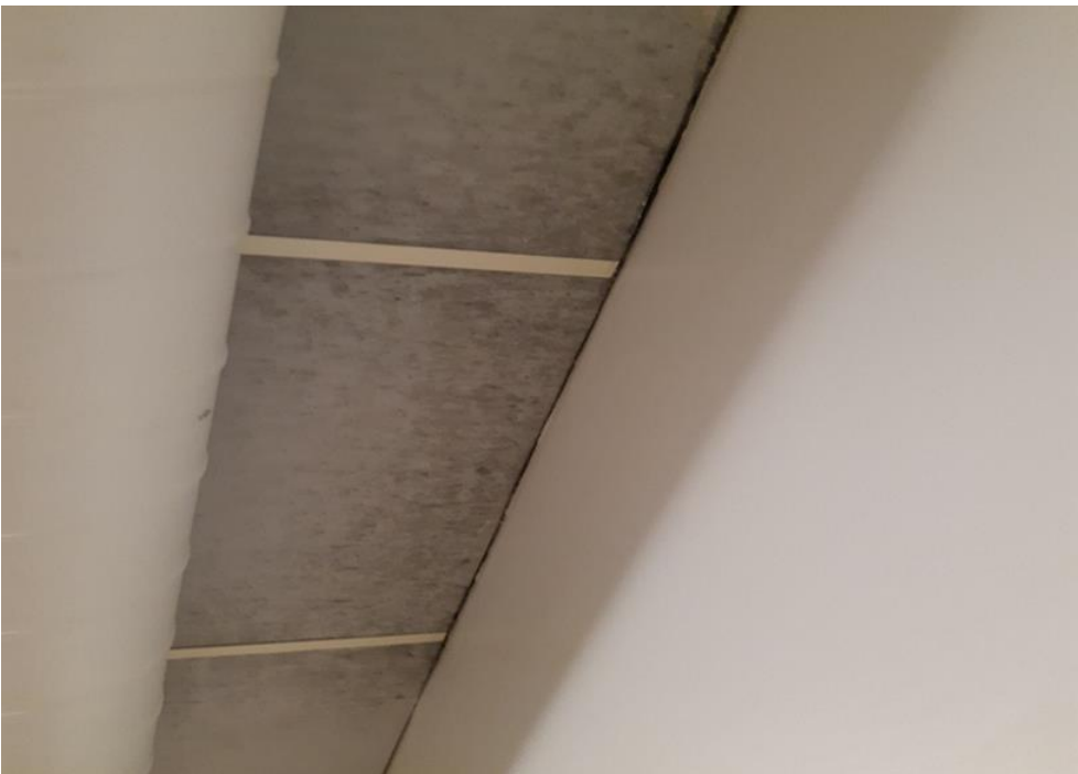
Kuva 4.10. Leikkitila 120 katto/väliseinäliittymässä ilmavuoto.
