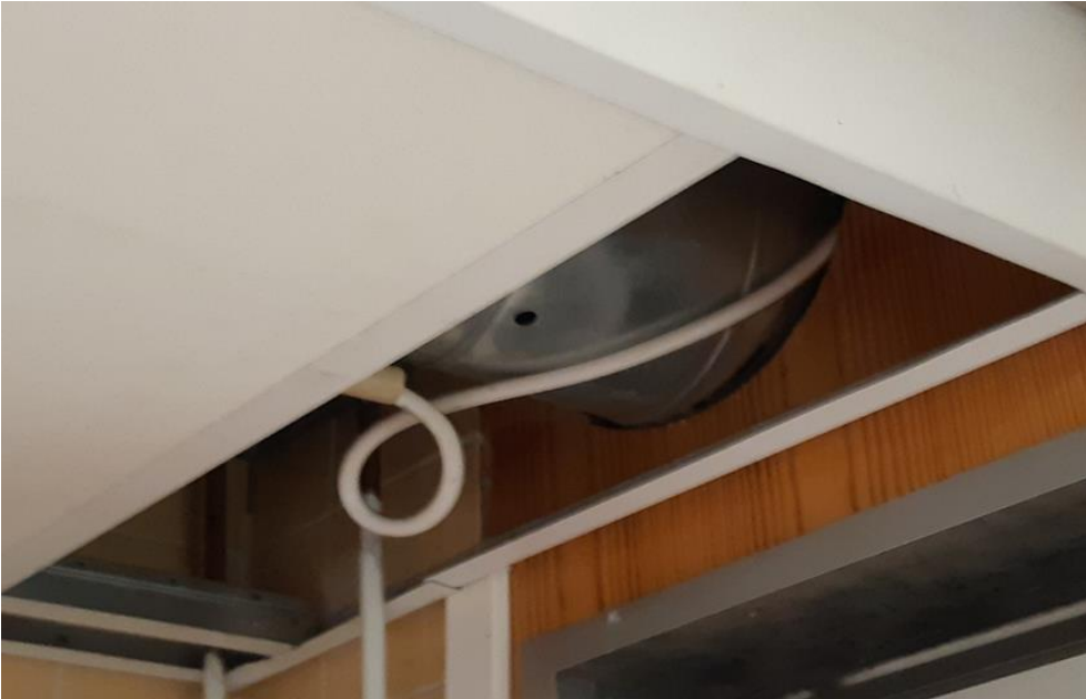
Kuva 4.7. Keittiö 206 katosta puuttuu akustolevyjä.
