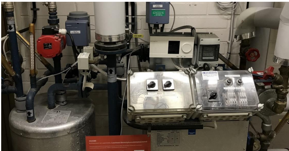
Kuva 6.2. Lämmönvahdinpaketti alkuperäinen vuodelta 1981.
