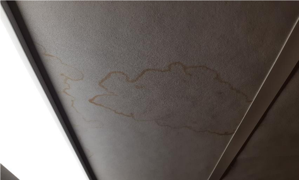
Kuva 4.9. Käytävä 112 akustolevyssä on vesivuotojälki ja osa akustolevyistä on rikkoutunut.
