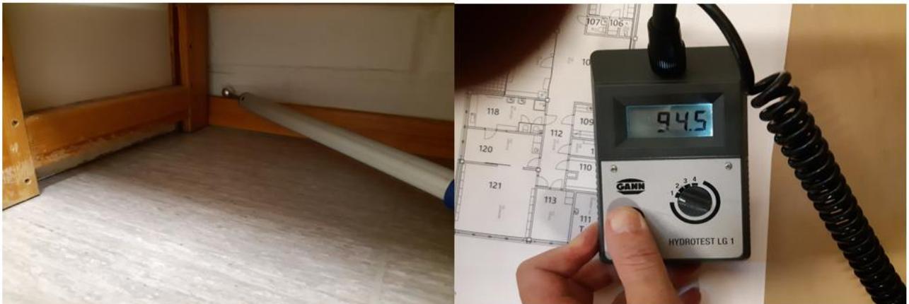
Kuva 4.14. Työtila 104 ulkoseinän alanurkassa kohonneita kosteuksia.
