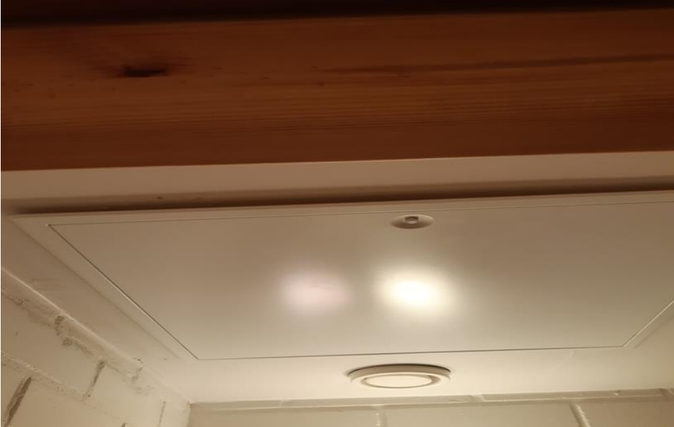
Kuva 4.1. WC-tila 204 katossa oleva tarkastusluukku on osittain irronnut.
