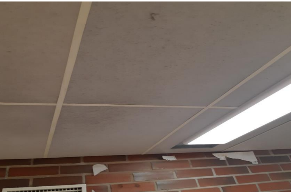
Kuva 4.4. Monitoimitila 216 katon akustolevyistä osa on erittäin likaisia.
