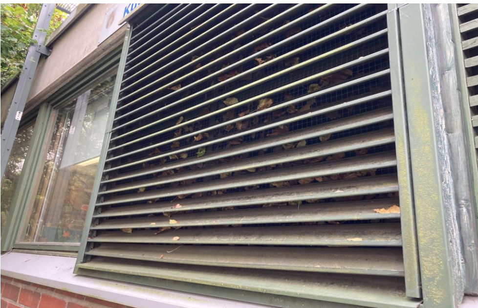
Kuva 5.1. Raitisilmasäleikössä lehtiä ja muuta roskaa.
