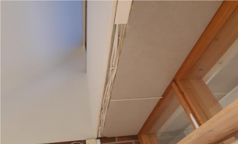
Kuva 4.3. Monitoimitila 216 Katossa olevan johtokourun kansi puuttuu.
