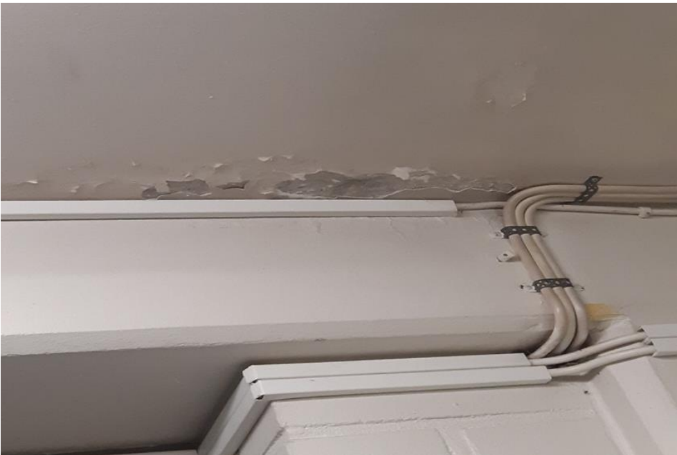
Kuva 4.6. Eteinen 201 ulkoseinän palkin ja ontelolaatan liitoksessa on vesivauriojälki.
