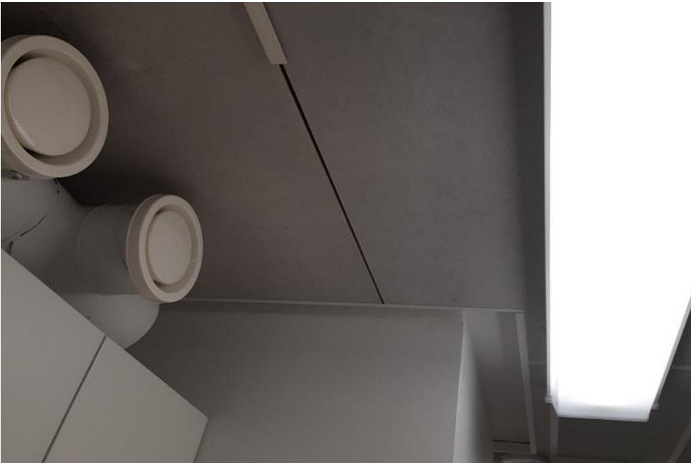
Kuva 4.2. Tila 211 katon akustolevyistä puuttuu välilistoja ja osa levyistä on rikkoutunut.
