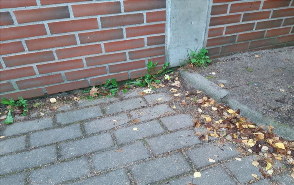
Kuva 4.15. Rakennuksen sokkelikorkeudet on liian matalat, roiskevesi kastelee ja likaa tiiliverhouksen
