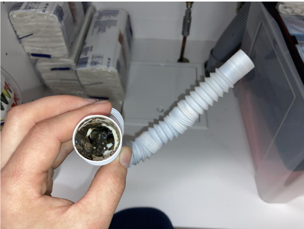
Kuva 5.3. Pesualtaiden poistoilmaputkissa ylimääräistä liettä, joka voi tuottaa hajua huonetilaan.
