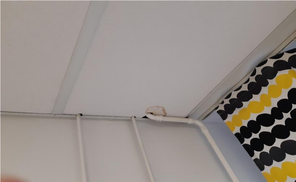
Kuva 4.11. WC-tila 118 katon akustolevyssä vesivuotojälki.
