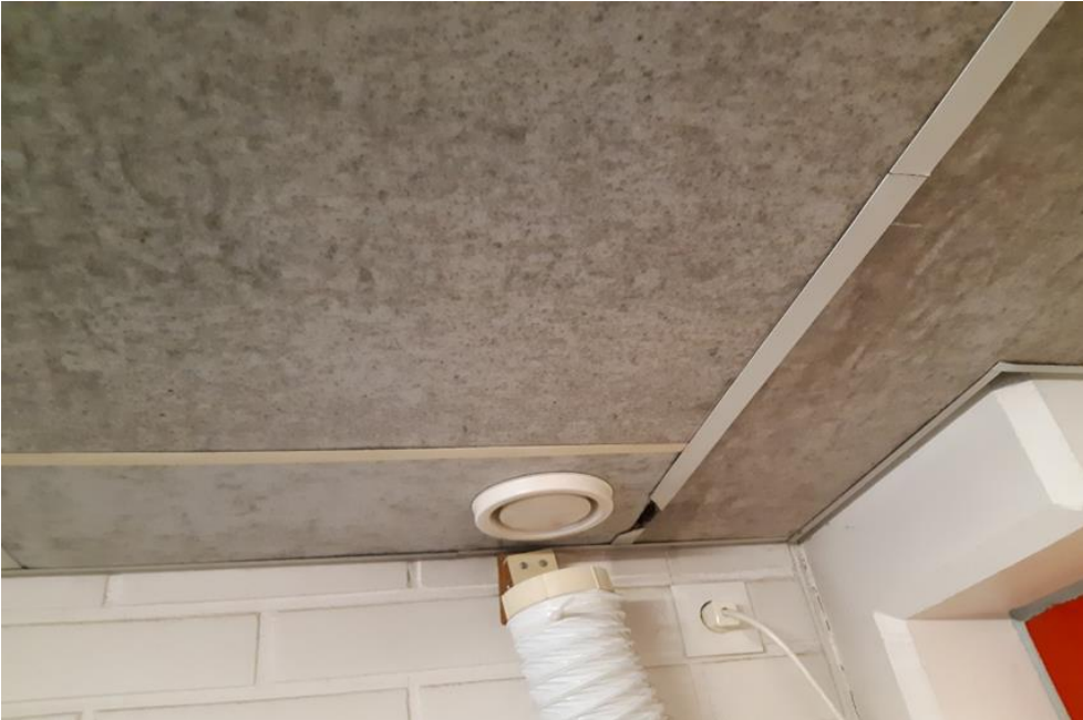
Kuva 4.13. Eteinen 101 katon akustolevyt ovat likaisia ja osin rikkoutuneita.
