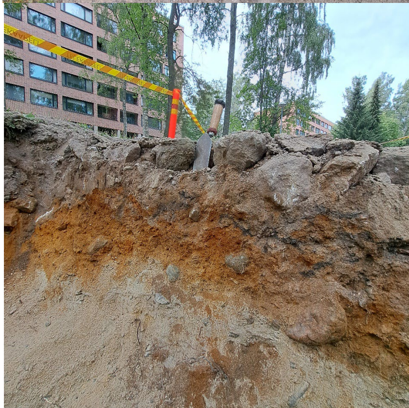
Kuva 4 Ylhäällä tykkkien leikkauksesta purettua kivetystä. Alhaalla tien profiili, jossa näkyy kivikerros, täyttömaakerros ja pohjahiekka.
