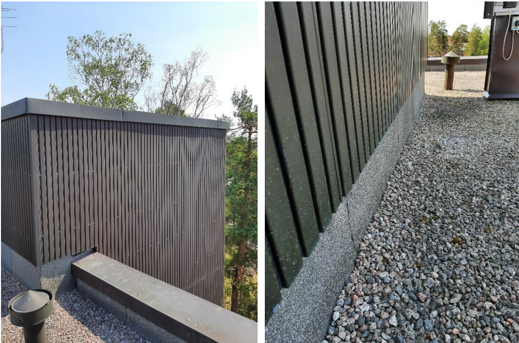
Katolla tutkittiin huippumurien kotelojen tyvet. Niissä oli rakoja, mutta papanoita ei löytynyt.
