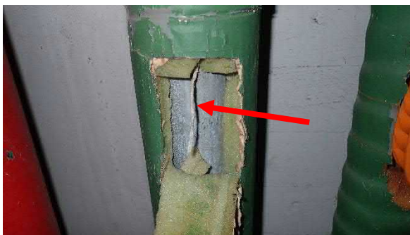
Kuva 3. Aaltopahvisen vihreäksi maalatun putkieristeiden sisällä havaittiin todennäköisesti asbestia.
