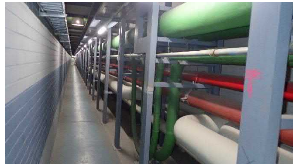
Kuva 2. Asbestipitoisia putkieristeitä putkitunnelissa.
