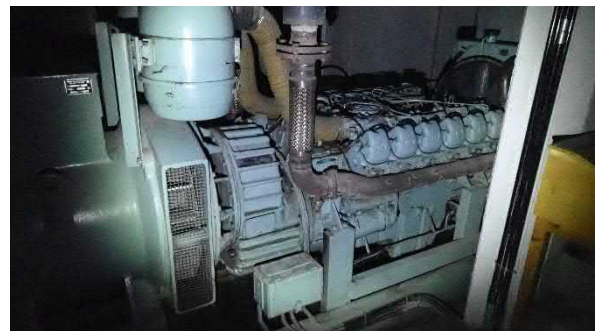
Kuva 18. Varavoimakonehuoneen rakenteisiin on
