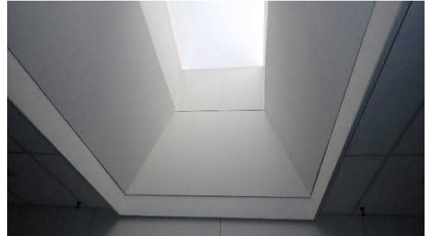
Kuva 10. Todennäköisesti asbestipitoista kuitusementtilevyä kattoikkunoiden levytyksenä.
