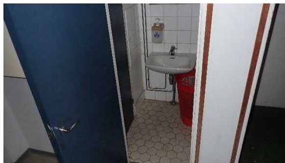
Kuva 8. 6-kulmalaattaa yhdessä länsihallin wc-tilassa. Keraamisen laatan kiinnitys- ja saumalaasti saattavat sisältää asbestia.
