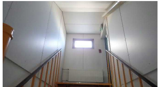
Kuva 12. Todennäköisesti asbestipitoista kuitusementtilevyä länsihallin katolle johtavan käynnin poraikossa
