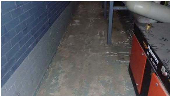
Kuva 15. Putkitunnelin betonilattian maali saattaa sisältää PCB- ja metalliyhdisteitä.
