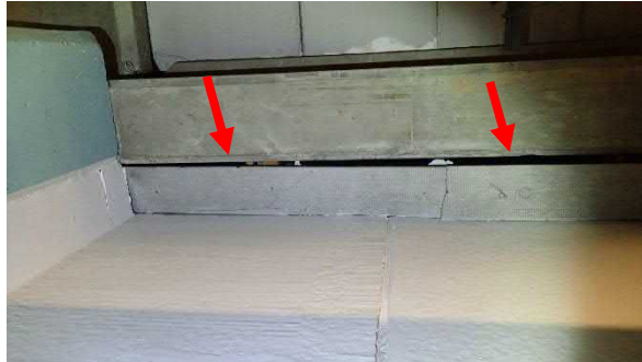
Kuva 9. Todennäköisesti asbestipitoinen kuitusementtilevykaistale itähallin katossa.
