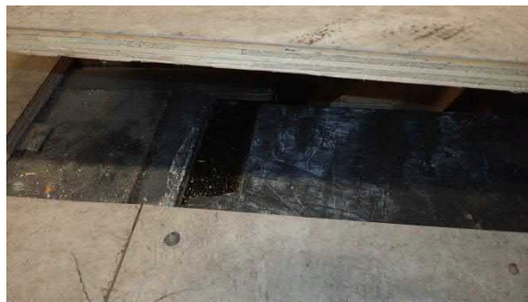
Kuva 6. Asbestipitoista 6-kulmalaattaa kellarin käytävällä.
