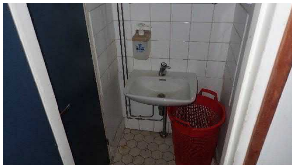
Kuva 7. Pyöreäreunaista keraamista laatoitusta länsihallin yhdessä WC-tilassa. Vastaavanlaisen laatoituksen kiinnityslaasti sisälsi itähallin toimisto-osassa asbestia.
