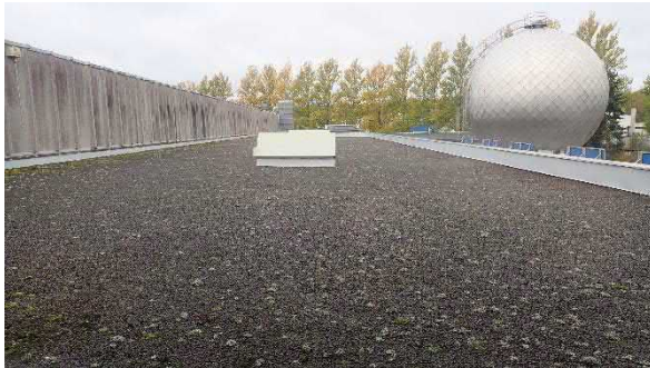
Kuva 13. Vesikattojen bitumikermit saattavat sisältää asbestia ja PAH-yhdisteitä.
