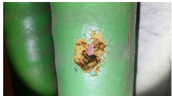
Kuva 4. Vihreäksi maalatuissa vaahtomuovieristeissä ei havaittu asbestipitoisia materiaaleja.
