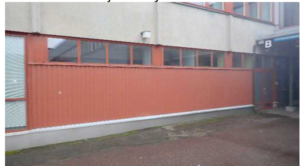
Kuva 16. Ulkoseinärakenteissa saattaa olla asbestipitoisia tuulensuojalevyjä.
