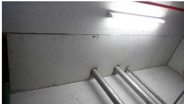
Kuva 11. Todennäköisesti asbestipitoista kuitusementtilevyä länsihallin teknisen tilan aulan katossa.
