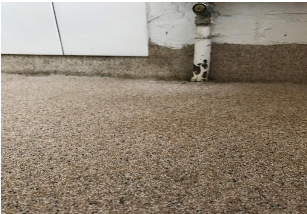
Kuva 5.8. WC tilojen patteritermostaatin säätöosa puuttuu.
