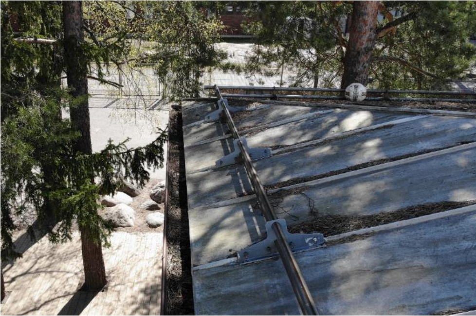
Kuva 4.2. Sadevesikourut ovat puhdistamatta.
