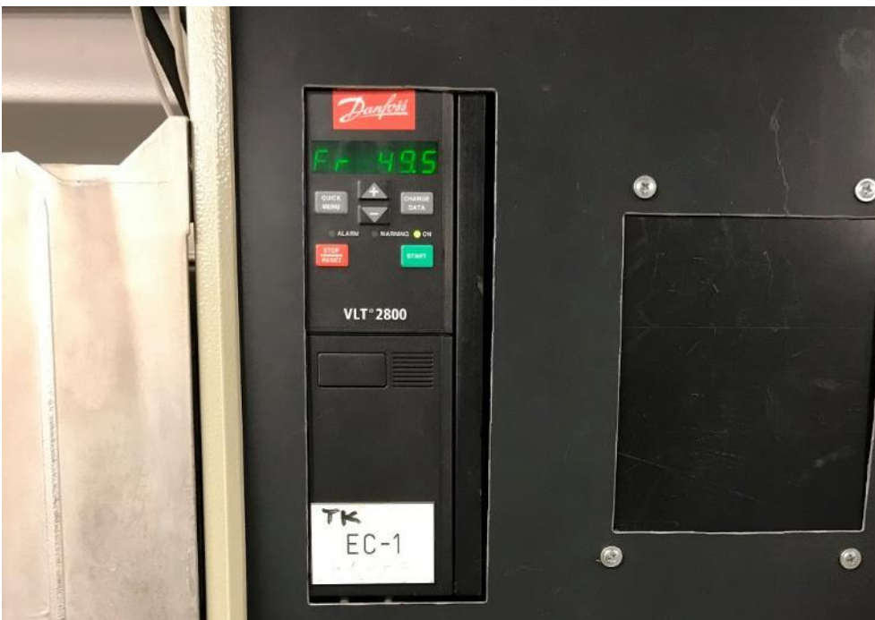
Kuva 6.4. EMC-suojauksissa on puutteita.
