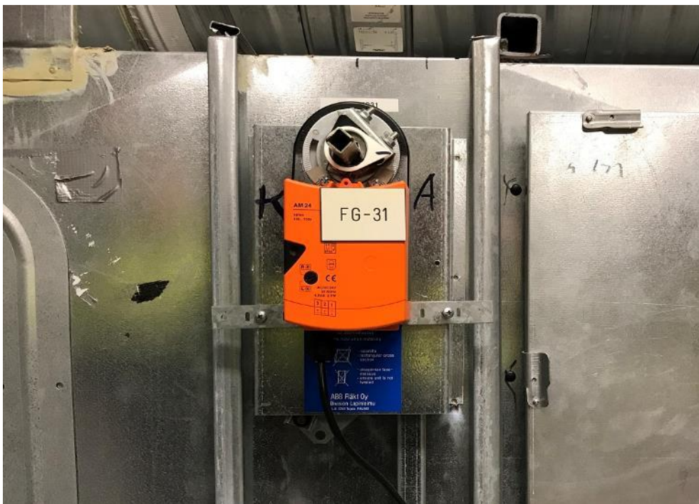
Kuva 6.2. Peltimoottori/vyöhykepelti on jumissa.
