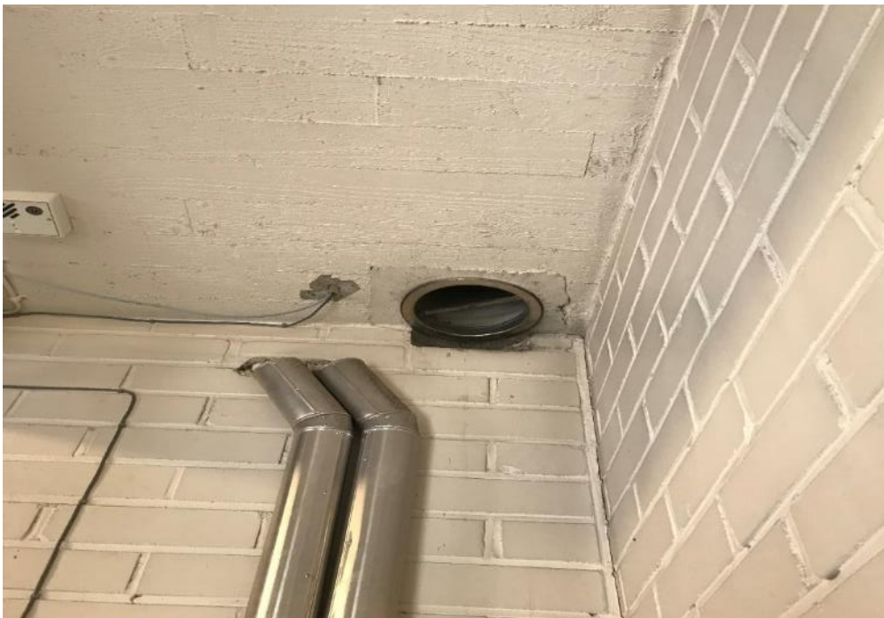
Kuva 5.4. Lämmönjakuhuoneen poistoilmaventtiili puuttuu.
