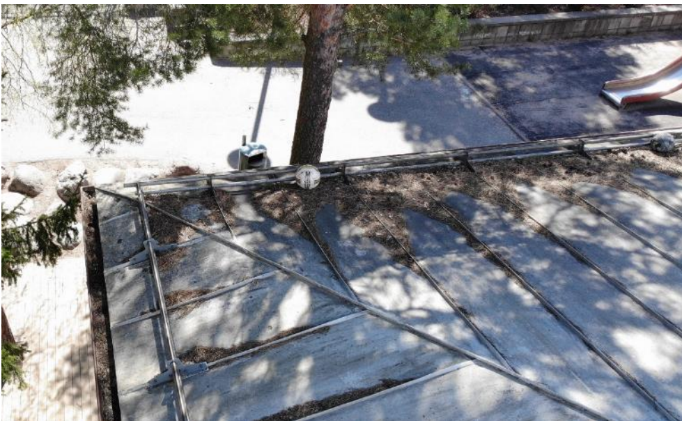
Kuva 4.1. Vesikatto on puhdistamatta.
