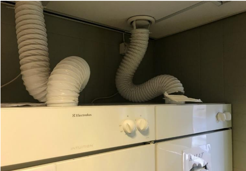
Kuva 5.7. Kuivauskaappien poistoletkut ovat osin irti.
