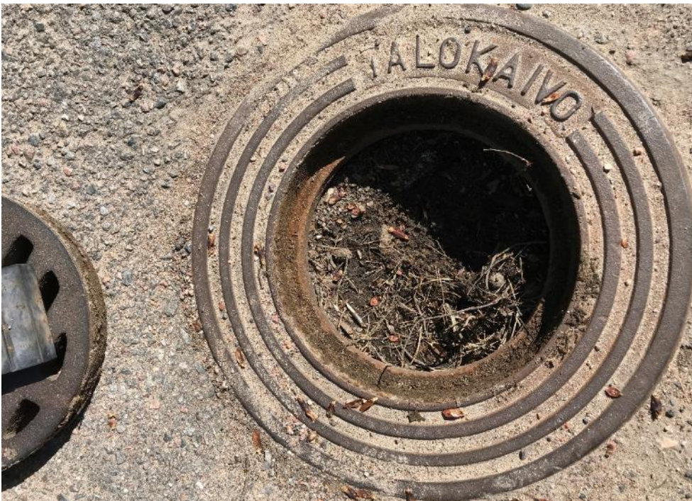
Kuva 5.12. Pihan sadevesikaivoissa on hiekkaa.
