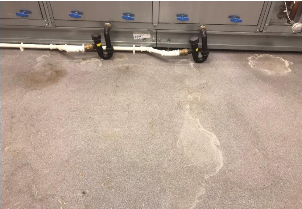
Kuva 5.2. Tuloilmakoneen raitisilmakammio on likainen ja koneen sisälle on päässyt lunta, joka sulanut ja valunut konehuoneen lattialle
