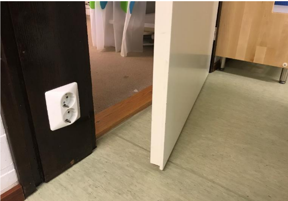
Kuva 5.10. WC tilojen korvausilmareitit puuttuvat useasta tilasta.
