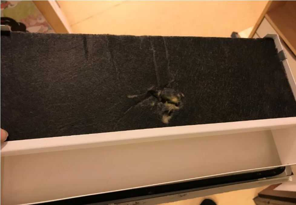
Kuva 5.9. Tuloilmasäleiköiden mineraalivillaisten äänenvaimentimien pinta on rikki.
