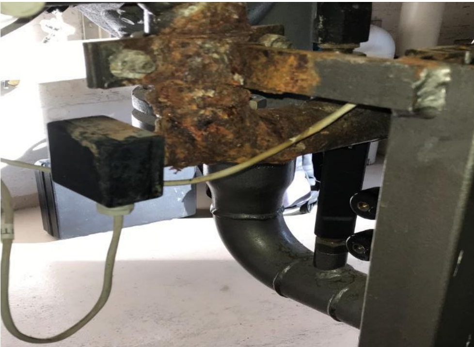
Kuva 5.6. Lämmönsiirtimen osat ovat pahoin ruosteessa.
