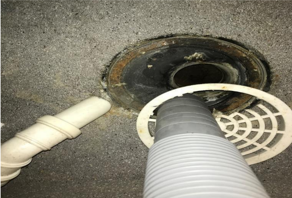
Kuva 5.1. Ilmanvaihtokonehuoneen pesualtaan hanan vesiputket on suljettu ja lattiakaivo on kuiva.
