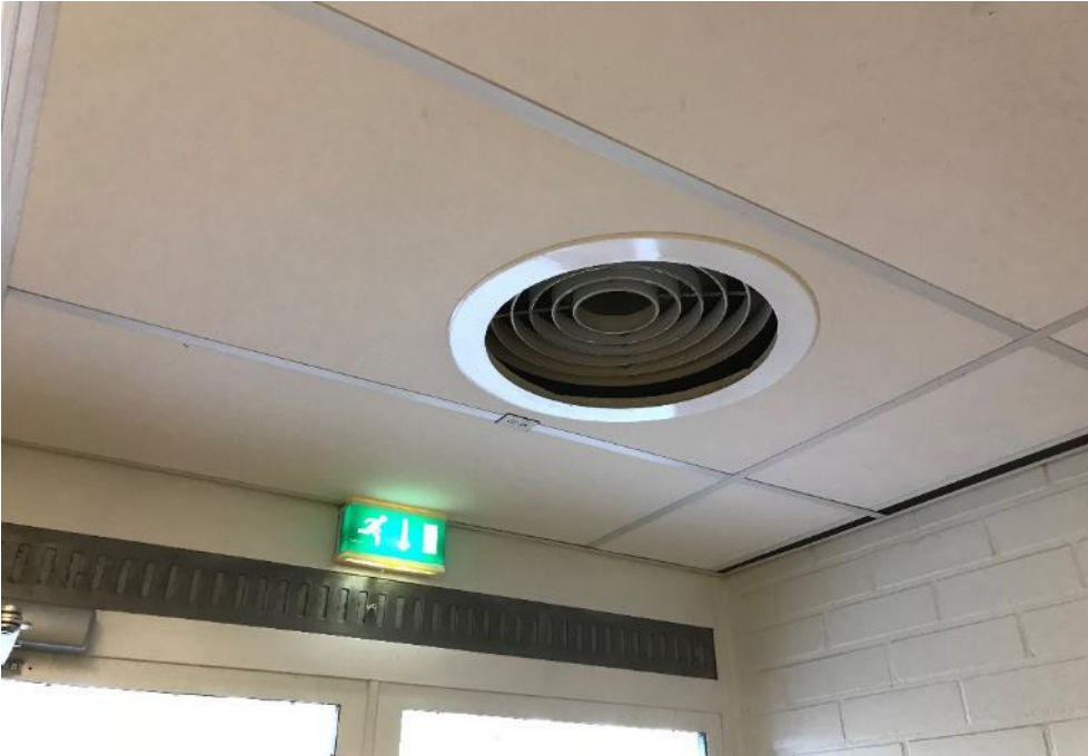
Kuva 5.5. Kiertoilmakoneen puhallusputki ei ylety kattopintaan.
