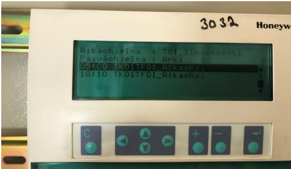
Kuva 6.1. Taajuusmuuttaja ilmastointikoneen aikaohjelma.
