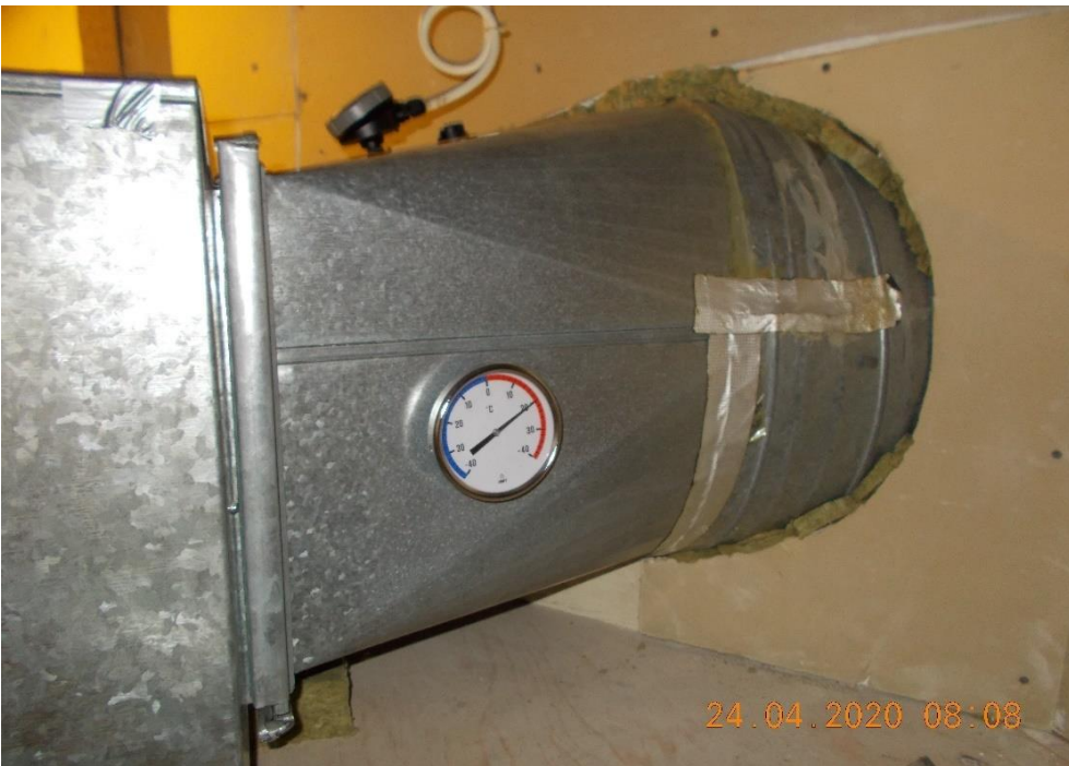
Kuva 4.15. Ilmastointikonehuoneen läpivienti on tiivistetty villalla.
