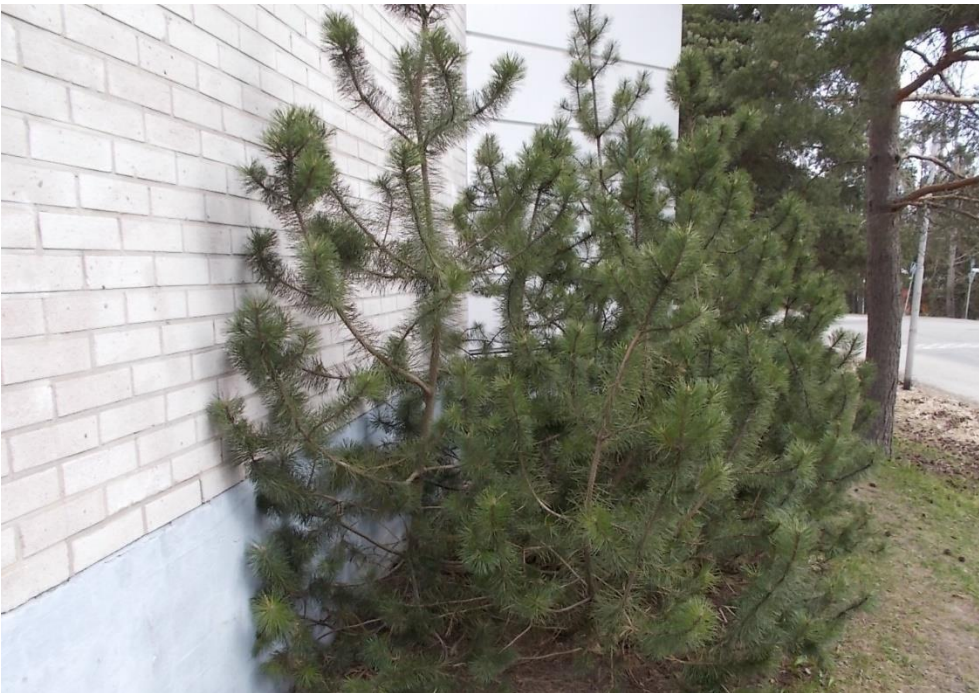
Kuva 4.1. Rakennuksen vierustalla on kasvillisuutta.
