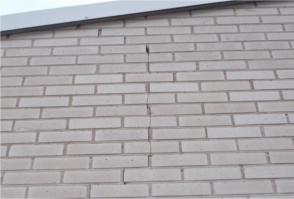
Kuva 4.2. Tiiliverhouksessa on halkeama.
