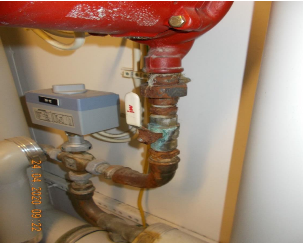
Kuva 5.6. Lämmitysverkoston putkisto on ruosteessa.
