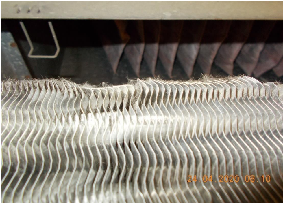
Kuva 5.2. Tuloilmakoneen lämmityspatterissa on likaa.
