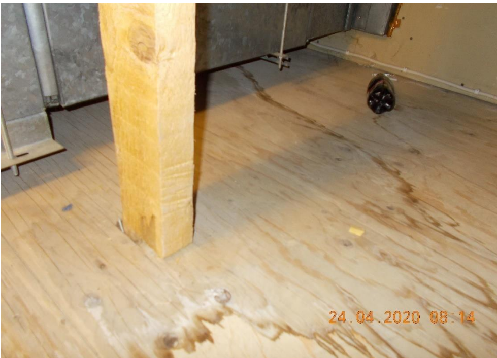
Kuva 5.3. Raitisilmakammioista on vuotanut vettä konehuoneen lattialle.
