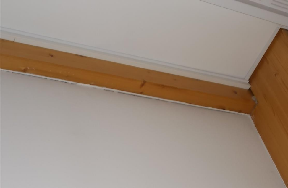
Kuva 4.12. Salin seinän ja katon liitos on auki.
