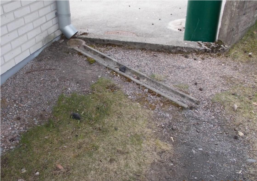
Kuva 4.6. Sadevesi lammikoituu rakennuksen vierelle.
