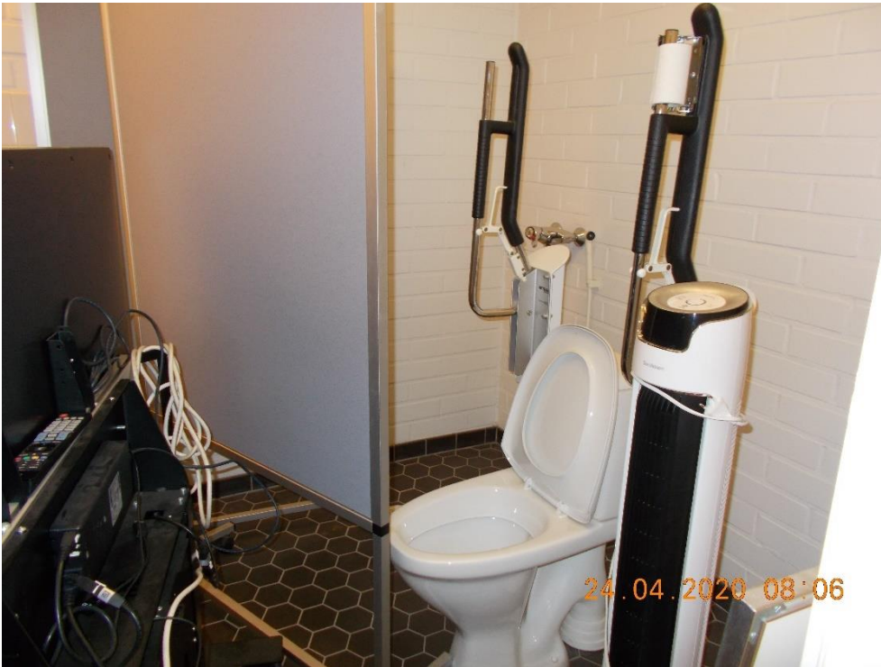
Kuva 5.4. Inva WC:ssä on runsaasti tavaraa, joka estää lattiakaivon huollon.
