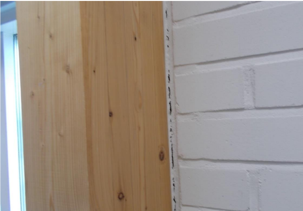
Kuva 4.13. Salin pilarin ja seinän liitos on auki.
