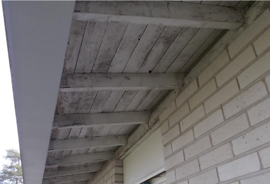
Kuva 4.4. Räystään aluslaudoitus on likainen.
