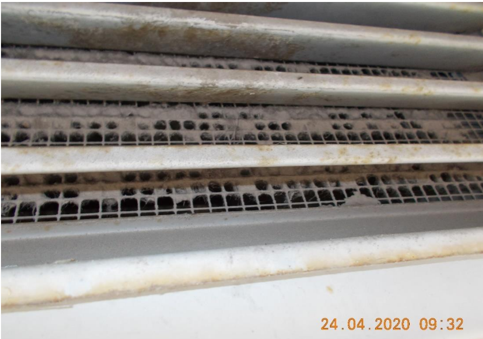
Kuva 5.1. Tuloilmakoneen ulkosäleikkö on lähes tukossa.
