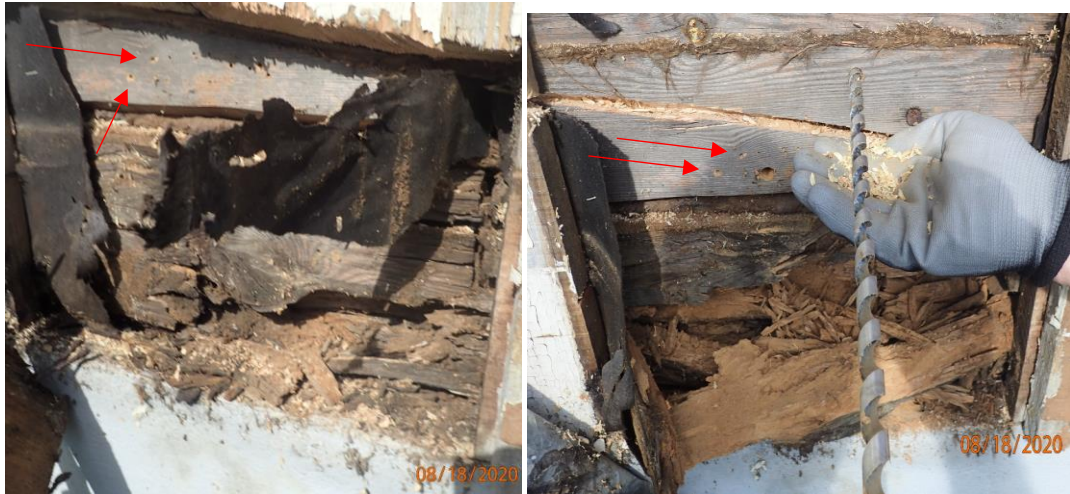
Kuvat 19 ja 20. Alimmat hirret läpivaurioituneet. Toisessa hirressä tupajumien reikiä hirsien alareunoissa. Hirren puolivälistä ylöspäin kuvassa 20 ehjää hirttä.
