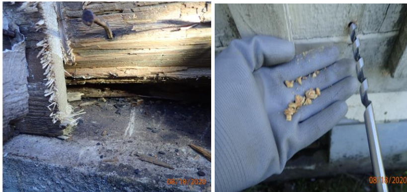
Kuvat 3 ja 4. Sokkelin päällä on ohut bitumisively, joka ei ulotu sokkelin ulkoreunaan asti. Vaakapellin yläreunasta vesi pääsee sokkelin yläpinnalle lisäten seinärakenteen kosteusrasitusta ja mahdollistaen tutajumeille otolliset kosteusolosuhteet. Julkisivulaudoitus oli suurelta osin kirkasta ja kovaa puuta.
