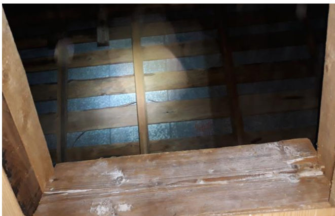
Vesikaton konesaumattun peltikatteen alapuolella on harvalauditus. Aluskate puuttuu. Kosteus pääsee tiivistymään peltipinnoilla ja tippumaan vetenä yläpohjan purueristeisiin.
