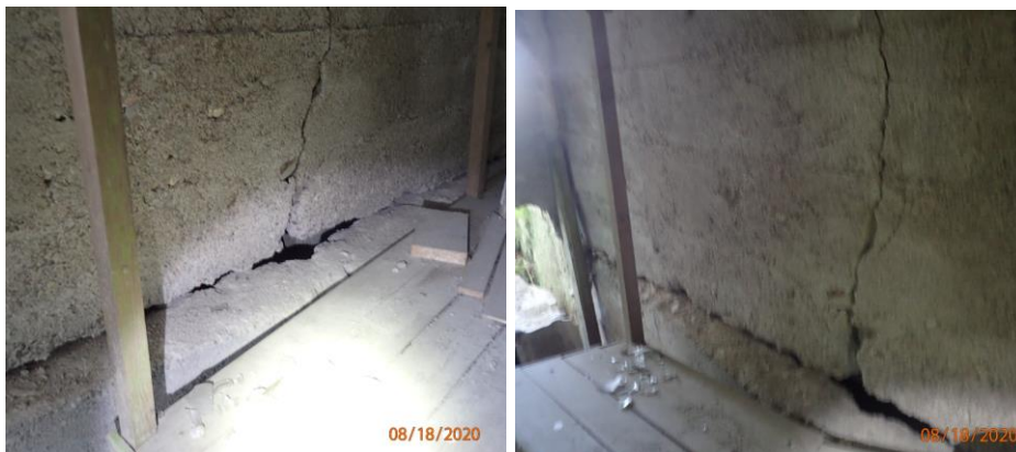
Kuvat 9 ja 10. Kellarin eteiskäytävän betoninen sokkeli on taipunut alareunastaan 150 mm sisäänpäin. Yläreunasta sokkelibetonissa on kahdella seinustalla sokkelin läpi ulottuvia pystyhalkeamia.
