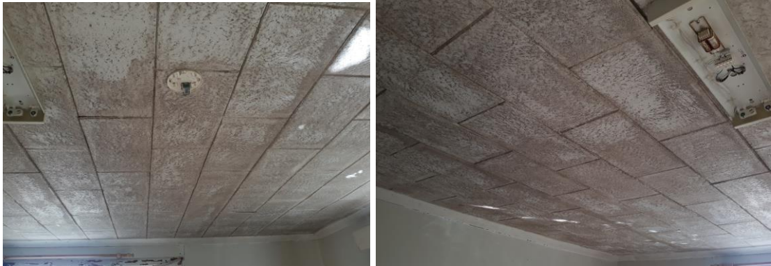
Kuvat 29 ja 30. Kosteus on vaurioittanut rakennuksen sisäpintoja pitkäaikaisesti. Pinnoilla oli laajoja homekasvustoja. Sisätiloissa oli homeen hajua. Hajut ovat imeytyneet pintamateriaaleihin sekä välipohjien ja yläpohjan purueristeisiin.
