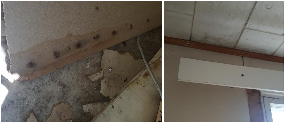
Kuvat 25 ja 26. Tapettikerrosten välistä valunut vesi on kulkenut jalkalistojen korkeudella sivusuunnassa kastellen lastulevyverhousa. Vettä on valunut 1 kerroksen katosta välipohjan kohdalta 1 kerroksen ulkoseinäpinoille.
