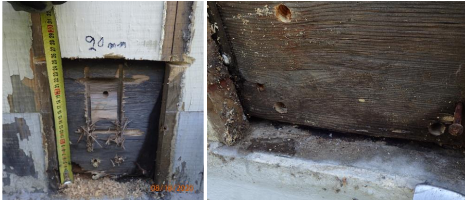
Kuvat 7 ja 8. Muutamassa yksittäisessä kohdin alin hirsi oli selkeästi märkä alareunoistaan sekä hirren pinta tummentunutta ja pehmeää. Kuvassa 7 hirren pinta on lahonnut 20 mm syvyyteen asti. Kuvassa 8 märkä hirren alareuna ja ruostuneita nautoja.
