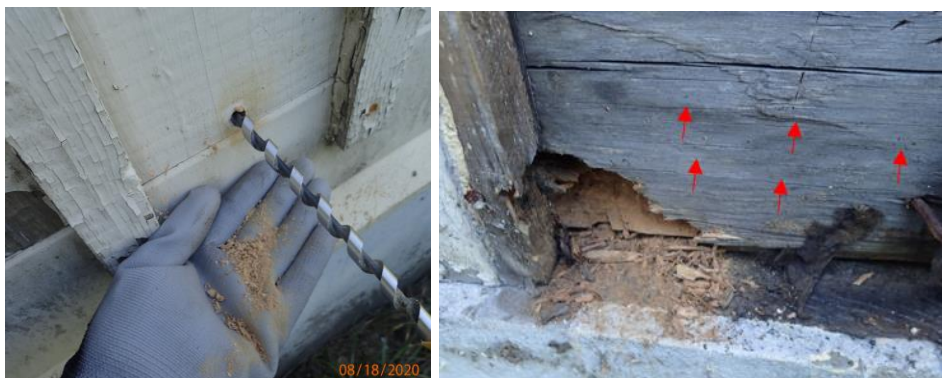
Kuvat 5 ja 6. Rakennuksen hirsirunkoon porattiin useita reikiä, joista voitiin havaita hirsirungon alipien hirsien olevan jauhoontuneita ja menettäneen mekaanisen lujuuden. Hirsien pinnoilla oli runsaasti tupajumien ulostuloreikiä.
