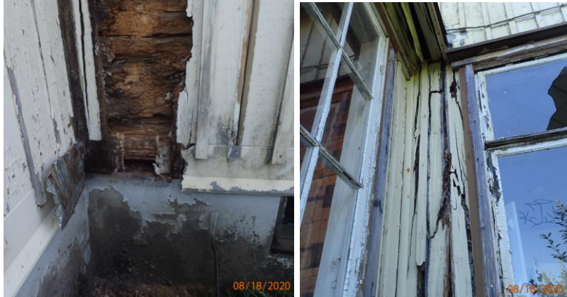
Kuvat 1 ja 2. Rakennuksen pääsisäänkäynnin oikealla puolella on katolta valunut vettä pitkäaikaisesti ulkoseinälle. Hirsirunko on läpilahonnut. Julkisivulaudoituksen alareunassa on vaakapellitusta asennuksena.
