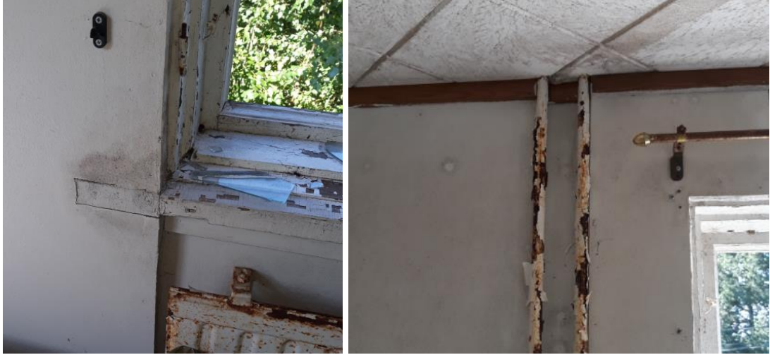
Kuvat 27 ja 28. Vesi on turmellut useissa kohdin ikkunapenkkejä ja viereisiä lastulevyypintoja. Patteriputkissa oli ruosteisia valumajälkiä viitteenä vesiputkien vuodoista. Myös lämpöpatterissa oli läpi ruostuneita reikiä.
