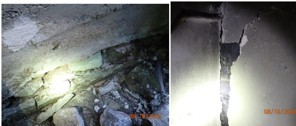
Kuvat 11 ja 12. Kellarinkantavan väliseinän alta kiviladonta osin sortunut ja maa-aines pois. Kantavan seinään kohdistuu painumariski, joka voi aiheuttaa rakennuksen muihin rakenteisiin painumia ja rakenteellisia vaurioita. Kellarin ulkoseinien rappauspinnan alla on kokoseinän korkeudelta bitumisively.
