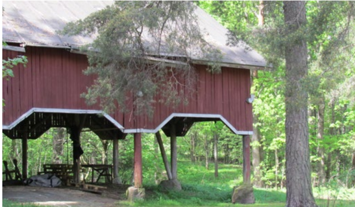
Kuva. Rakennuksen pohjoisosa on kauttaaltaan auki.
