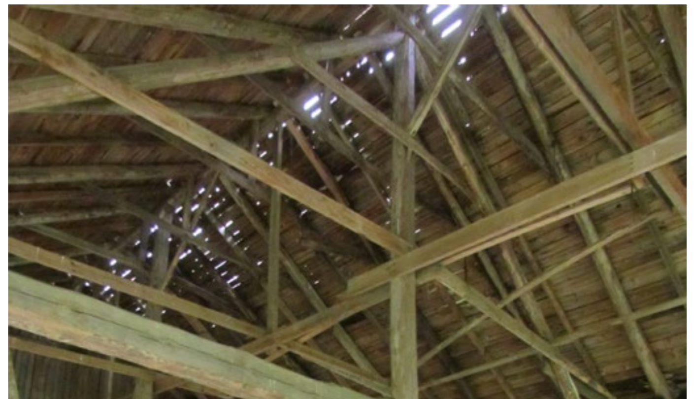
Kuva. Rakennuksen katto on harva.
