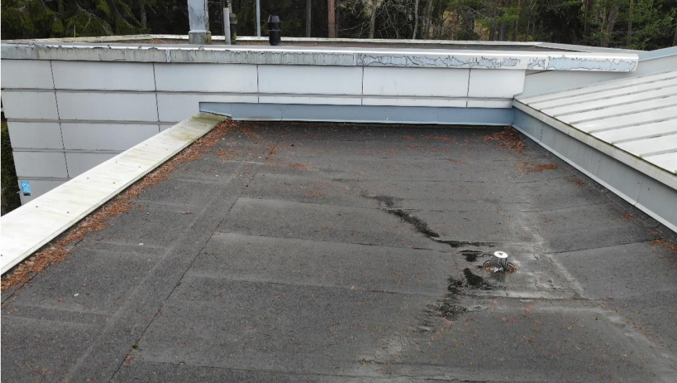
Kuva 4.1. Vesikatolla on roskaa.
