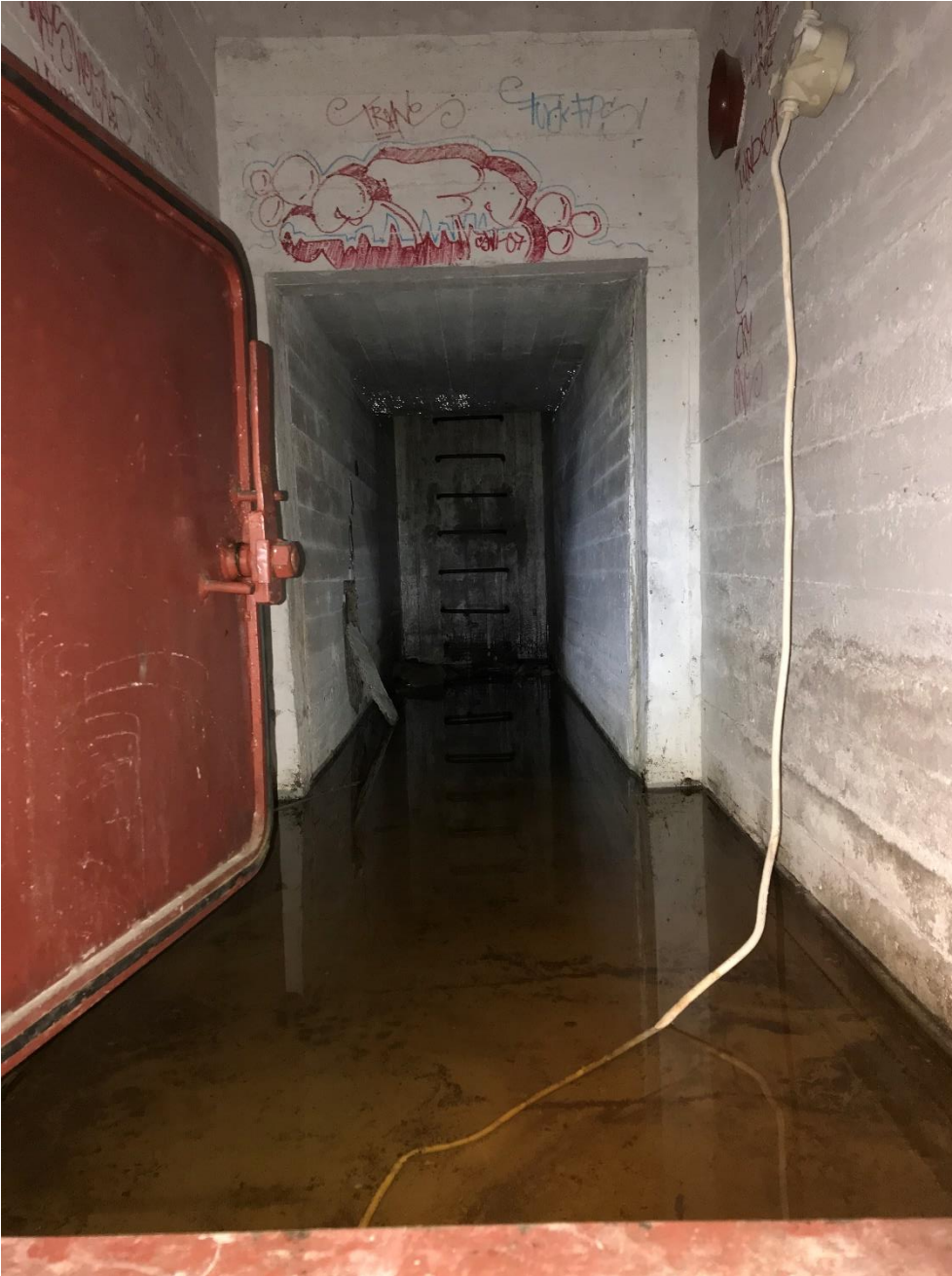
Kuva 4.11. Väestönsuojan poistumistie on veden peitossa.
