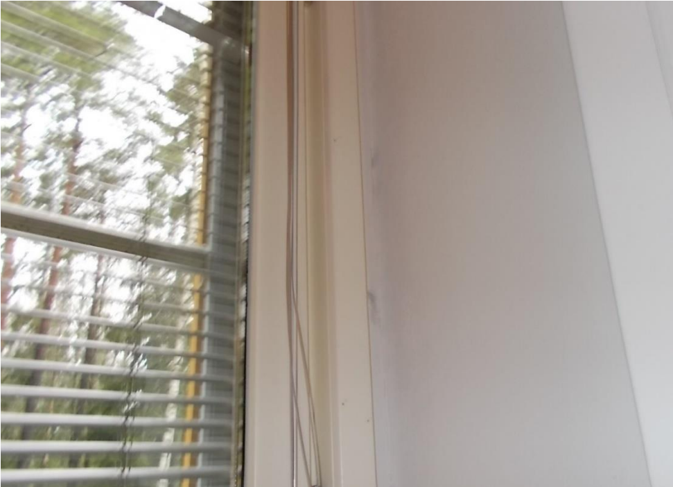
Kuva 4.3. Ilmavuotoa seinän ja ikkunan karmin liitoksessa Luokassa 228.
