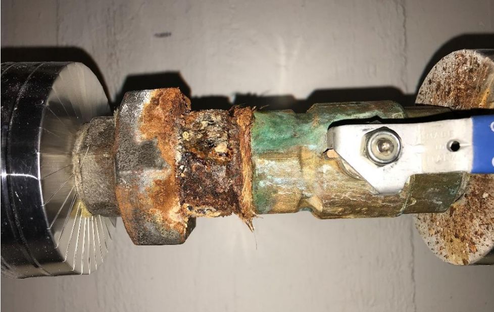
Kuva 5.1. Lämmönjakohuoneen lämpöputkistossa on pieni vuoto.
