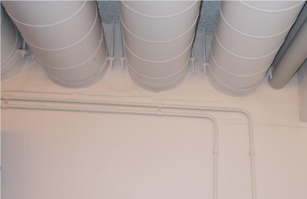
Kuva 4.5. Halkeama seinässä Siivouskomerossa 233.
