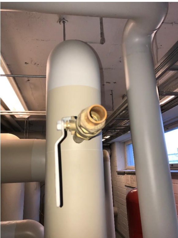
Kuva 5.2. Lämmönjakohuoneessa on tulppaamaton venttiili.
