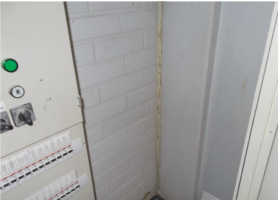
Kuva 4.8. Seinien liittymä aulan sähkökeskuksessa.
