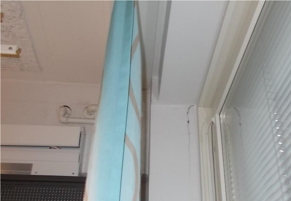
Kuva 4.7. Seinässä on halkeama ja läpiviennit ovat tiivistämättä.
