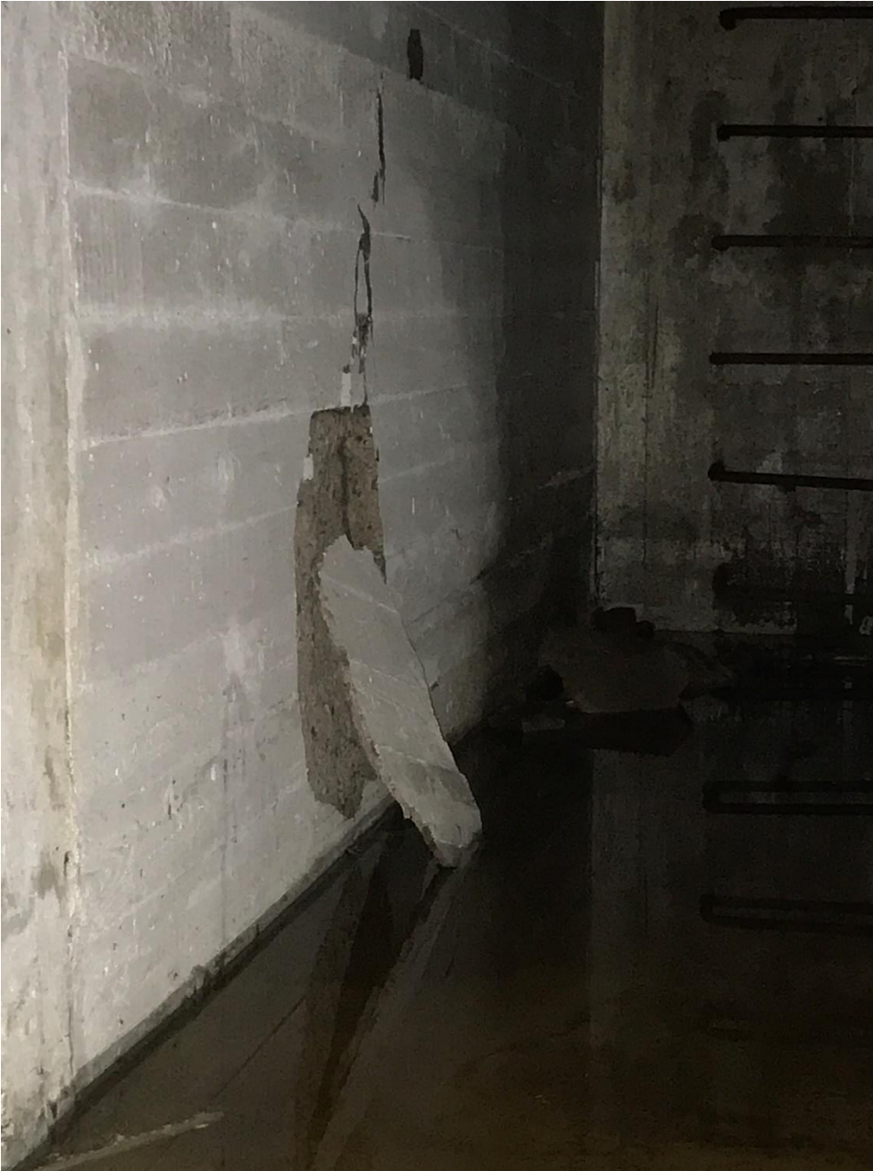
Kuva 4.12. Väestönsuojan poistumistie on veden peitossa ja harkkoseinä halki.
