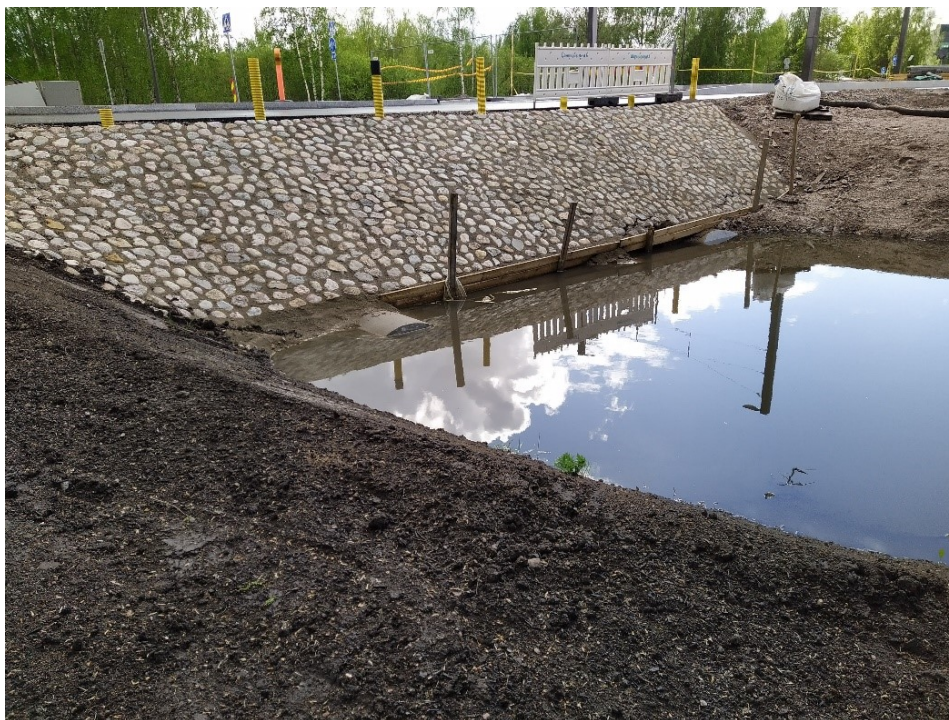
Kuva 11. Maarinniitynojaan purkavat putket. Vedenpinta havaittu useasti putken laen (noin +0,9 m N2000) tasolla meriveden ollessa selkeästi alempana. (Kuva © Eila Suojala)
