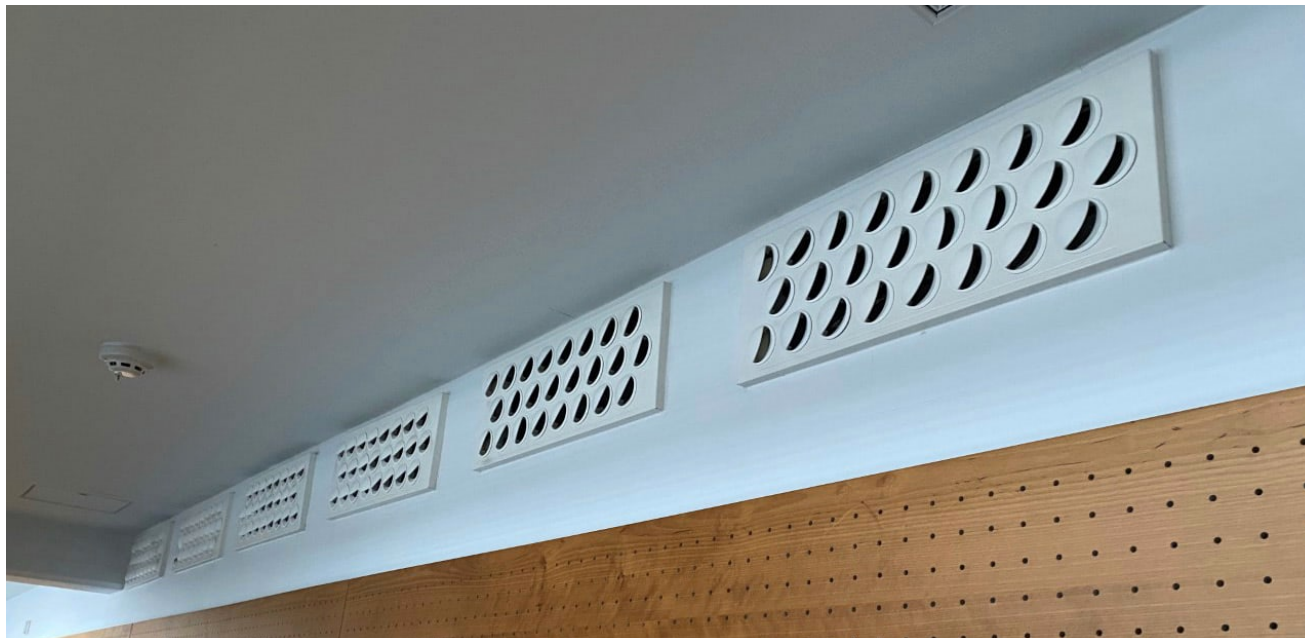
Ensimmäisen kerroksen seinän yläosan tuloilmasäleiköt.
