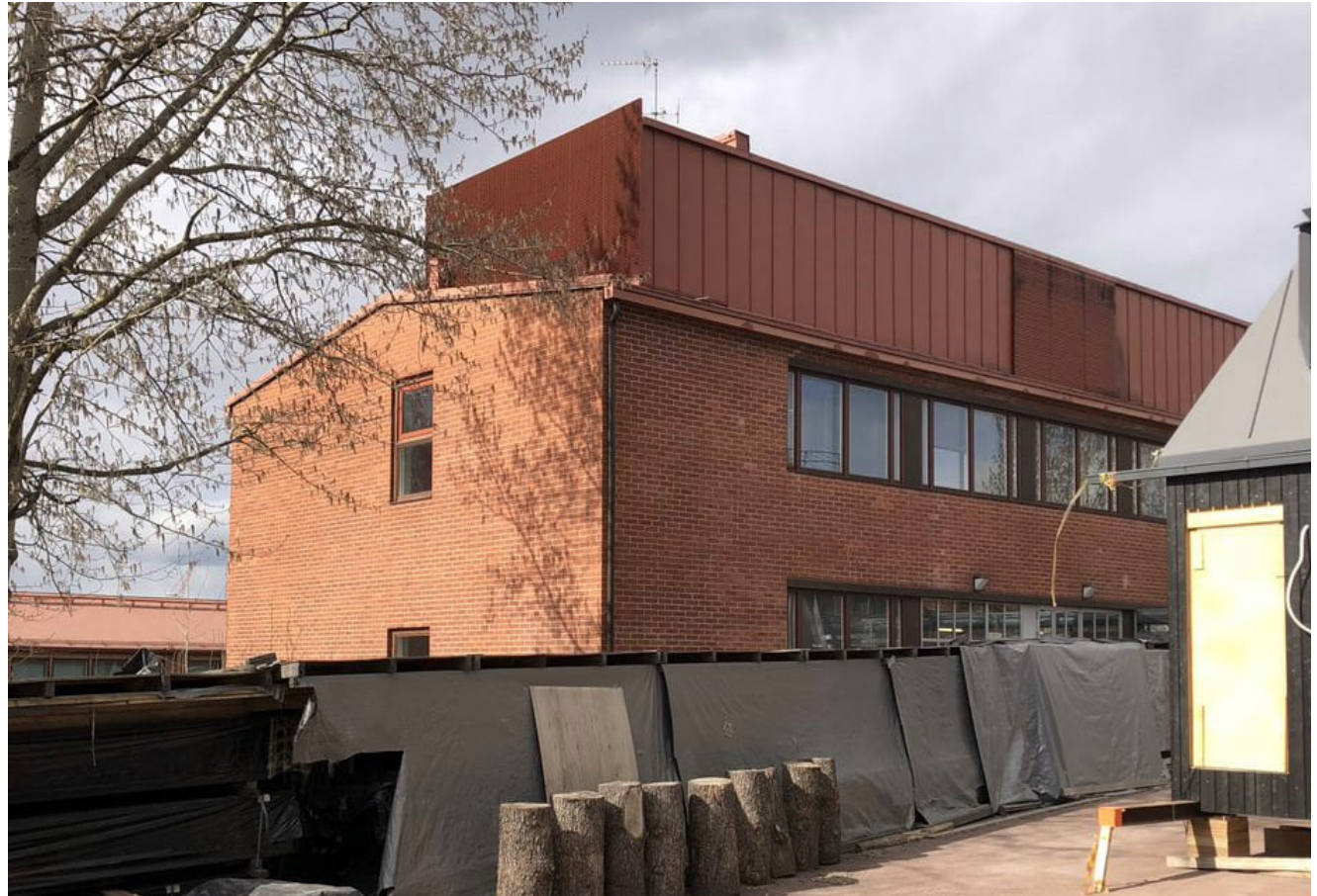
Metallimiehenkuja 4:n lounaispäädyn ilmanvaihtokonehuone kuvattuna huoltopihalta.
