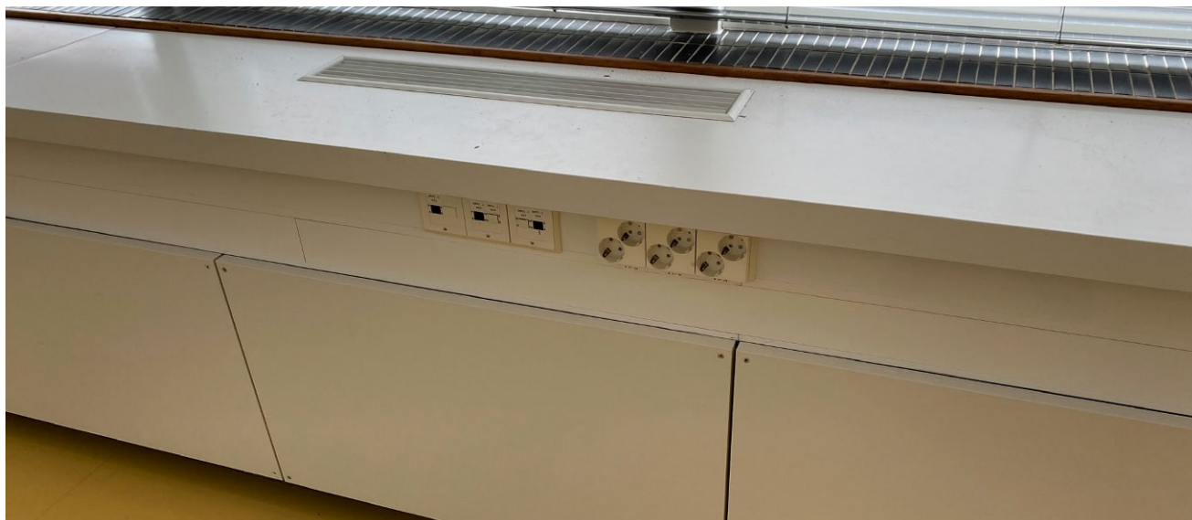
Ulkoseinien ikkunoiden alapuolella on sähkökourut.
