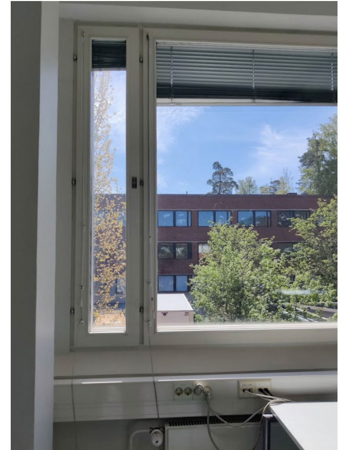
Ulkoseinien alareunoja pitkin kulkevat johtokourut. Kuvassa myös kolmannen kerroksen piirustussalin tuuletusikkuna.
