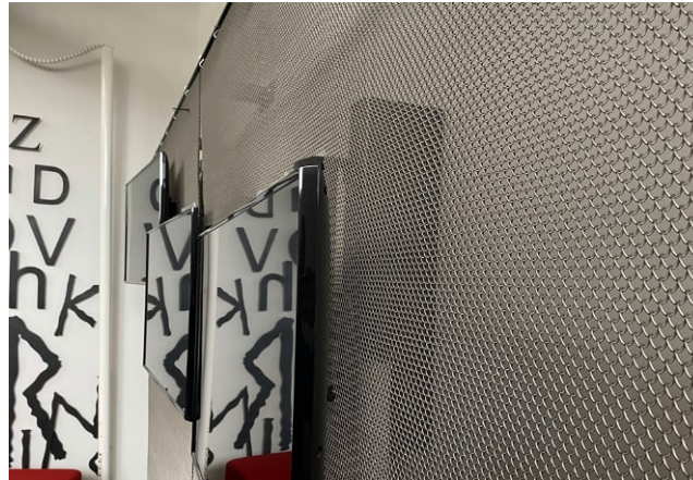
Aulan pitkälle seinälle on vuosien 2004–2006 peruskorjauksessa ripustettu teräskannattimien varaan teräsverkkoa. Verkko häivyttää takana olevia lämpöpattereita ja johtokoteloita.
