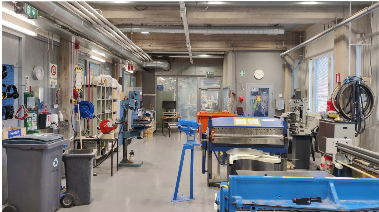
Yleisnäkymä metallipajaan. Talotekniikka on selkeästi näkyvillä koko toisessa kerroksessa.
