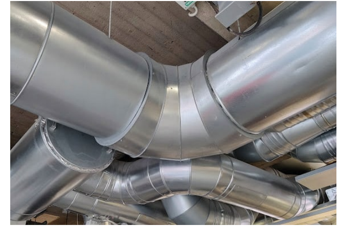
Ilmanvaihtokanavat on ripustettu rakennuksen betonisiin välipohjiin ja jätetty näkyviin. Kuva on toisen kerroksen pajan kokoonpanotilasta.
