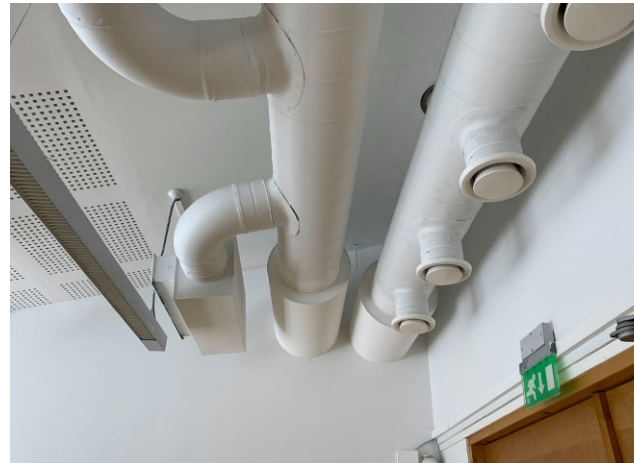
IV-laitteistot kerroksen neuvottelutilassa.
