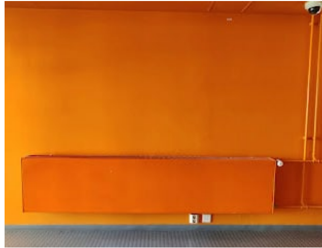
A-portaan ensimmäisen kerroksen lämpöpatterit.
