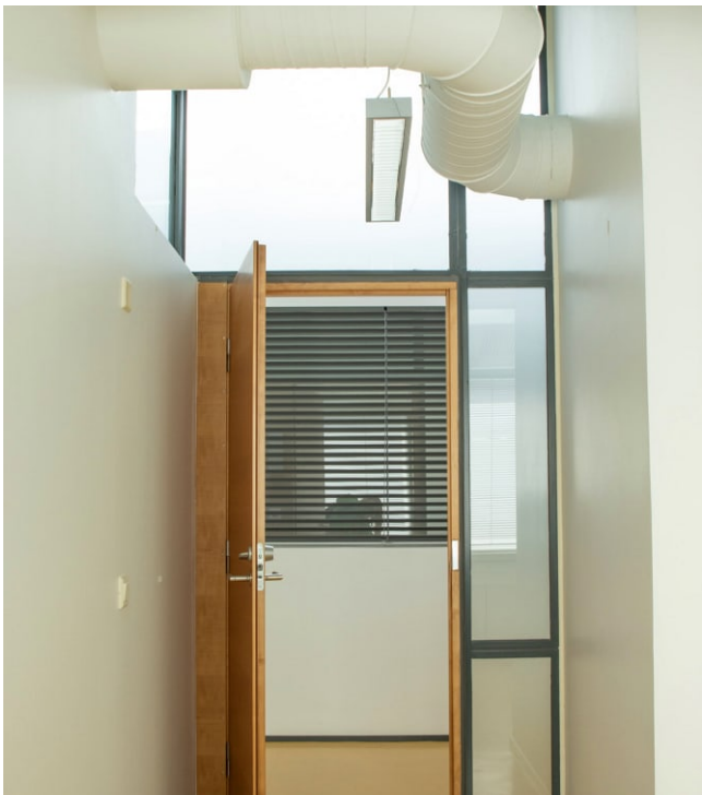
Vastaanottohuone käytävään suuntaan, ilmanvaihtoputki kulkee huoneiden läpi.
