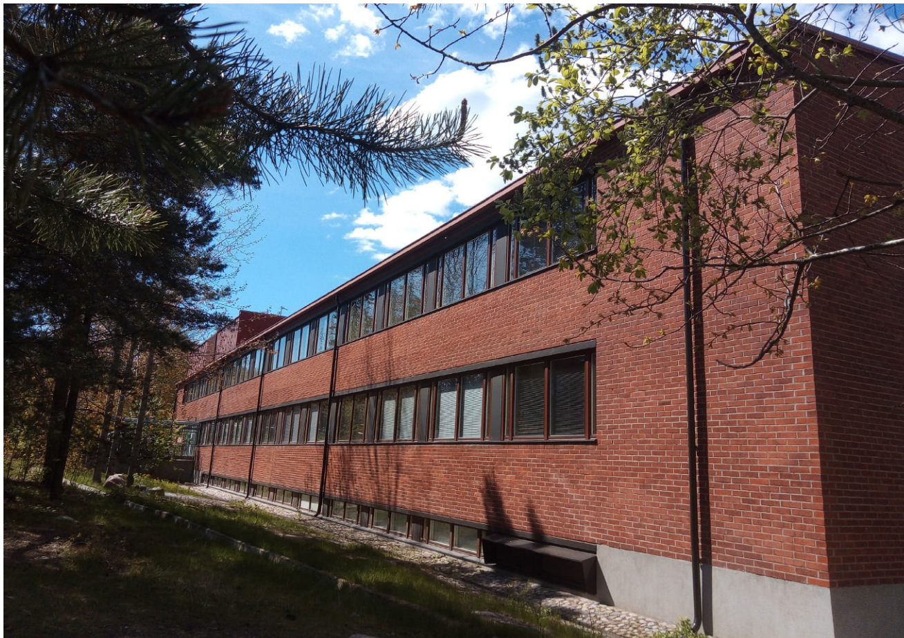
Kaakkoisjulkisivu koillispäädystä kuvattuna. Toisessa päädystä on huoltopiha, jonka tukimuurit, aidat ja teräsrakenteet ovat vuodelta 2005. Alhaalla näkyy ilmanvaihtosäleikkö vuodelta 2018.
