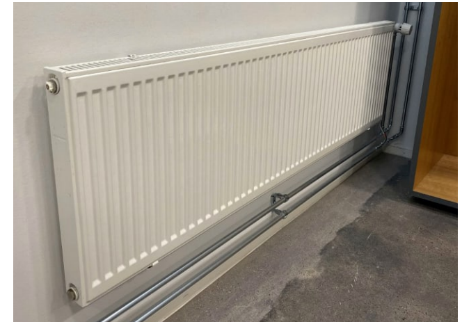
Vesikiertoiset lämpöpatterit ovat vuodelta 2004.
