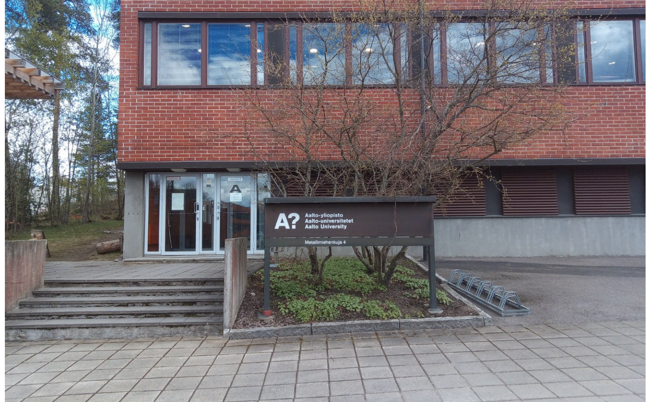
Luoteisjulkisivun pääsisäänkäynnin ovet, terassin pintarakenteet, kyltti ja istutukset ovat vuodelta 2005. Kuvassa oikealla on ikkunoita peittävät puusäleiköt, joista kaksi ovia lähinnä olevaa on lisätty vuonna 2005.
