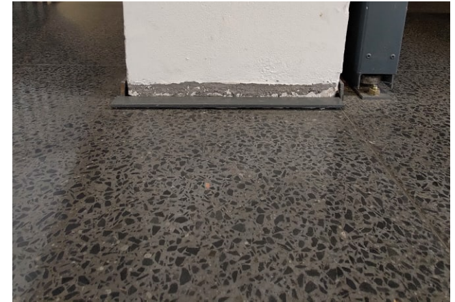
Aulan ja naulakkotilan lattia on tummanharmaaksi sävytettyä mosaiikkibetonia. Puretun seinän kohdalla ei erotu rajaa, joten lattia on mahdollisesti uusittu vuosien 2004–2006 peruskorjauksessa. Jalkalistat ovat tummanharmaaksi maalattua puuta.
