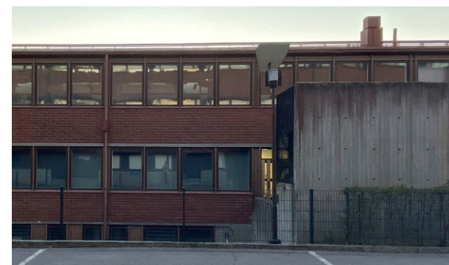
Lauhdutin julkisivun edustalla.
