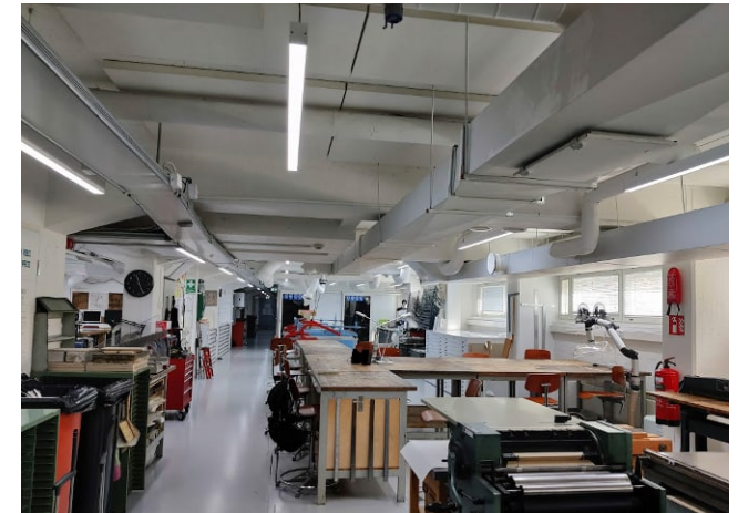
Ensimmäisen kerroksen grafiikan painosalin kattoon ripustettu iv-laitteisto on maalattu samaan sävyyn katon ja seinien kanssa.
