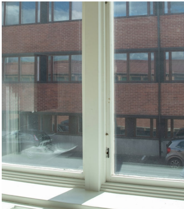
Ikkunapöytä, joka on vaihettu alkuperäisestä.
