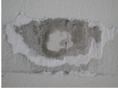
3024 Kolhiintunut seinäpinta huoneessa 226.
