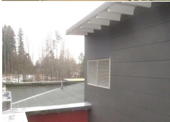
Kuva 15. Koneiden TK1 ja TK2 ulkoilmasäleiköt ovat vesikatolla IV-konehuoneen ulkoseinässä.
