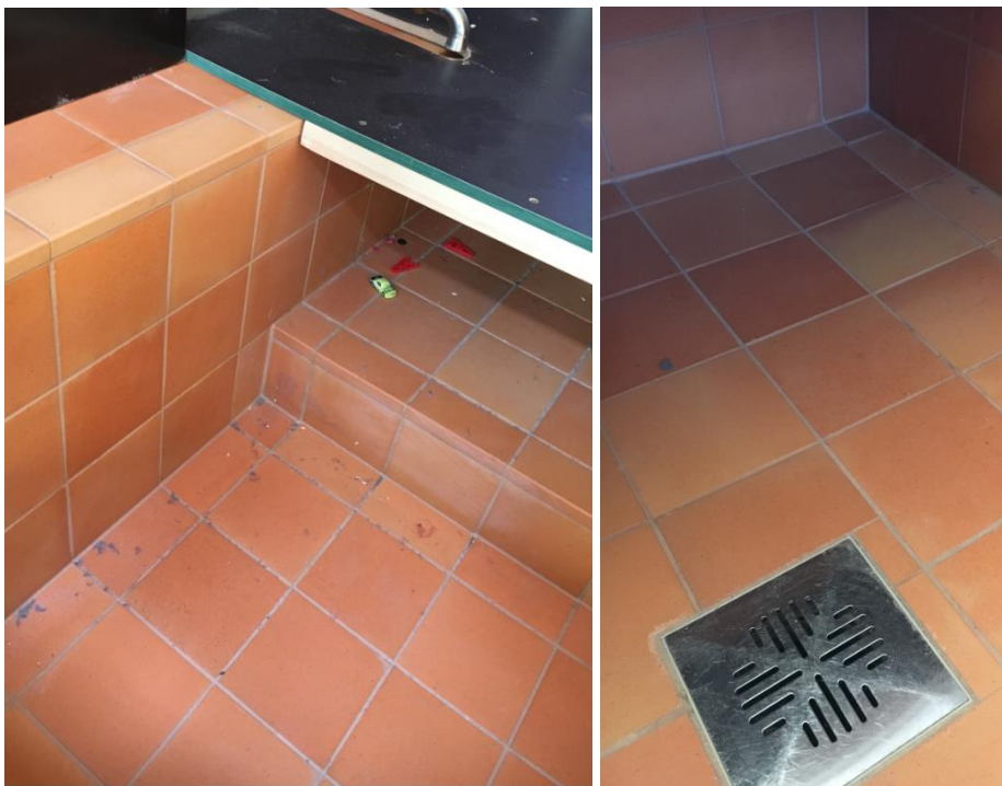
Kuvat 3, 4. Tilassa H038 on käytöstä poistettu allas, jonka pinnoilla ei havaittu kosteutta. Allas on peitetty vesivanerilla, mutta altaan pohjalle oli kerääntynyt pölyä ja muuta roskaa.
