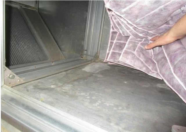
Kuva 20. Koneen TK2 punainen tuloilmasuodatin, jonka kohdalla kotelun pohjalla on vanhoja kuivuneita kosteusjälkiä. Tuloilmasuodattimelle tullut kosteus on ollut peräisin ulkoilmasta.
