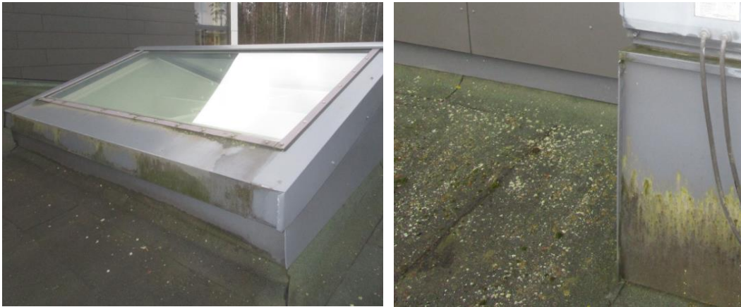
Kuvat 5, 6. Katto on monimuotoinen. Paikoin pellityksissä ja kermin pinnassa havaittiin leväkasvustoa.
