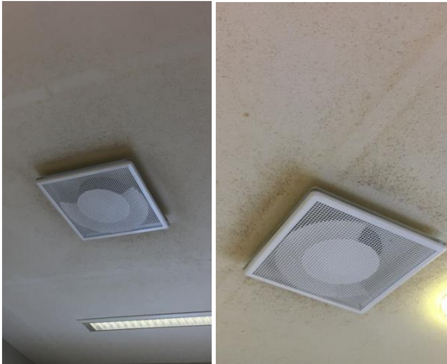
Kuvat 7, 8. Kattopinnoilla oli havaittavissa useissa tiloissa tummumaa, joka oli voimakkainta tuloilmapäätteiden ympärillä. Todennäköisesti tämä on huonepölyä, joka on kiinnittynyt huokoiseen kattopintaan. Kuvat tiloista H017 (vas) ja H026 (oik).
