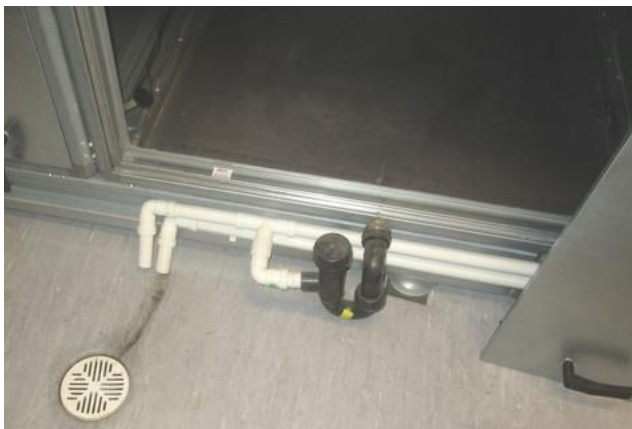
Kuva 18. Koneen TK1 viemäröinnit(vedenpoistoputket) on johdettu IV-konehuoneen lattiakaivoon.
