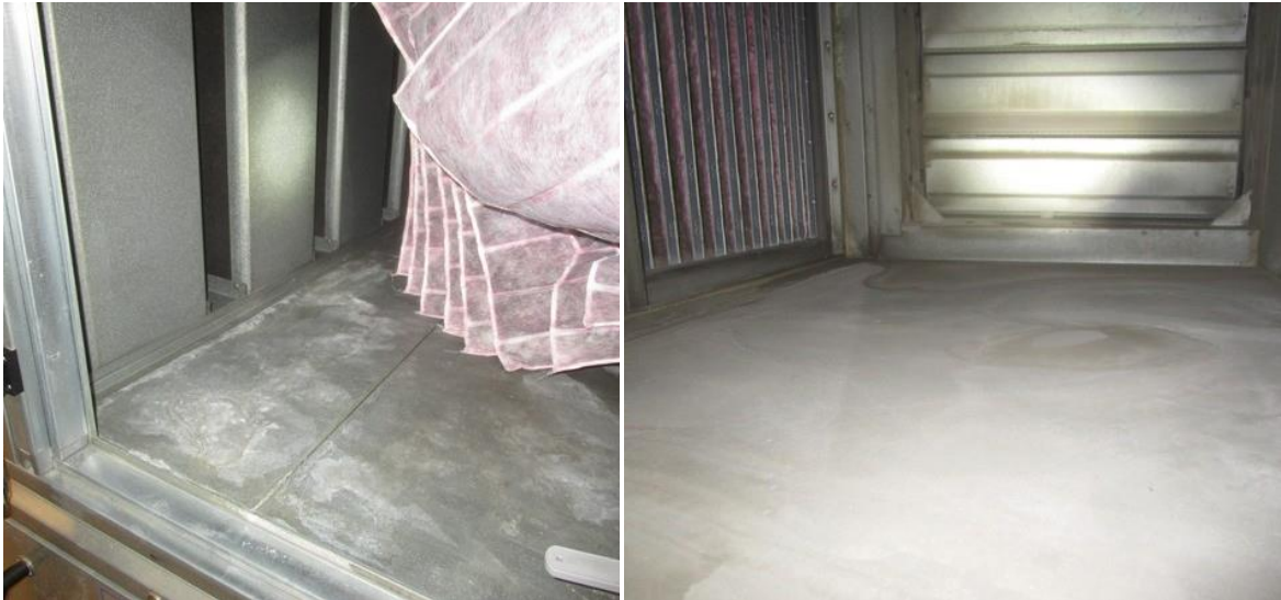
Kuvat 16, 17. Vasemmalla koneen TK1 punainen tuloilmasuodatin, jonka kohdalla kotelon pohjalla on vanhoja kuivuneita kosteusjälkiä. Tuloilmasuodattimelle tullut kosteus on ollut peräisin ulkoilmasta. Oikealla koneen TK1 ulkokammio, johon koneen TK2 tuloilma johdetaan.
