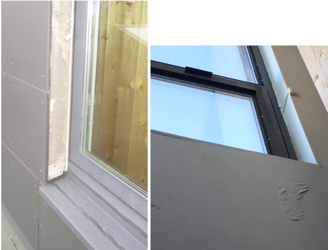
Kuvat 9, 10. Monitoimitilan H040 yläikkunan alapuolella oli ulkoseinässä kosteuden aiheuttamia jälkiä. Ikkunakarmin alaosassa havaittiin väljyyttä ikkunan ollessa suljettuna. Yläikkunan reunassa olevaa vanerilevyä ei todennäköisesti ole uusittu julkisivuremontin yhteydessä ja siinä on vaurioita.
