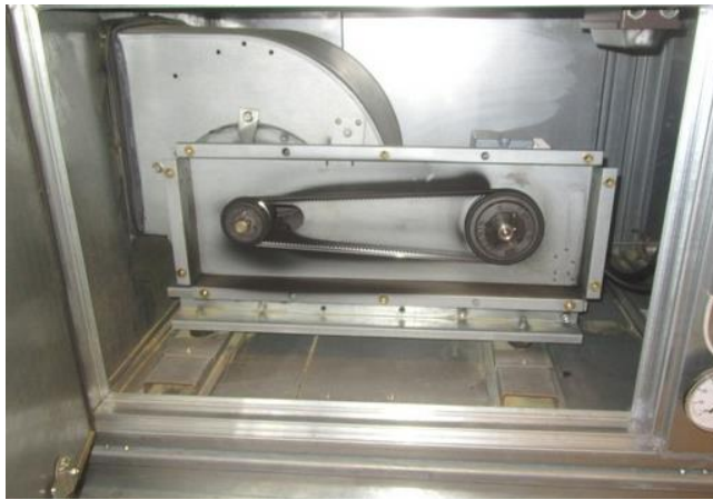
Kuva 21. Koneen TK2 tuloilmapuhallin. Puhaltimen jälkeinen tuloilmakanava on liitetty koneeseen TK1.
