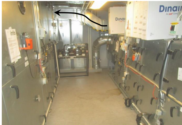
Kuva 14. Vasemmalla kone TK1 ja oikealla kone TK2. Koneen TK2 tuloilma johdetaan koneeseen TK1 nuolella osoitetun kanavan kautta.
