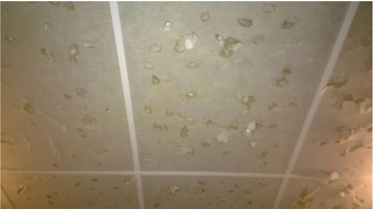
Kuva 4.12. VSS-tilassa olevan Kuntosalin katon akustiikkalevyt rikottu.
