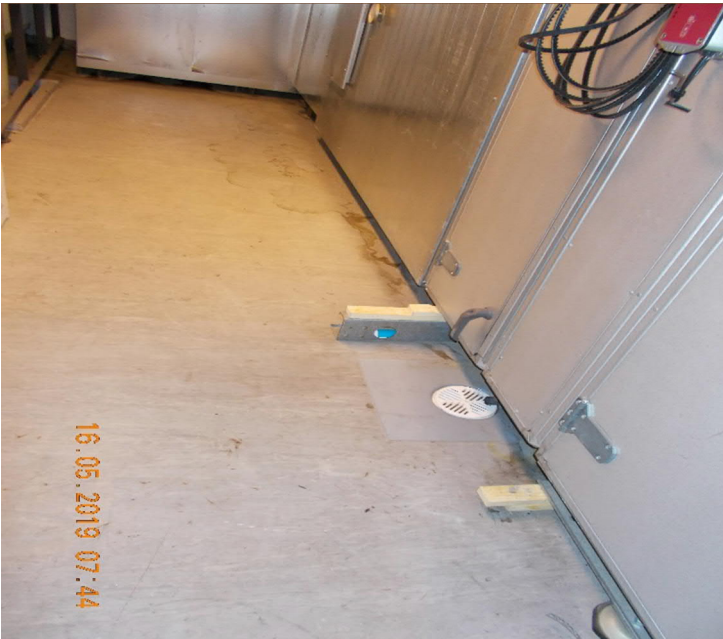
Kuva 6.3. Ilmanvaihtokoneiden sisälle päässyt lumi on sulanut lattialle.
