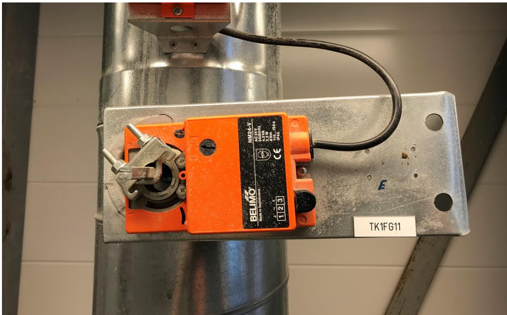
Kuva 7.1 Kiinni jumiutunut IMS-peltimoottori, korjattiin testin ohessa.
