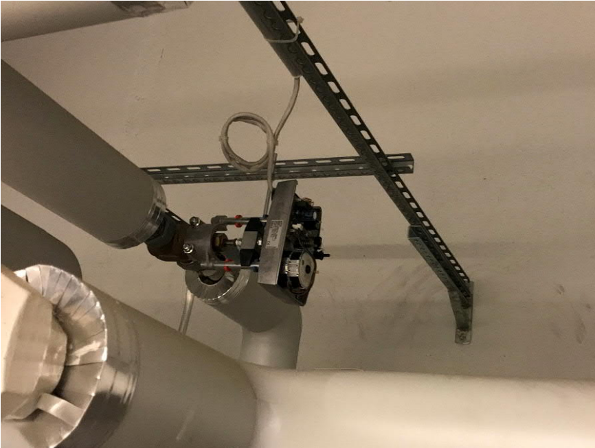
Kuva 7.3 Edestakaisin ajava venttiilimoottori, korjattu ajamalla rajat uudestaan. Vian aiheuttaa kuluneet rattaat, korjaus toimenpiteeksi suositellaan venttiilimoottorin vaihtoa.
