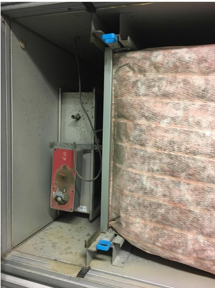
Kuva 6.8. TK5 suodatin on väärän kokoinen.
