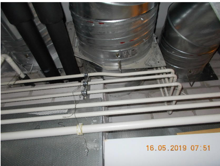
Kuva 6.2. Kuilun yläpää on jäänyt muuraamatta kiinni.
