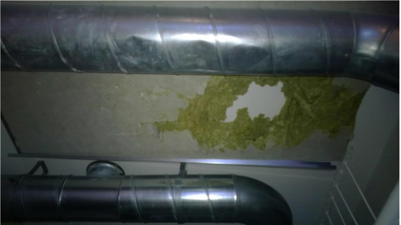
Kuva 4.11. VSS-käytävän katossa rikottuja akustiikkalevyjä.
