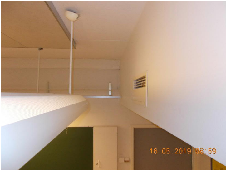
Kuva 6.7. Valaisin ohjaa tuloilmasuihkun lattiaan mm. luokassa 2044.
