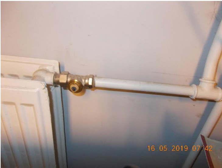
Kuva 6.5. Patteritermostaattien säätöosia puuttuu.
