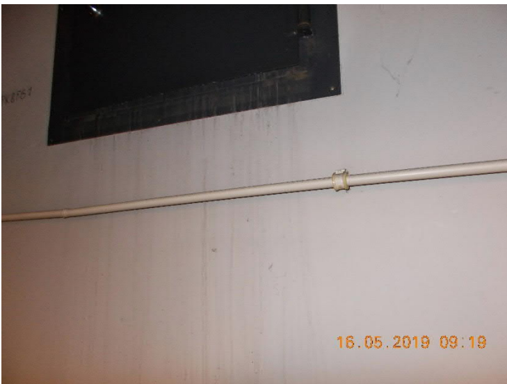
Kuva 6.6 Seinäluukku on vuotanut sadevesiä.
