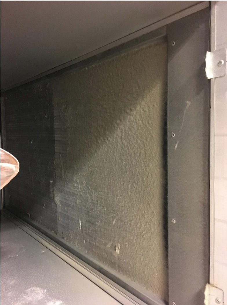
Kuva 6.9. Lämmityspatteri on päässyt likaantumaan.
