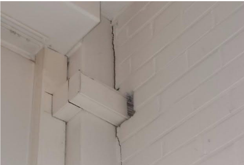
Kuva 4.2. Halkeama rakenneliitoksessa ja tiivistämätön läpivienti.
