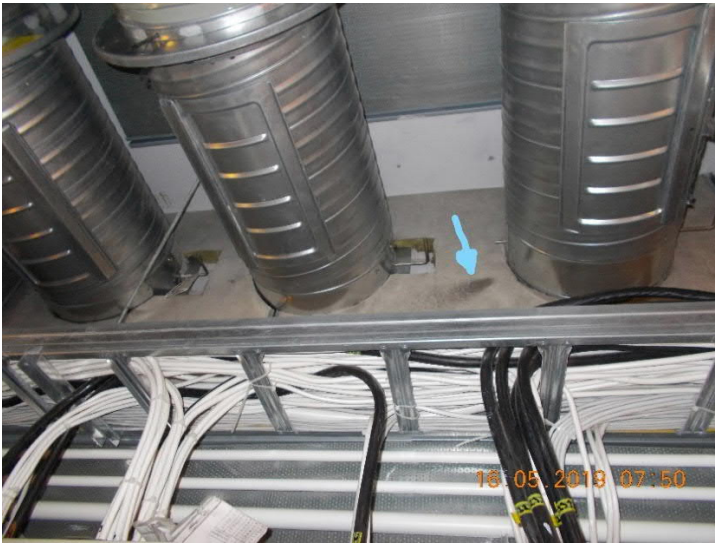
Kuva 6.1. Kanavissa ja koneissa on useita vuotoja.
