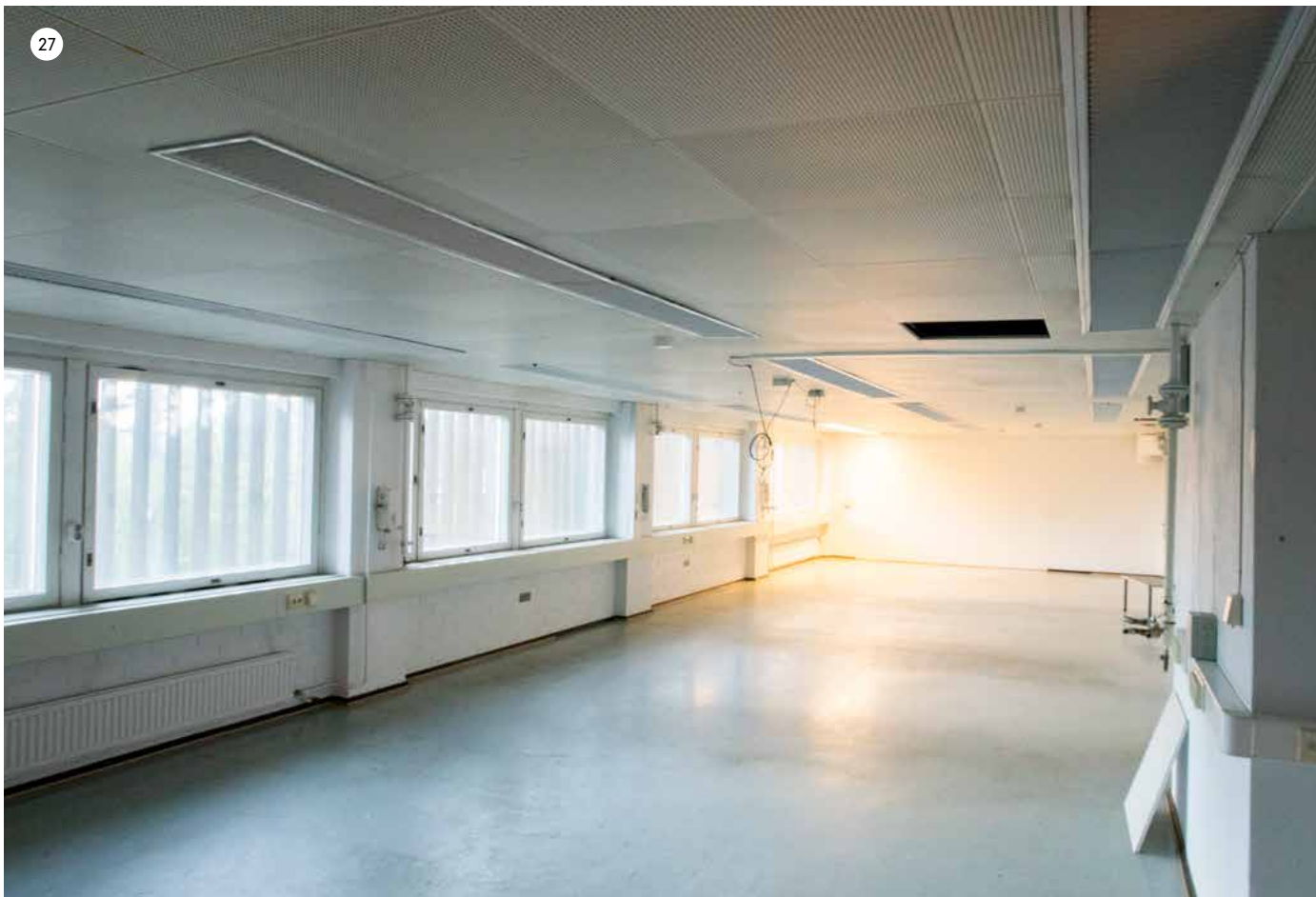
Mittaushuone 2. kerroksessa on säilyttänyt alkuperäisen tilahahmonsensa. Huoneessa on muusta rakennuksesta poikkeavat matalammat ikkunat ja niiden edessä puuritilät.
